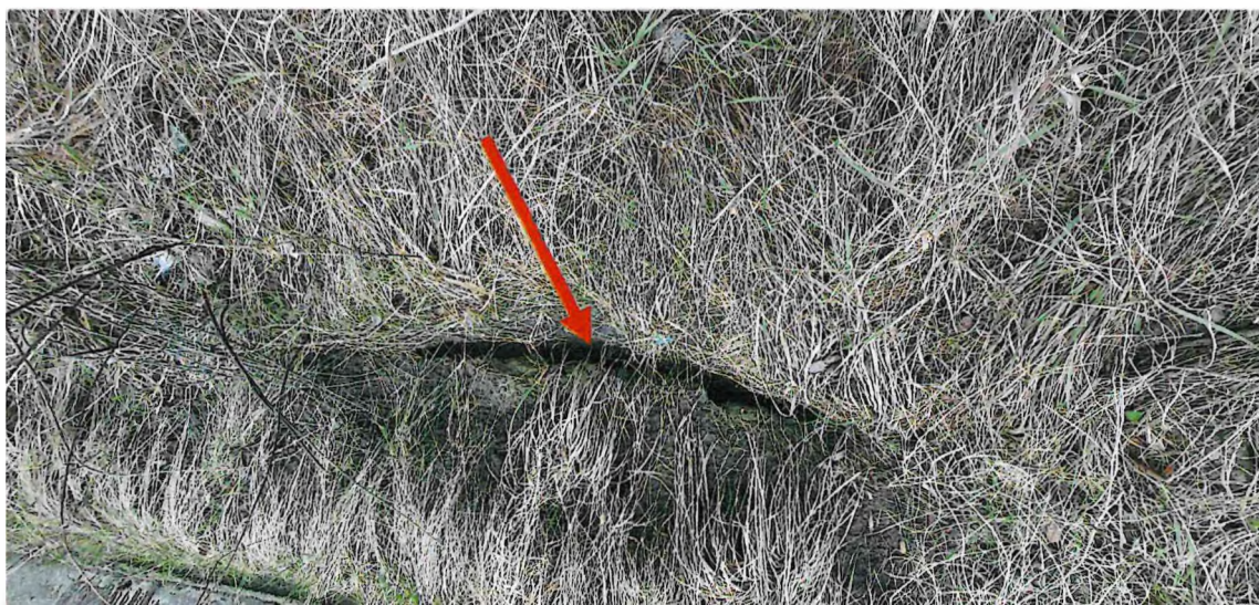
Fot. 6.1. Odspojenie gruntu od fundamentu muru oporowego. Efekt osuwiskowy.
