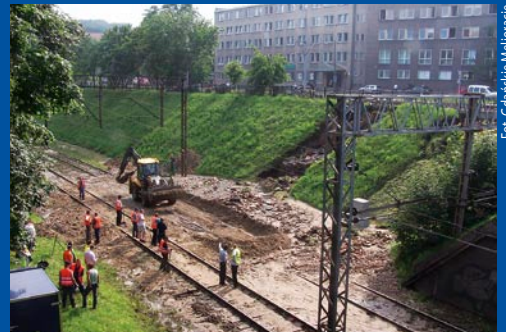
Usuwanie skutków powodzi z torów PKP w ciągu ulicy 3 Maja na wysokości Urzędu Miejskiego. Została uszkodzona skarpa, w której Miasto buduje „syfon” pod torami kolejowymi. Ruch pociągów po jednym torze przywrócono już o godz. 16.12, a po drugim torze o godz. 17.43.
