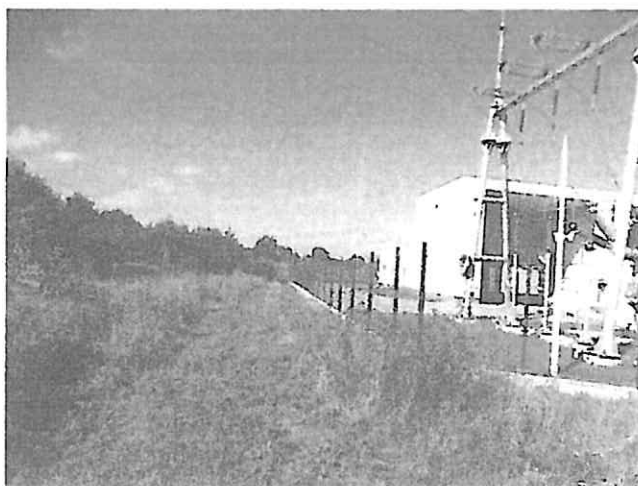
Stacja GPZ Maćkowy teren pod linią Kowale
