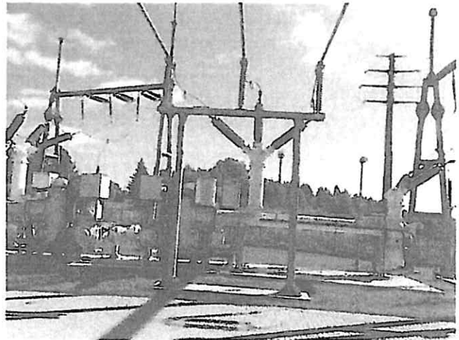
Pole transformatora Tr1
