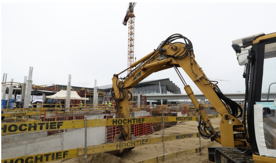
ryc. 2. Budowa biurowca Alpha w Porcie Lotniczym im. Lecha Wałęsy. Fot. G. Mehring / gdansk.pl
