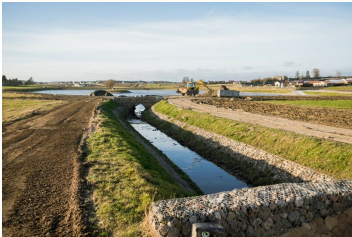
Rycina 4. Prace budowlane w okolicy zbiornika retencyjnego „Strzelniczka II” w dzielnicy Kokoszki. Fotograf: D. Paszliński / gdansk.pl
