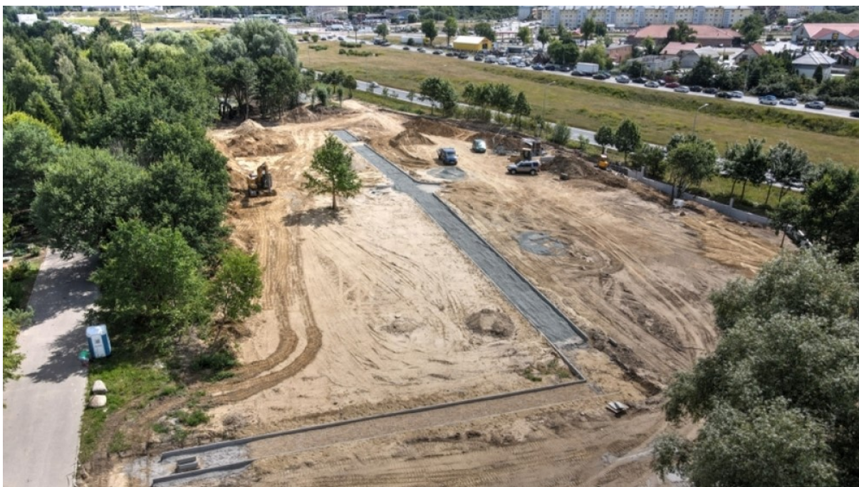
Rycina 8. Prace ziemne na terenie Cmentarza Łostowickiego w celu rozbudowy nekropolii. Fotografia: Dyrekcja Rozbudowy Miasta Gdańska
