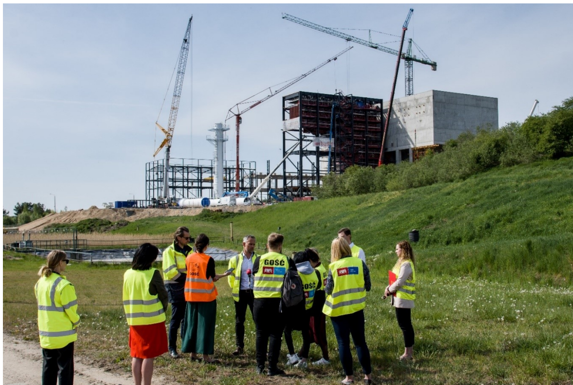
Rycina 1. Wizyta na terenie budowy Portu Czystej Energii – zakładu termicznego przekształcania odpadów. Fotograf: Artur Makowski / www.gdansk.pl
