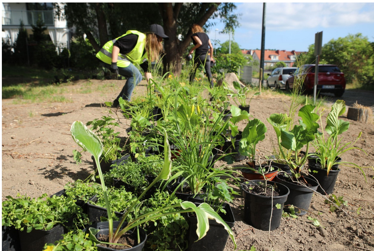
Rycina 6. Prace nad ogrodem deszczowym przy ulicy Sołeckiej. Fotografia: Gdańskie Wody www.gdmel.pl
