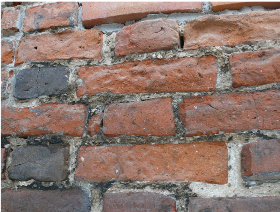
W trakcie konserwacji - stan zachowania oryginalnego wążku po oczyszczeniu i usunięciu wtórnych spoin.
