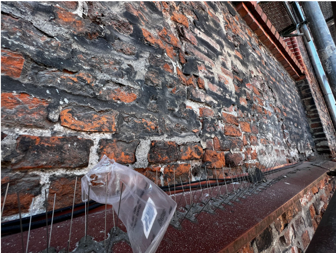
Przed konserwacją - obróbka blacharska występu muru bez uszczelnienia styku.
