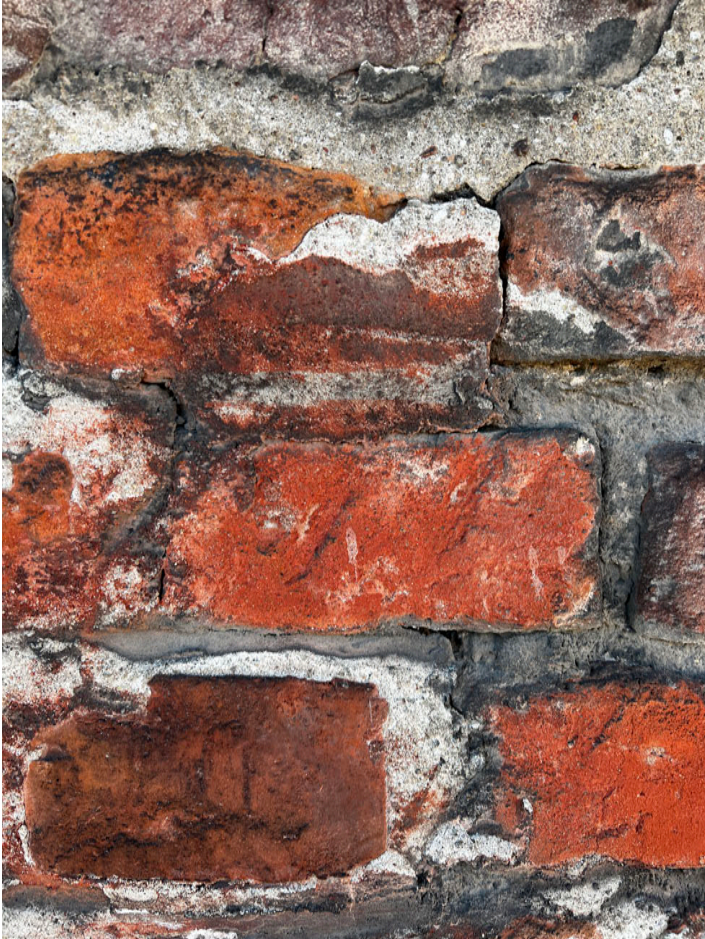
Przed konserwacją - przeszła zachodnie elewacji: naprawy wążku wykonane zaprawą wapienną i czerwona monochromia.
