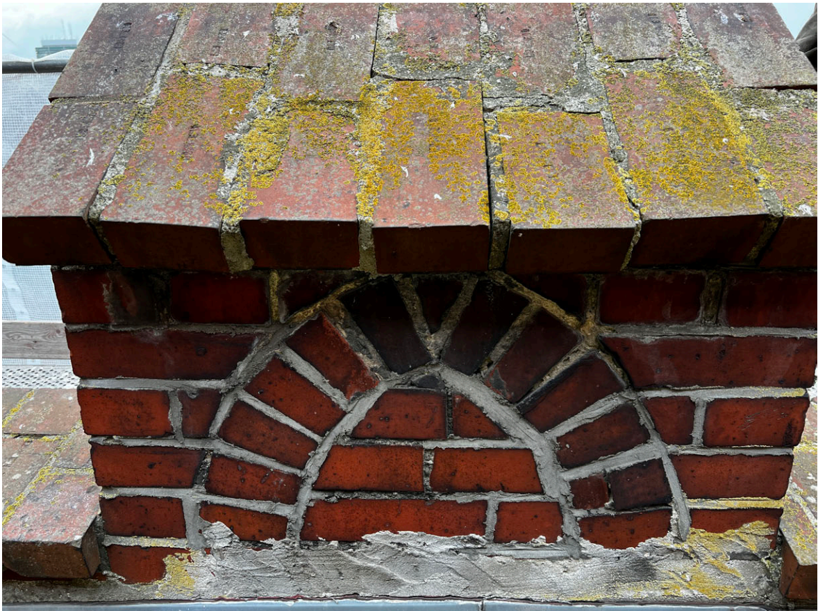
Przed konserwacją - odspojenia cegieł nakryw krenelażu.
