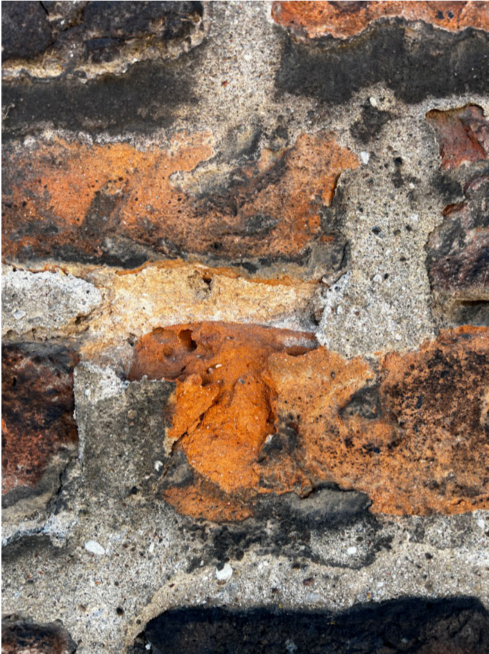
Przed konserwacją - dezintegracja globularna cegieł, wtórne spoinowania.
