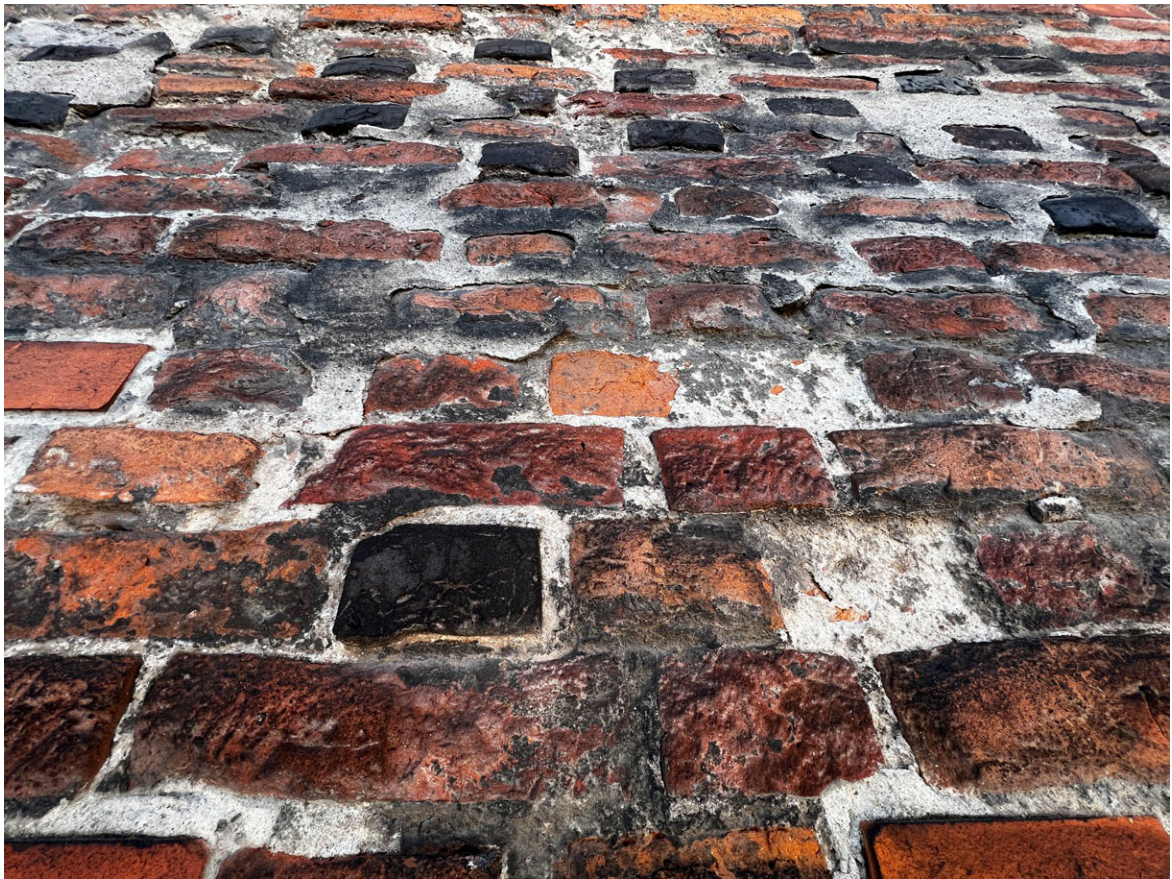
Przed konserwacją - stan zachowania lica elewacji.
