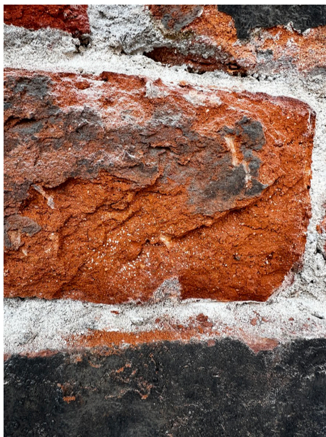
W trakcie prac - zasolenie cegieł widoczne po usunięciu wtórnych spoin.
