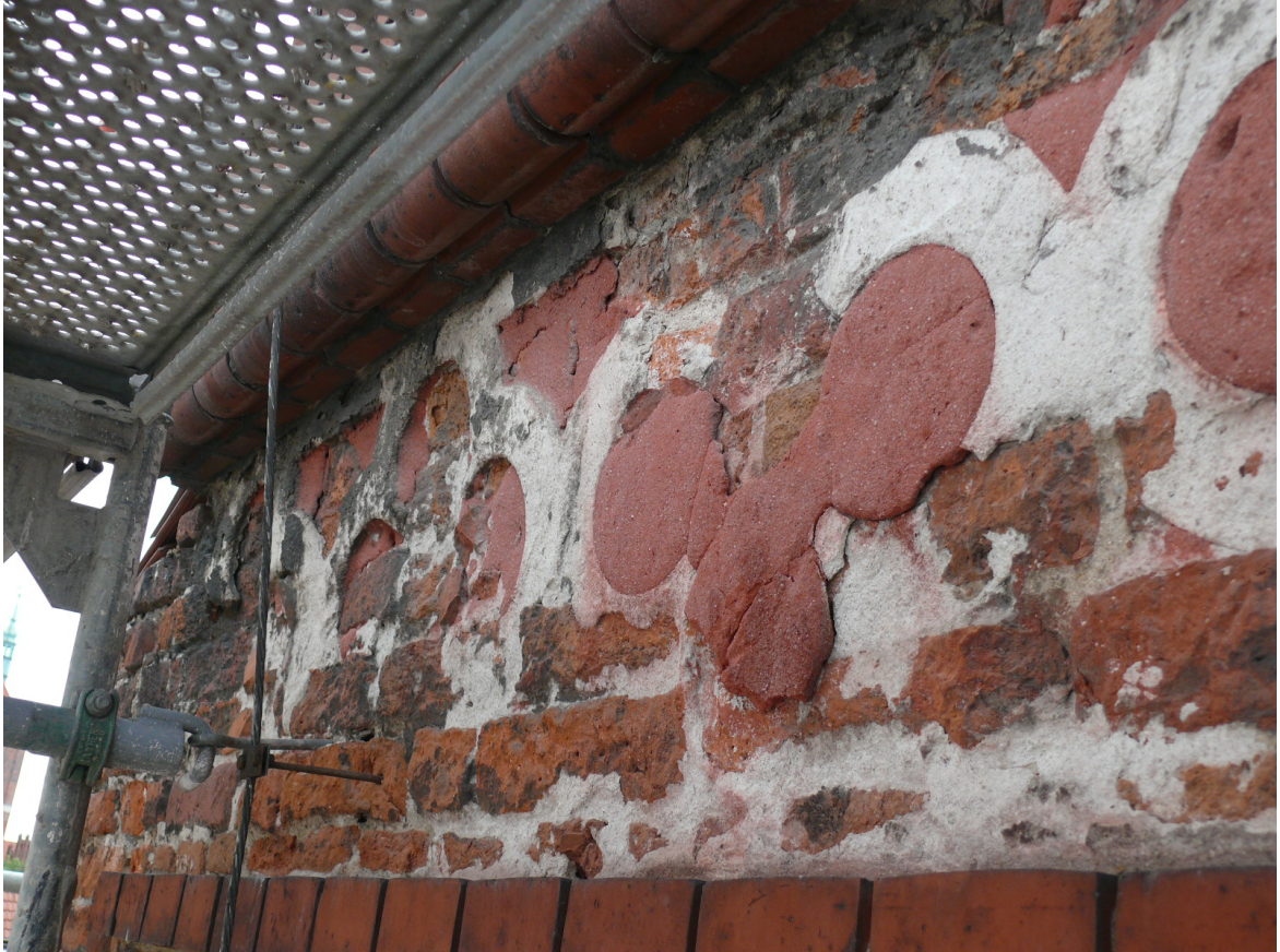
Przed konserwacją - stan zachowania fryzu: odspojenia tynków i rozległe ubytki.
