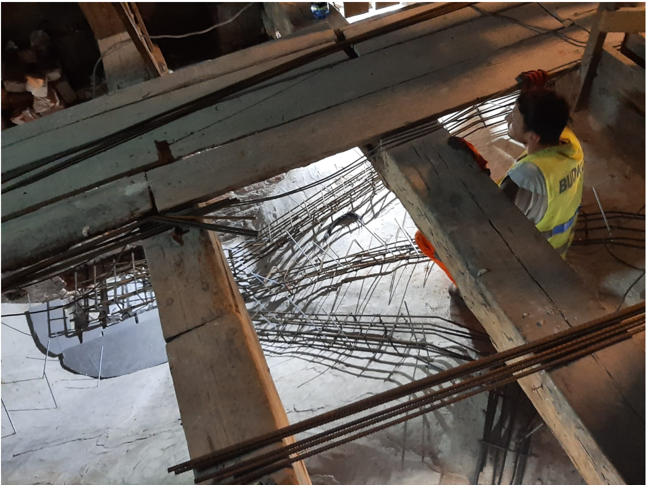
Wzmacnianie żeber - kotwy wklejone w ceramiczne żebra wiązane ze zbrojeniem gurtów wzmacniających żebra.
