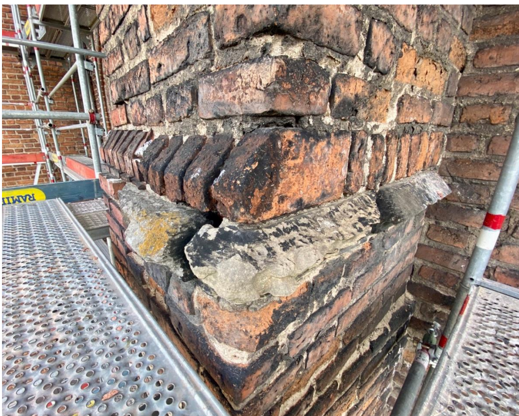
Ilustracja 14. Zniszczenia cegieł, zapraw oraz materiału kamiennego.
