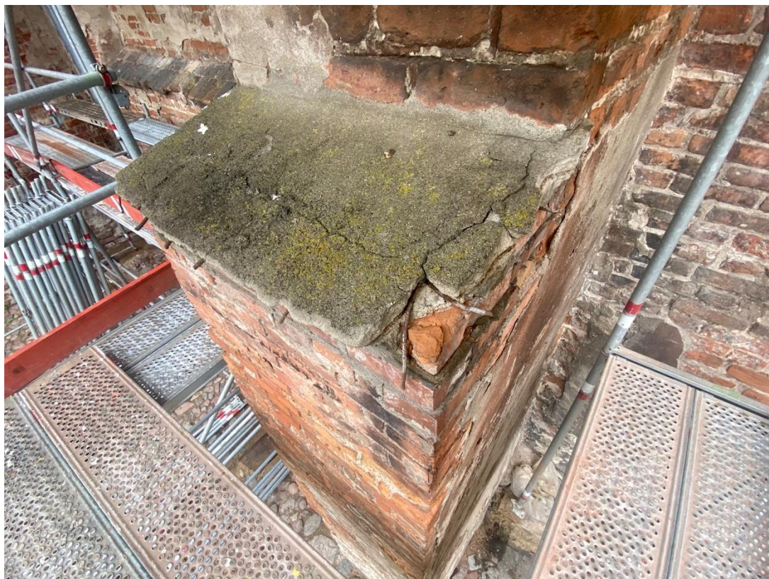
Ilustracja 23. Uszkodzenia zapraw cementowych na zadaszaniu przypory.
