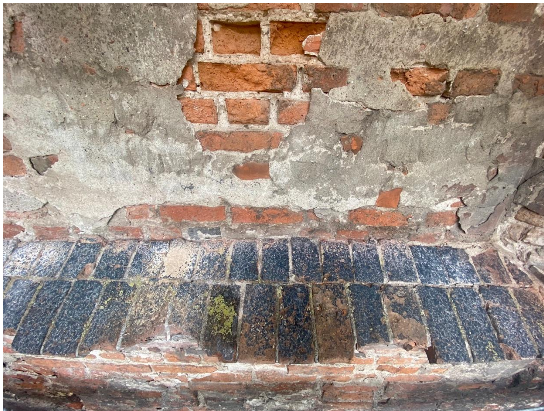
Ilustracja 11. Poważne zniszczenia cegieł, zapraw oraz reliktyw tynków.
