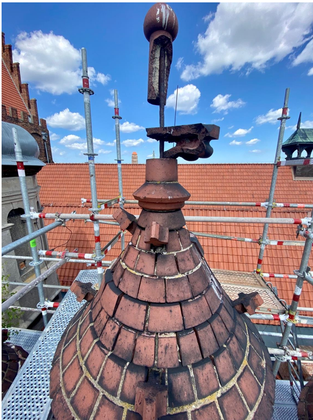
Ilustracja 16. Uszkodzone sterczyny wieńczące pseudotransept, przeznaczone do naprawy ze środków MKiDN.
