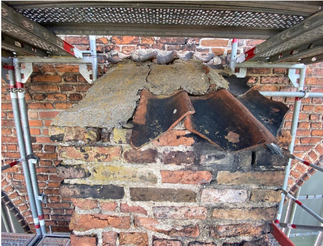
Ilustracja 12. Zniszczenia dachówek w obrębie przypory, stanowiące duże zagrożenie dla zdrowia i życia ludzi.
