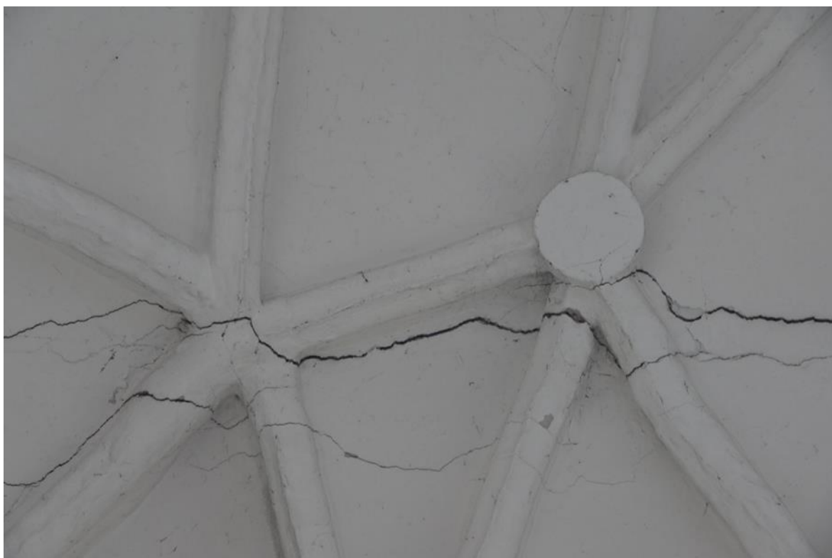
Ilustracja 15. Silnie spękanе sklepienie
