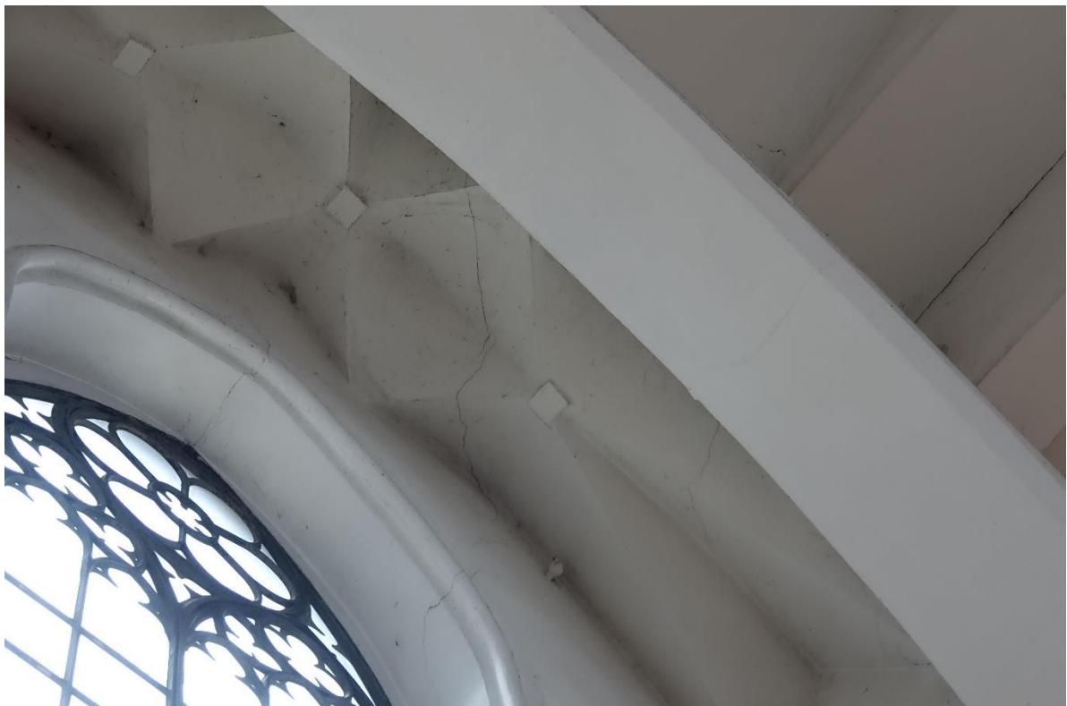
Ilustracja 9. Kościół pw. św. Bartłomieja. Spękania ściany i sklepienia
