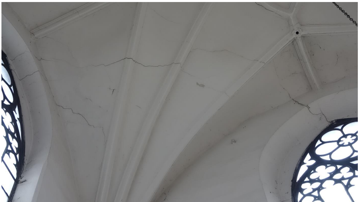
Ilustracja 13. Silnie spękane sklepienie
