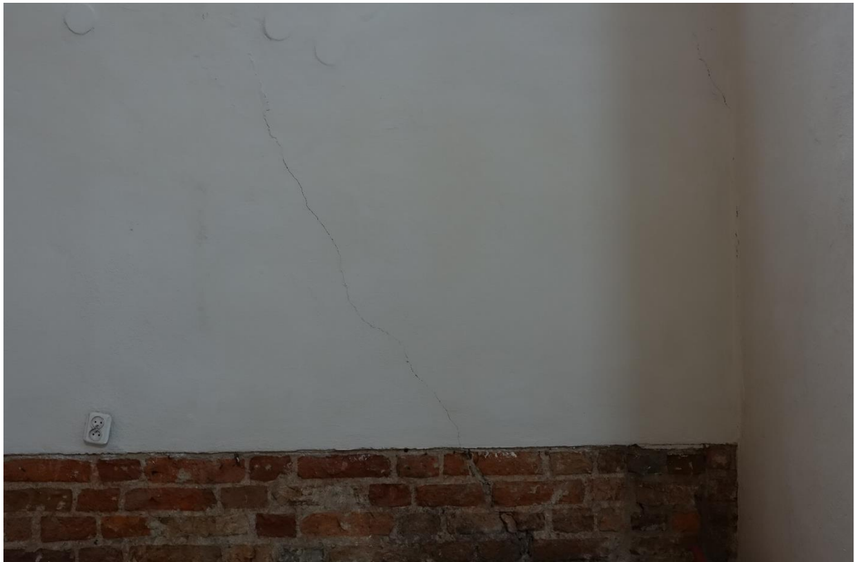
Ilustracja 12. Rysa na ścianie
