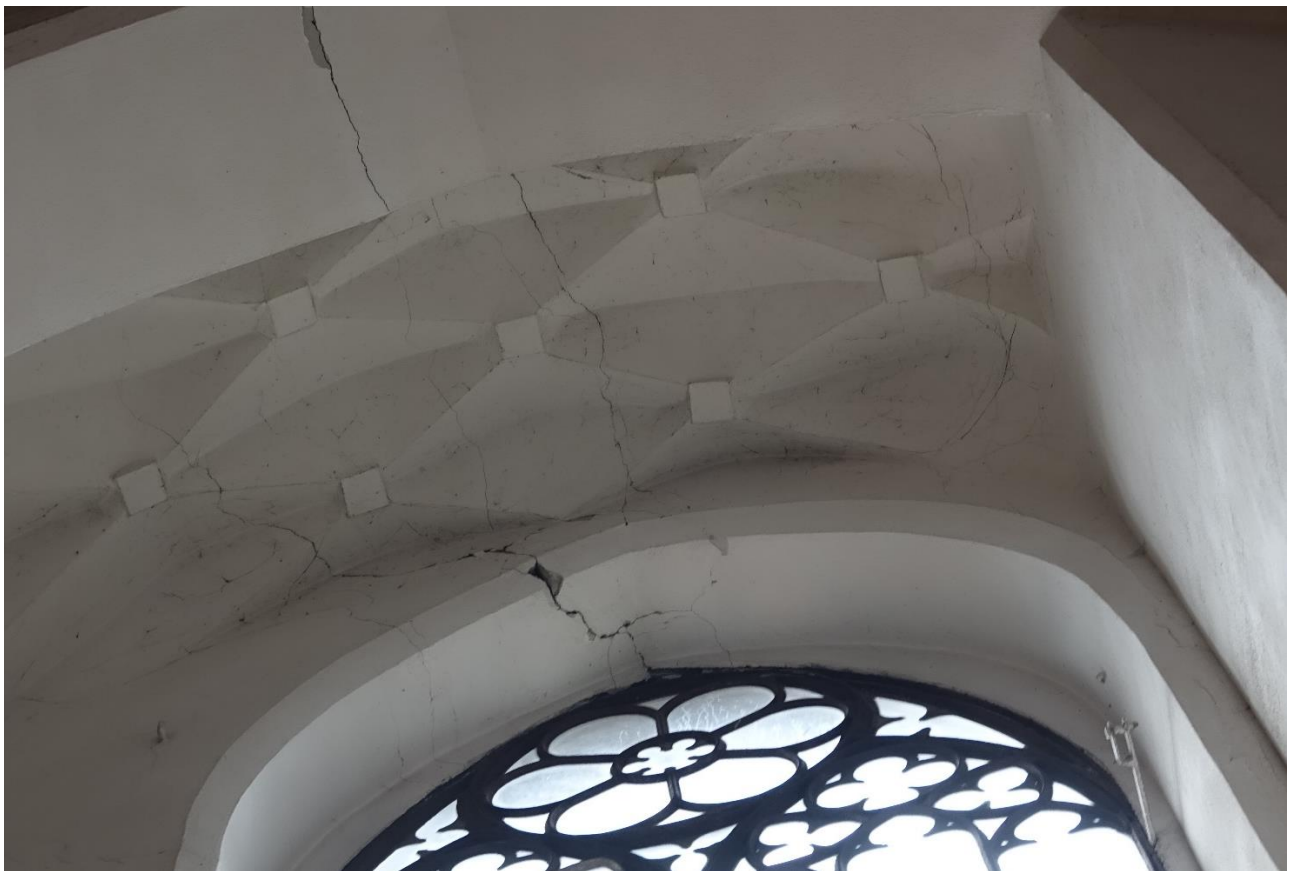
Ilustracja 11. Silnie spękane sklepienie
