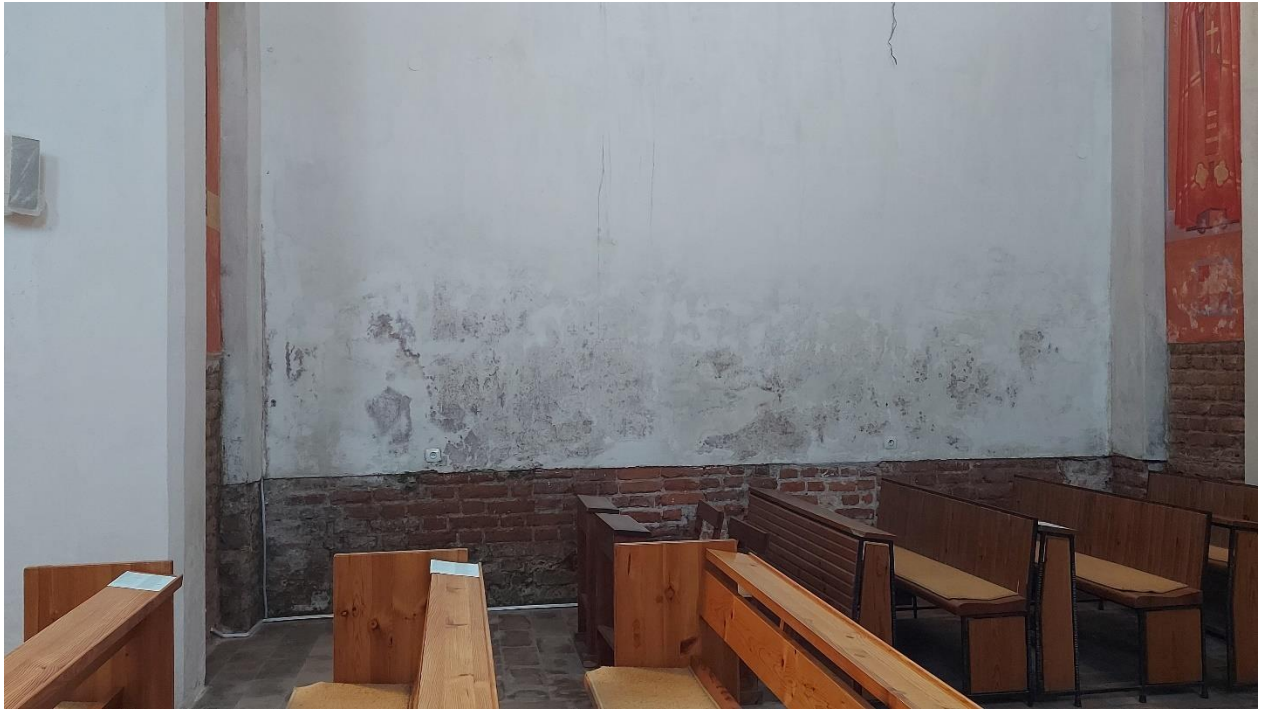
Ilustracja 11. Tynk odpadający w wyniku zawilgocenia.
