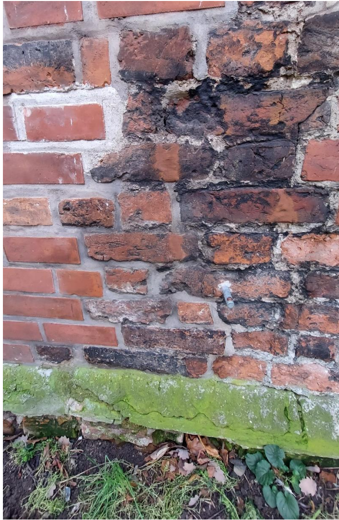
Ilustracja 13. Efekt zawilgocenia muru we wschodniej części kościoła.
