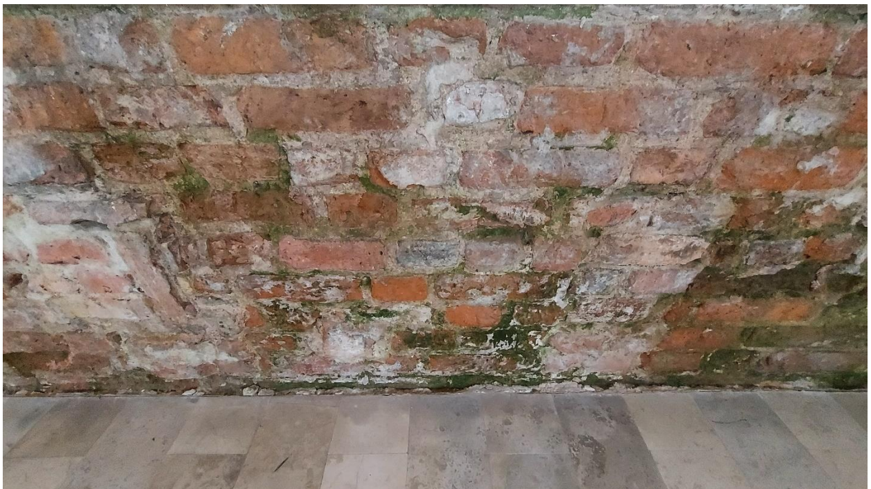
Ilustracja 12. Mur porośnięty mchem w wyniku zawilgocenia.
