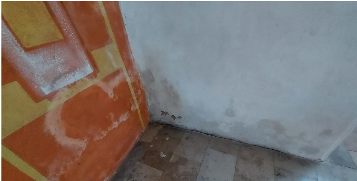
Ilustracja 9. Efekt zawilgocenia: zacieki na ścianach i posadzce, uszkodzenia malowidła.
