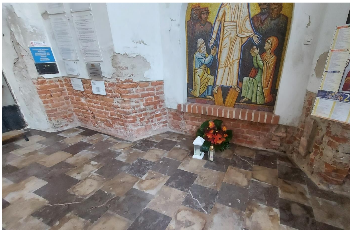
Ilustracja 8. Wnętrze kościoła pw. św. Bartłomieja. Zawilgocenie posadzki i odpadający tynk.
