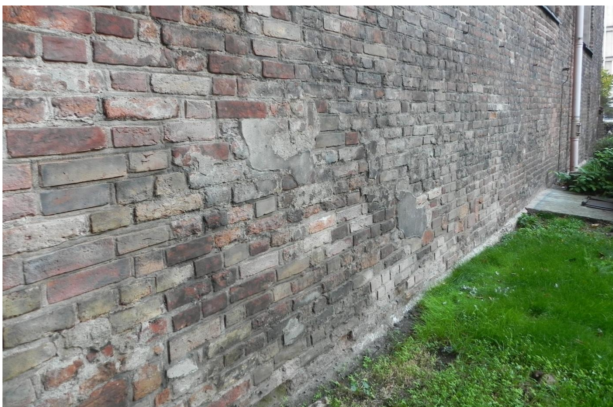
Ilustracja 42. Obiekt po zakończeniu prac konserwatorskich. Wschodnia część południowej ściany kościoła (widok od południowego zachodu)
