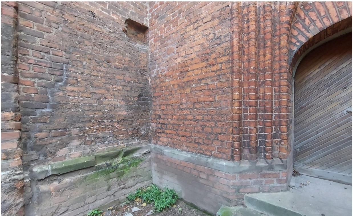
Ilustracja 16. Zawilgocenie muru ceglanego. Mur porośnięty mchem.
