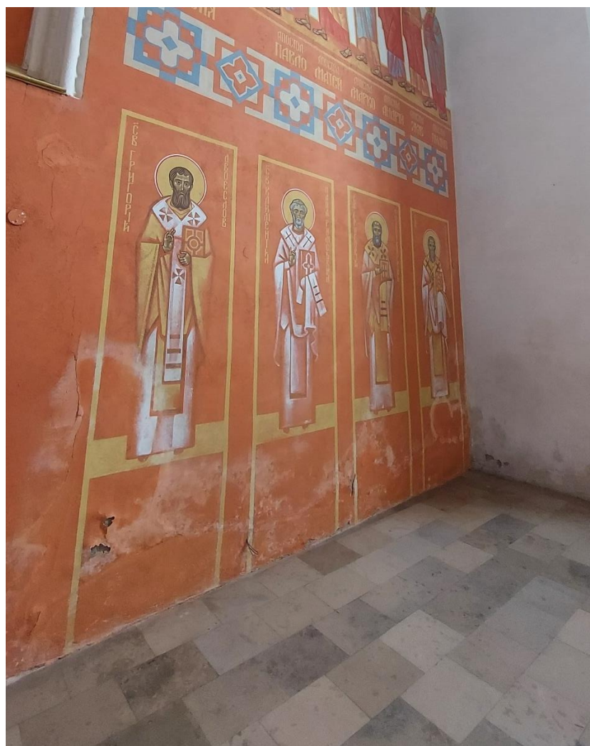
Ilustracja 10. Uszkodzenia malowidła w wyniku odpadania zawilgoconego tynku.
