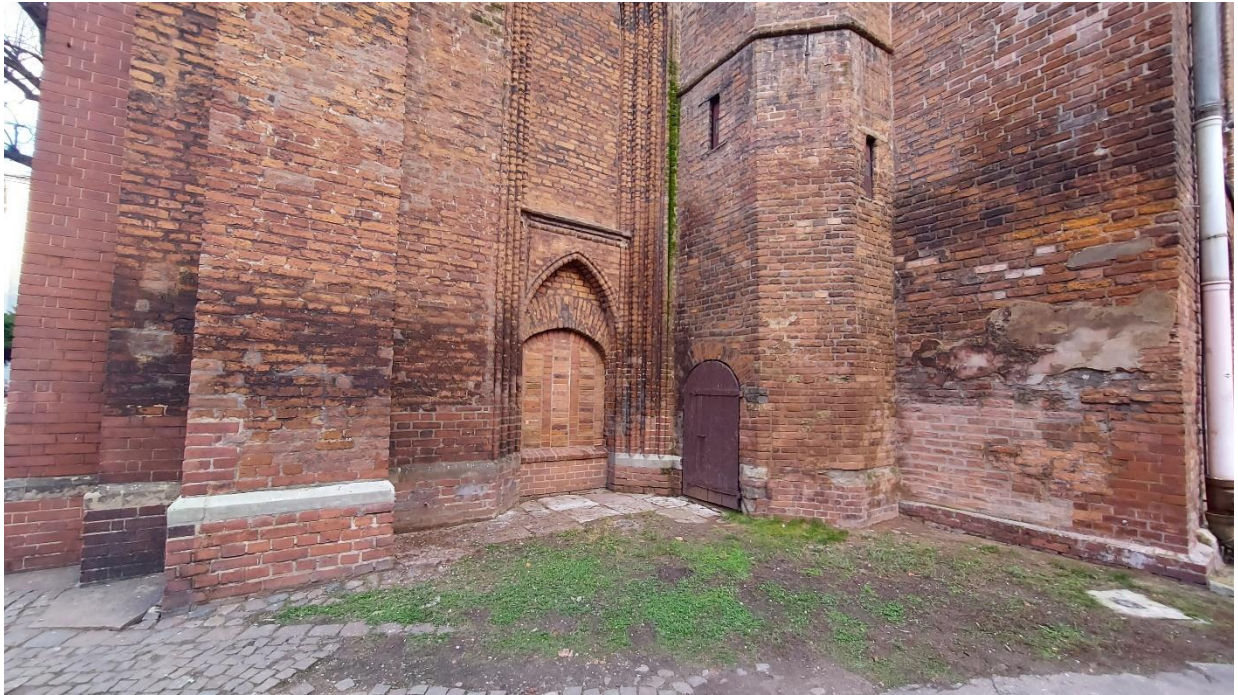
Ilustracja 15. Efekt zawilgocenia muru w południowej części kościoła.
