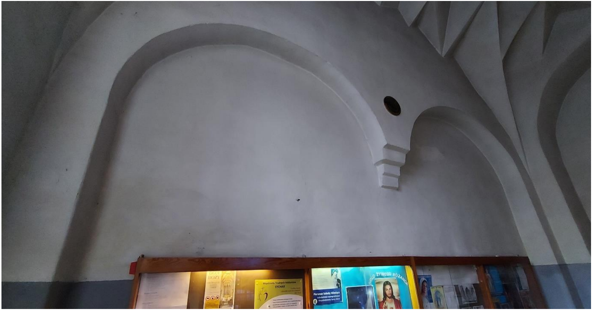
Ilustracja 15. Zacieki spowodowane zawilgoceniem kościoła
