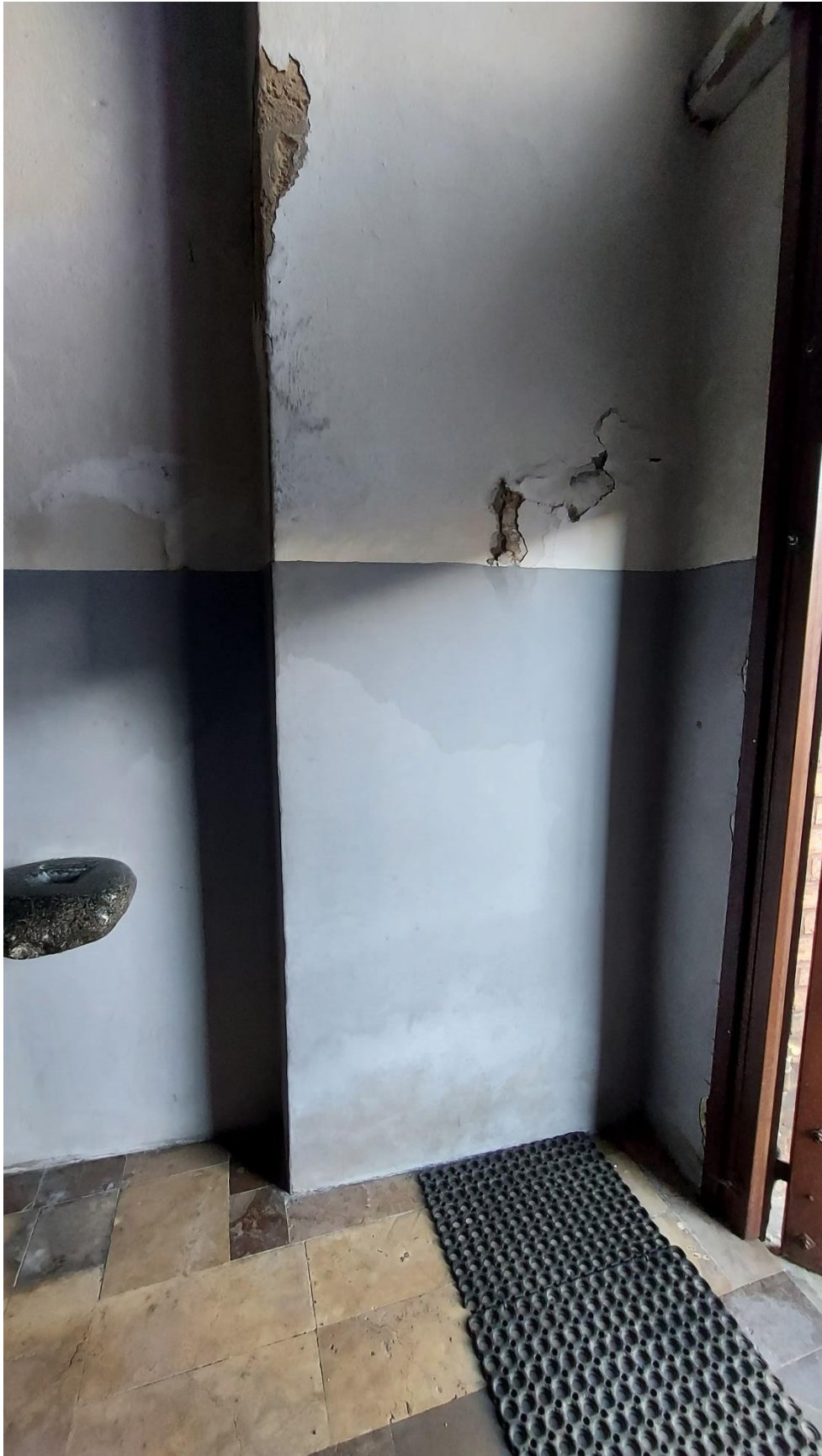
Ilustracja 11. Tynk odspajający się od ścian w wyniku zawilgocenia
