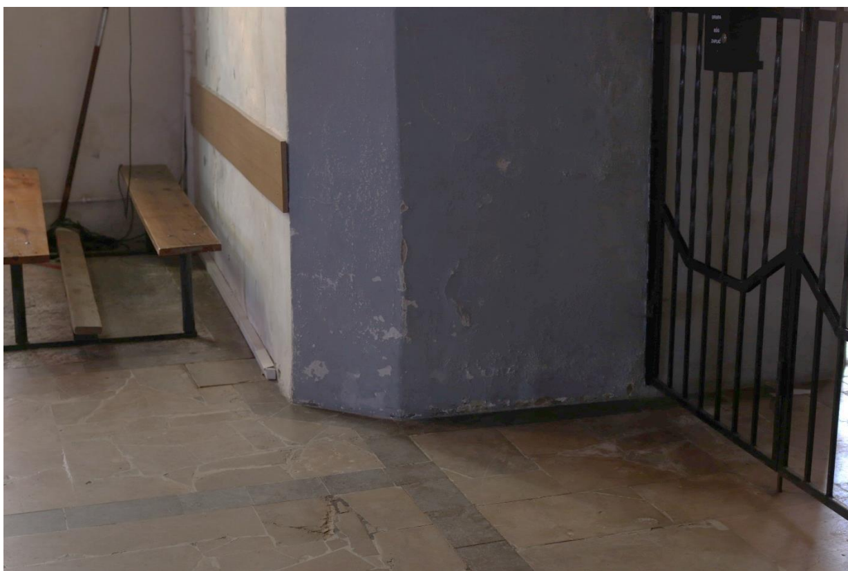
Ilustracja 10. Tynk odspajający się od ścian w wyniku zawilgocenia
