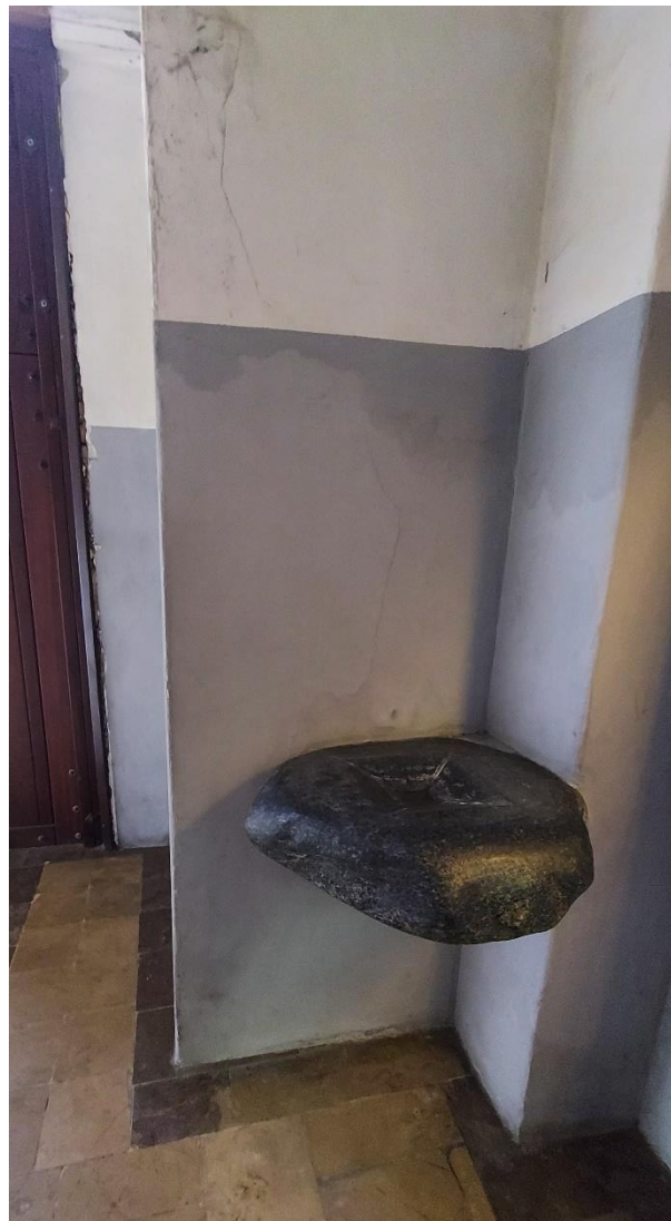
Ilustracja 16. Zacieki spowodowane zawilgoceniem kościoła
