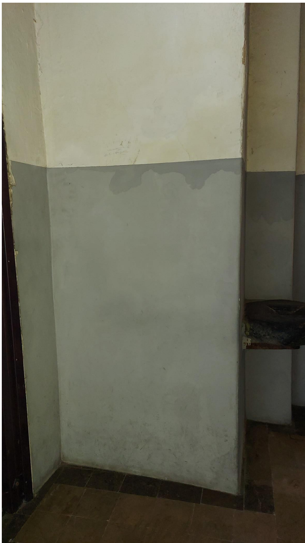
Ilustracja 14. Zacieki spowodowane zawilgoceniem kościoła
