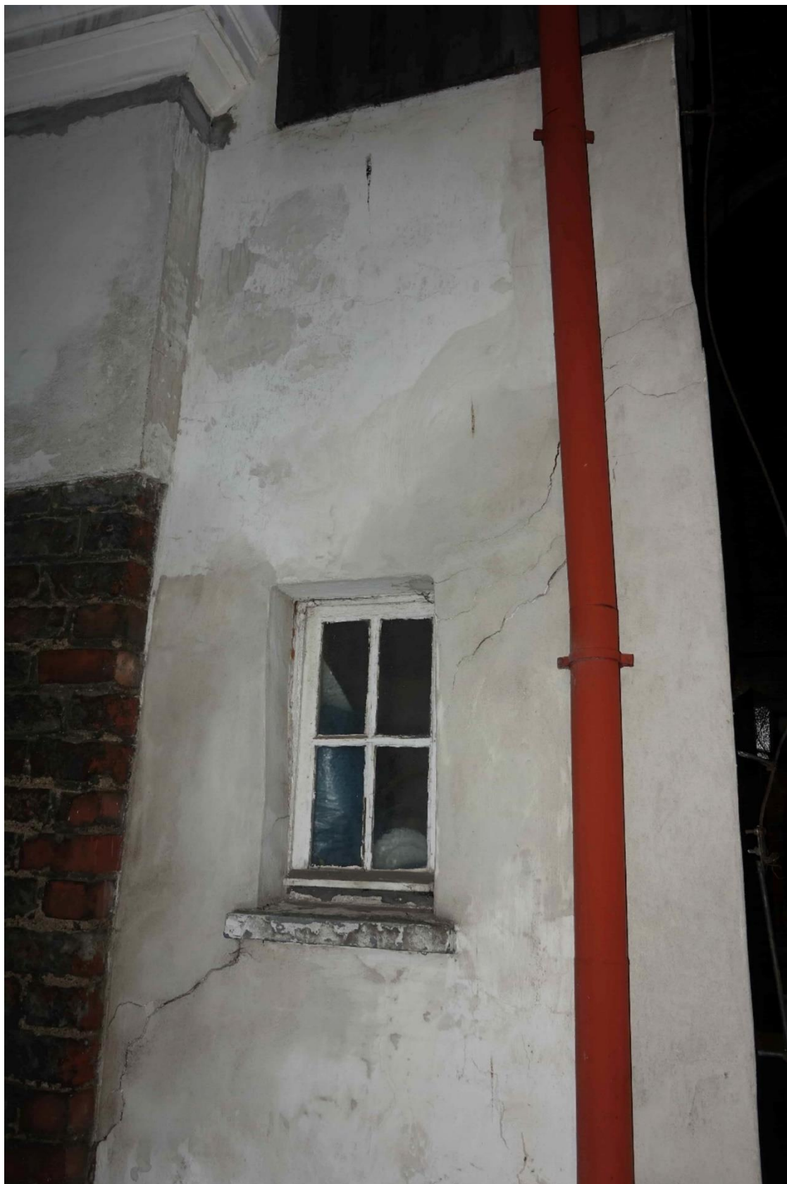
Ilustracja 8. Zawilgocenie ścian kościoła pw. św. Barbary
