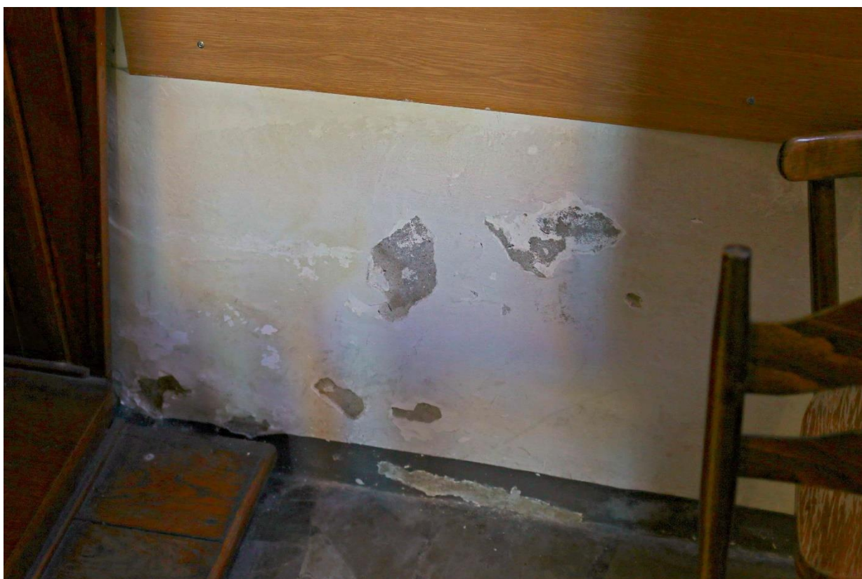
Ilustracja 13. Tynk odspajający się od ścian w wyniku zawilgocenia
