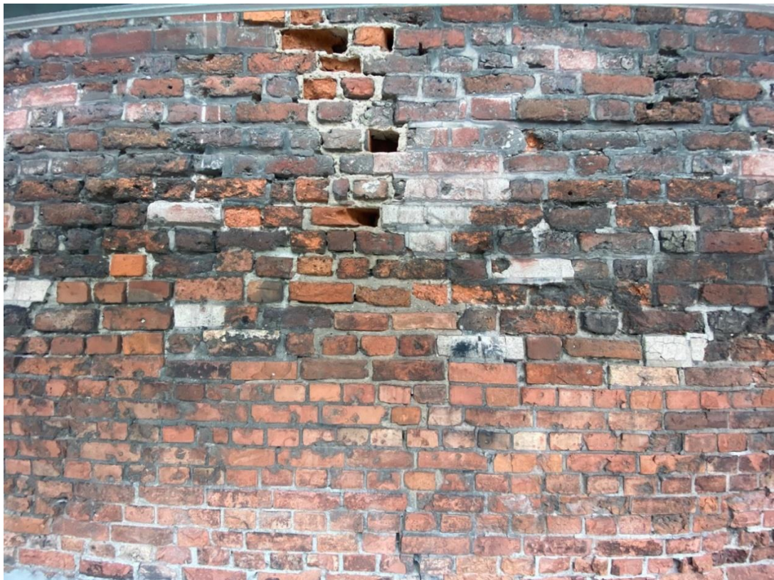
Ilustracja 15. Duże zniszczenia materiału ceramicznego pod betonowymi uzupełnieniami.
