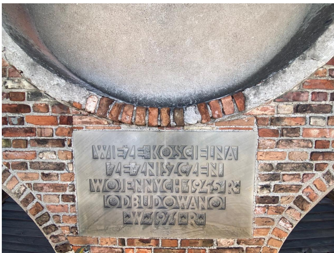
Ilustracja 8. Miejsce po zegarze, poważne uszkodzenia tynków, które odpadają od powierzchni.
