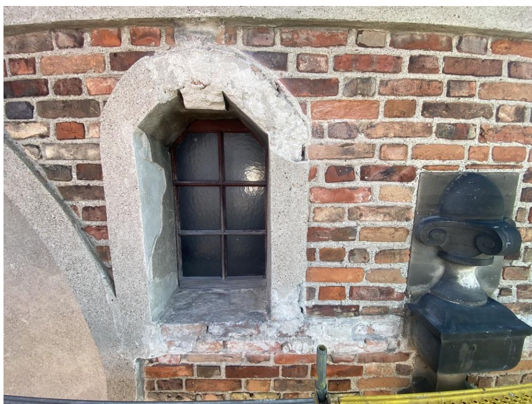
Ilustracja 9. Poważne uszkodzenia tynków.
