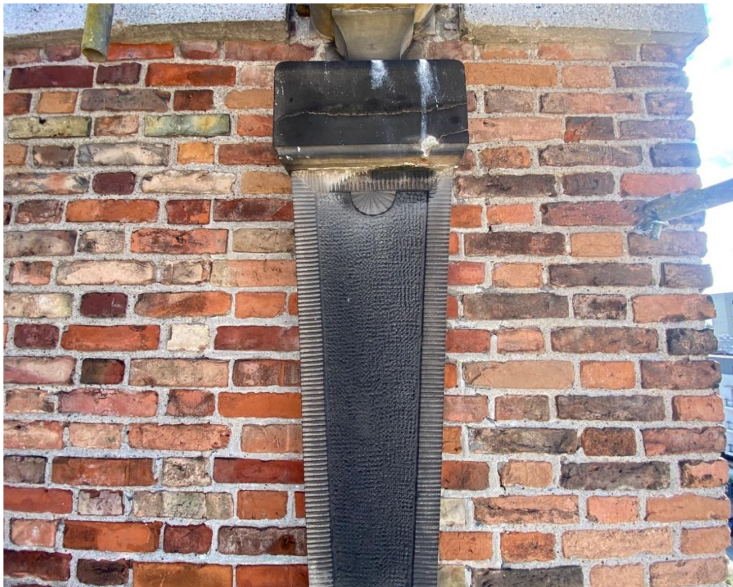
Ilustracja 11. Nawarstwienia miejskie (zabrudzenia powierzchni) na detalach kamiennych.
