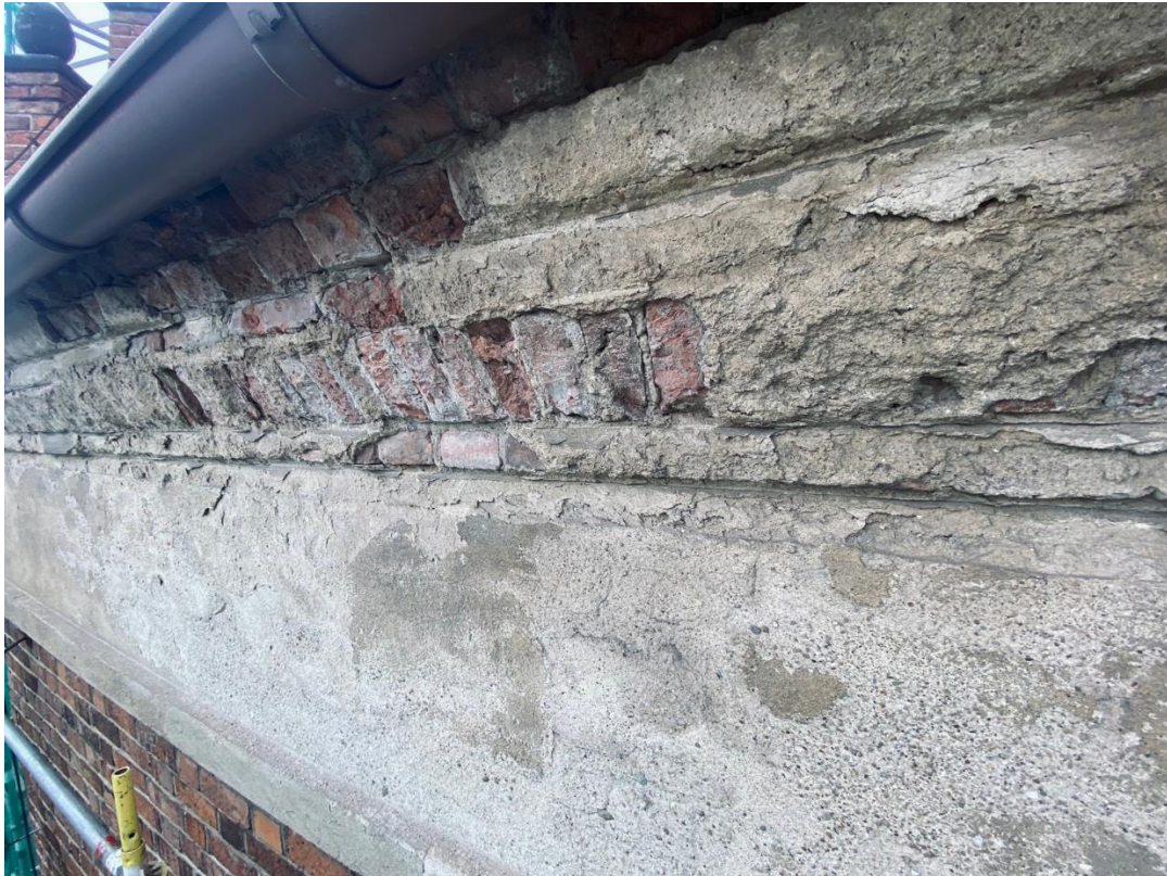
Ilustracja 10. Całkowita destrukcja gzymsu znajdującego się w połowie wysokości wieży.
