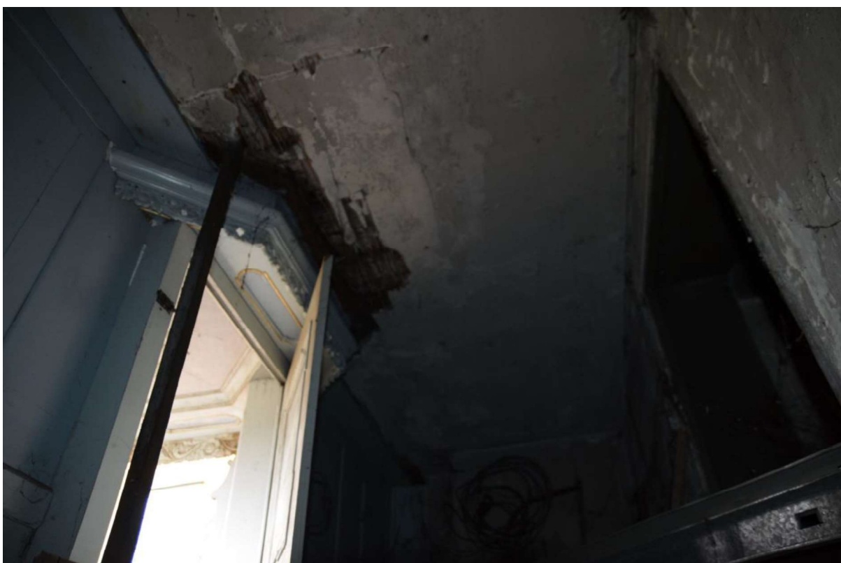
il 12 Wnętrze ambony - widoczna w ubytku na stropie słomiana podbitka. Fot. A.Faron
