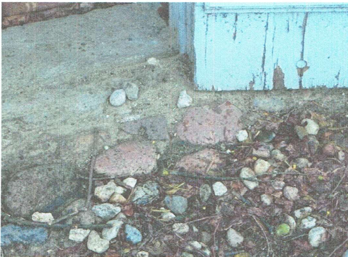
Zdjęcie 2, dolny pas ściany.
