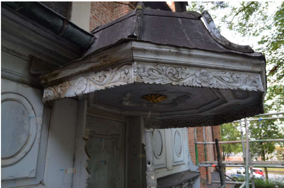
il 4 Baldachim - stan zachowania, widoczne zniszczenia drewna. Fot. M. Palka
