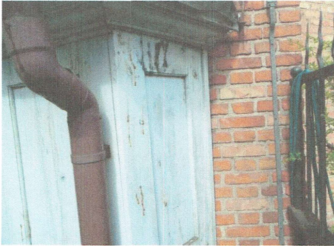
Zdjęcie 23, bok przybudówki, zniszczenie powłok malarskich.
