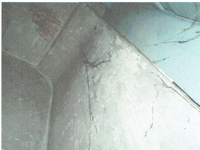
Zdjęcie 10, zniszczone tynki, widoczna trzcina.
