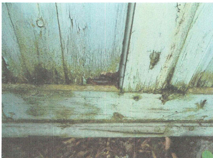
Zdjęcie 20, widoczne ubytki drewna, pełna perforacja.
