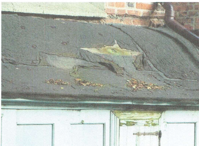
Zdjęcie 18, j.w, zniszczone tymczasowe pokrycie z papy.
