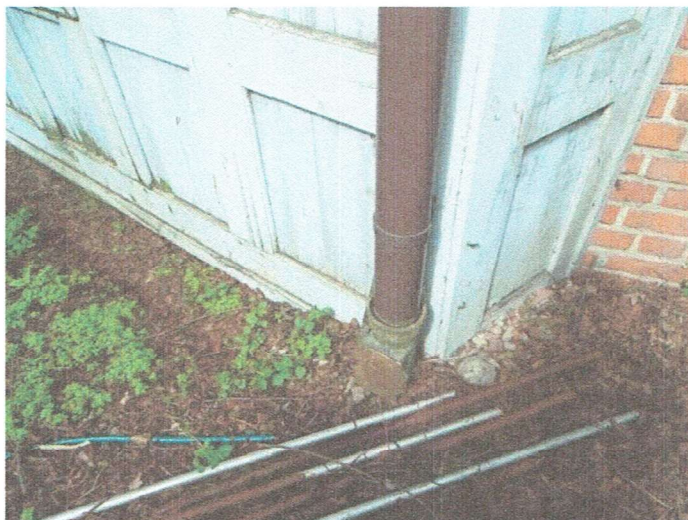
Zdjęcie 19, dolna część, zbyt wysoki poziom terenu w stosunku do dolnej krawędzi drewna.
