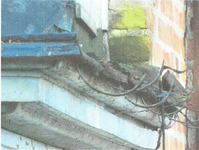
Zdjęcie 5, zdewastowane i zniszczone elementy rynien, rynny ukradziono.
