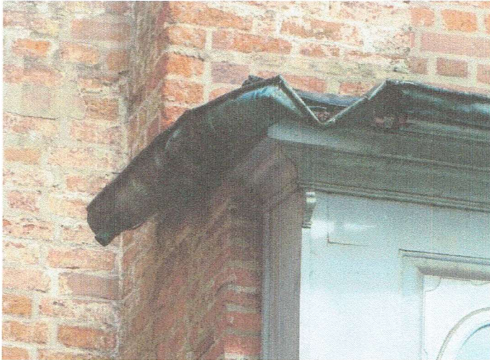
Zdjęcie 4, rynna zniszczona.
