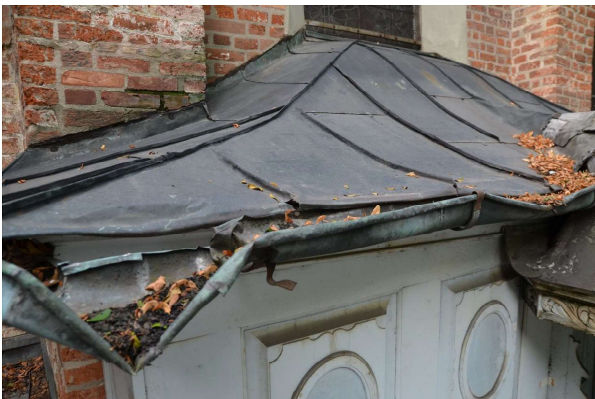
il 6 Dach nad górną częścią ambony - zniszczenia rynny. fot. M. Palka
