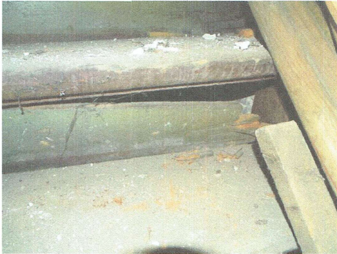
Zdjęcie 15, schody, uszkodzony element stopnicy i podstolnia.
