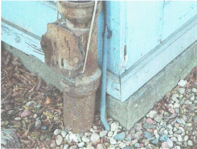
Zdjęcie 1, dolna część, narożnik zewnętrzny.
