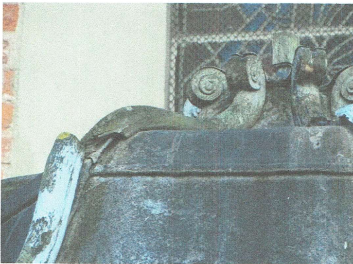
Zdjęcie 7, zniszczone elementy drewniane baldachimu.
