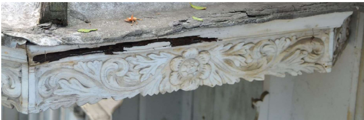
il 3 Duży ubytek drewna w ornamencie baldachimu (od strony wschodniej). Fot. M. Palka
