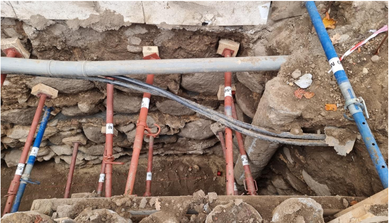
Ilustracja 30. Zdjęcia po zakończeniu pierwszej części prac - wykonanie palisady oraz podbudowy płyty dennej
