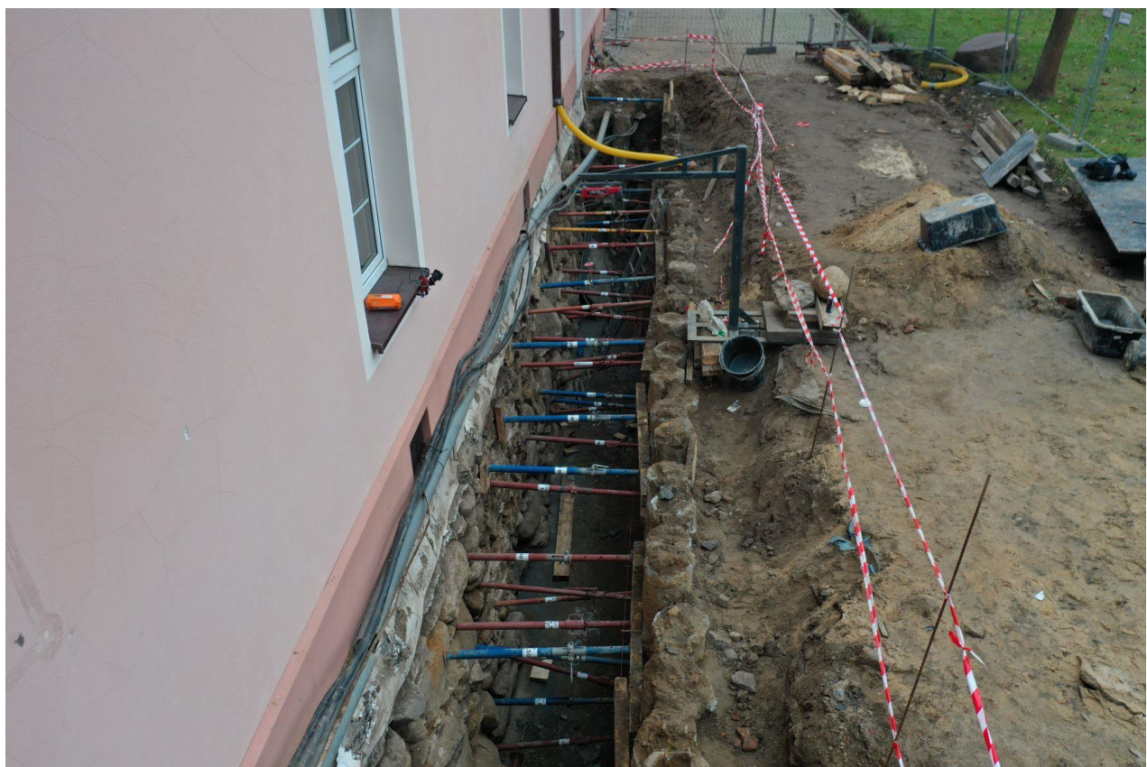
Ilustracja 29. Zdjęcia po zakończeniu pierwszej części prac - wykonanie palisady oraz podbudowy płyty dennej
