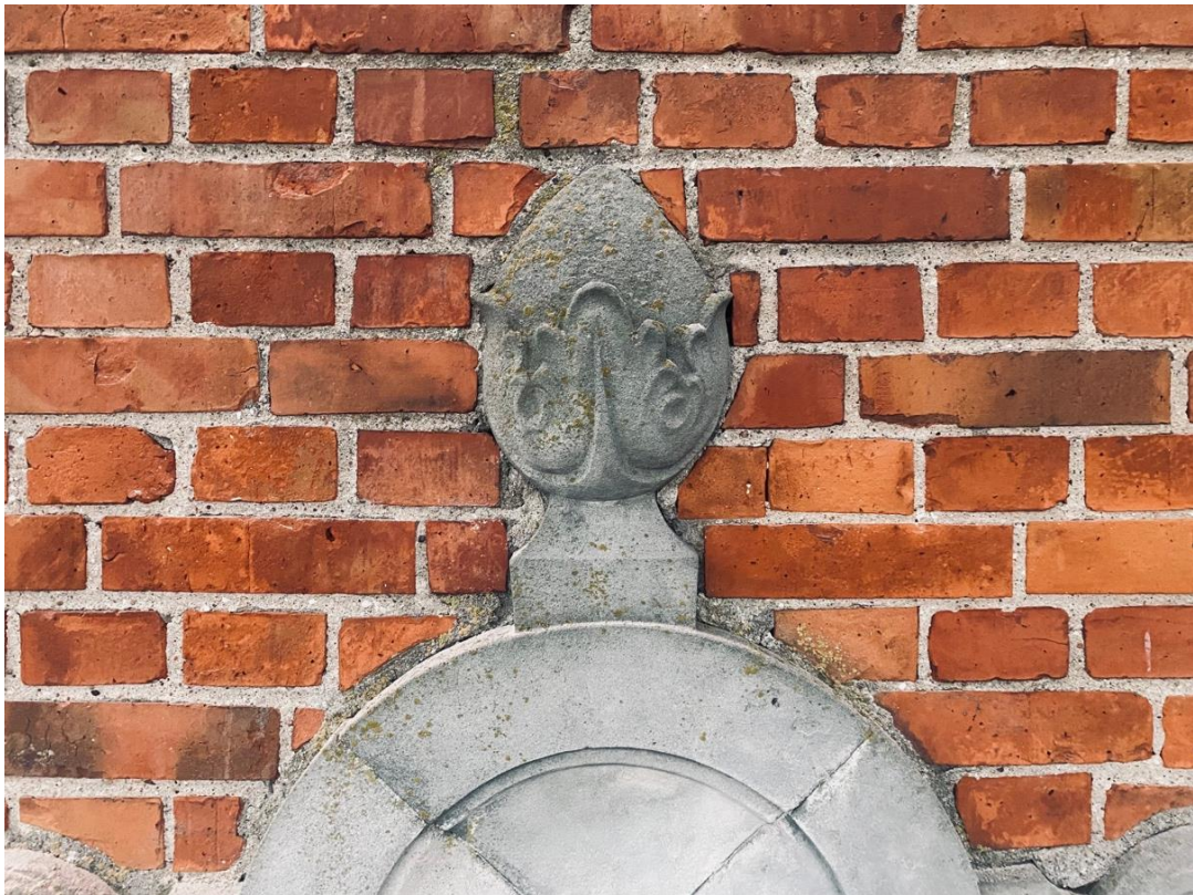
Ilustracja 10. Zabrudzenia mikrobiologiczne kamiennych detali.
