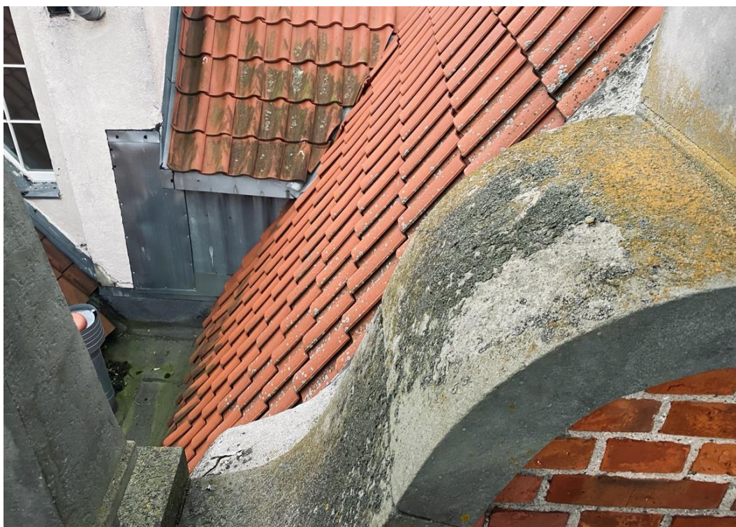
Ilustracja 8. Zabrudzenia mikrobiologiczne kamiennych detali.
