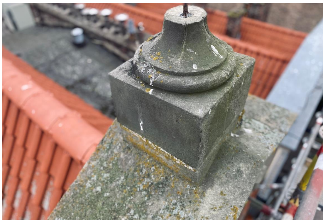
Ilustracja 7. Uszkodzenia kamiennego detalu architektonicznego oraz obecność mikroorganizmów.
