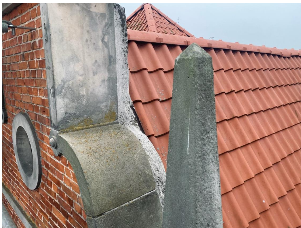
Ilustracja 9. Zabrudzenia mikrobiologiczne kamiennych detali.
