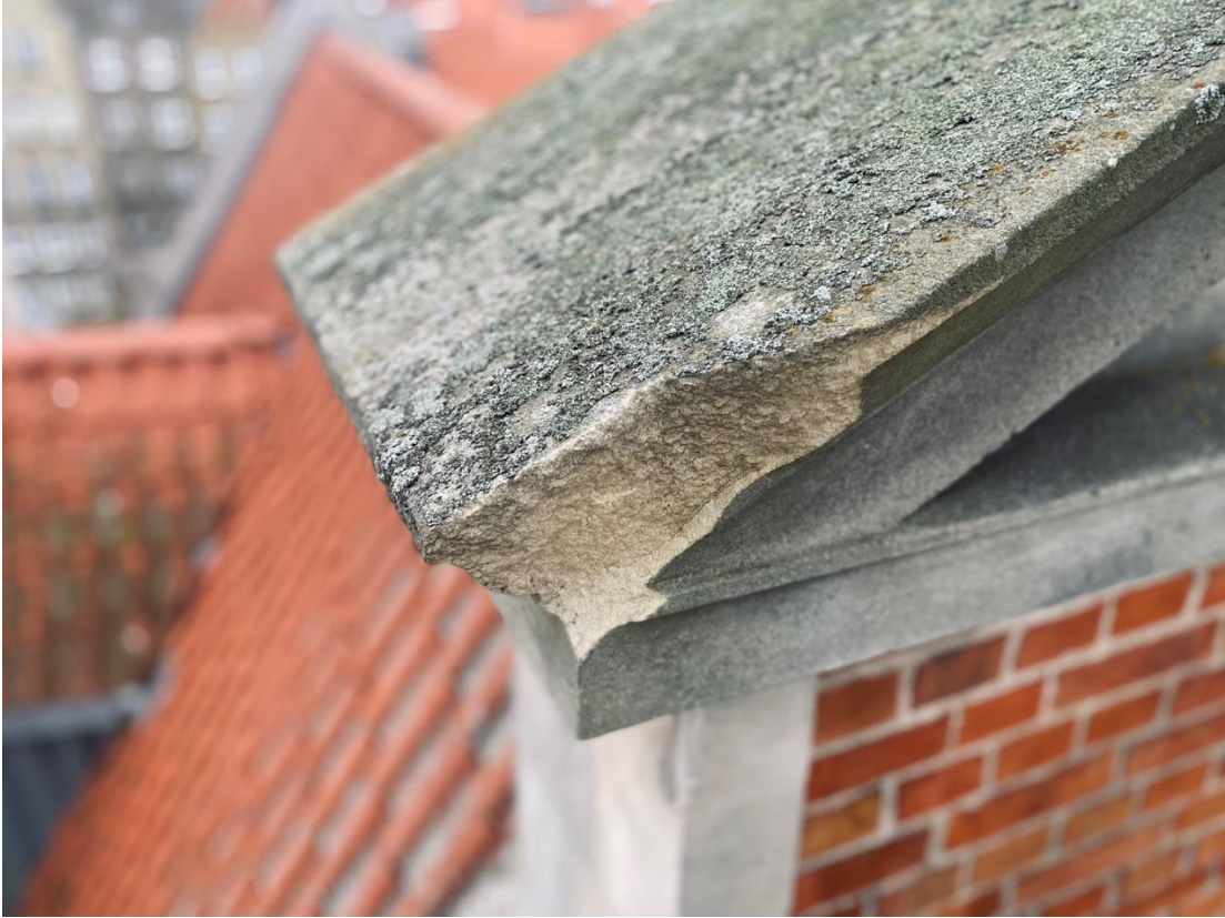
Ilustracja 12. Uszkodzenie fragmentu kamiennego gzymsu przez spadającą szyszkę.
