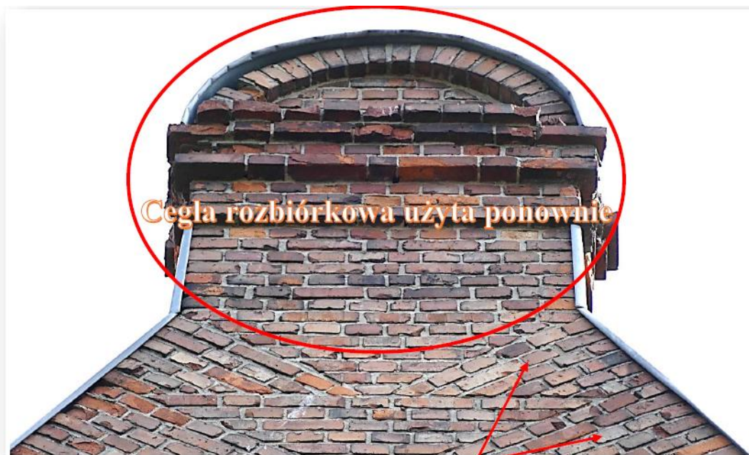
34. Powojenne odtworzenie szczytu elewacji tylnej. Wykorzystano cegły mieszane: rozbiórkowe i współczesne. Rekonstrukcja wątków historycznych, w „jodelkę”
