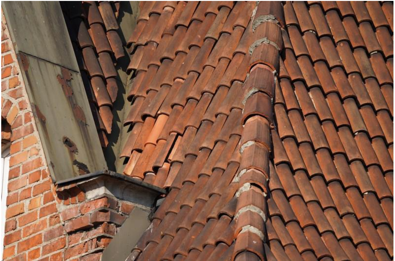
Ilustracja 17. Wysuwające się obluźnione dachówki
