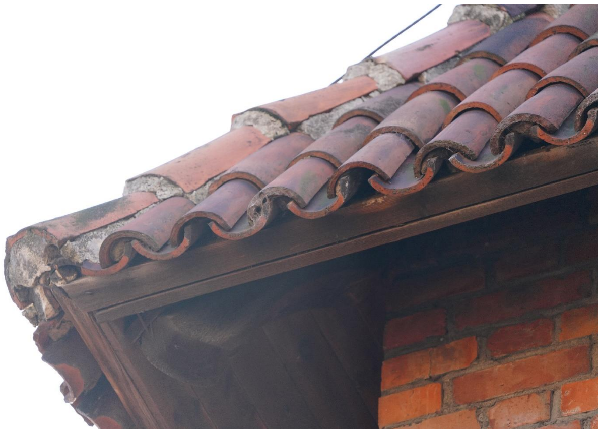
Ilustracja 22. Widok wykruszającej się zaprawy w miejscu łączenia dachówek i gąsiorów.
