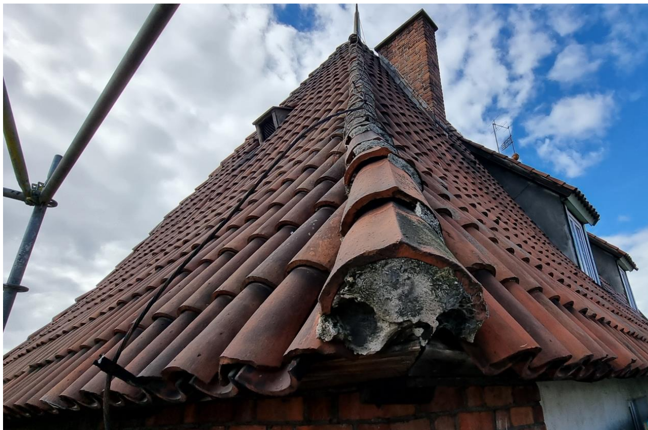
Ilustracja 23. Zniszczone dachówki i wykuszająca się zaprawa mocująca gąsiory.
