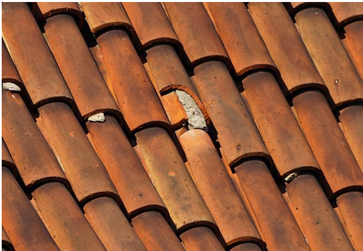
Ilustracja 19. Uszkodzone dachówki – zbliżenie.
