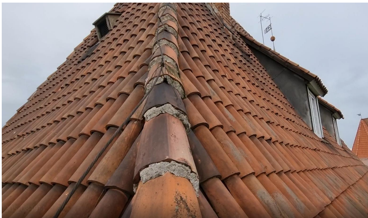
Ilustracja 25. Wykruszająca się zaprawa mocująca gąsiory oraz uszkodzona instalacja odgromowa.
