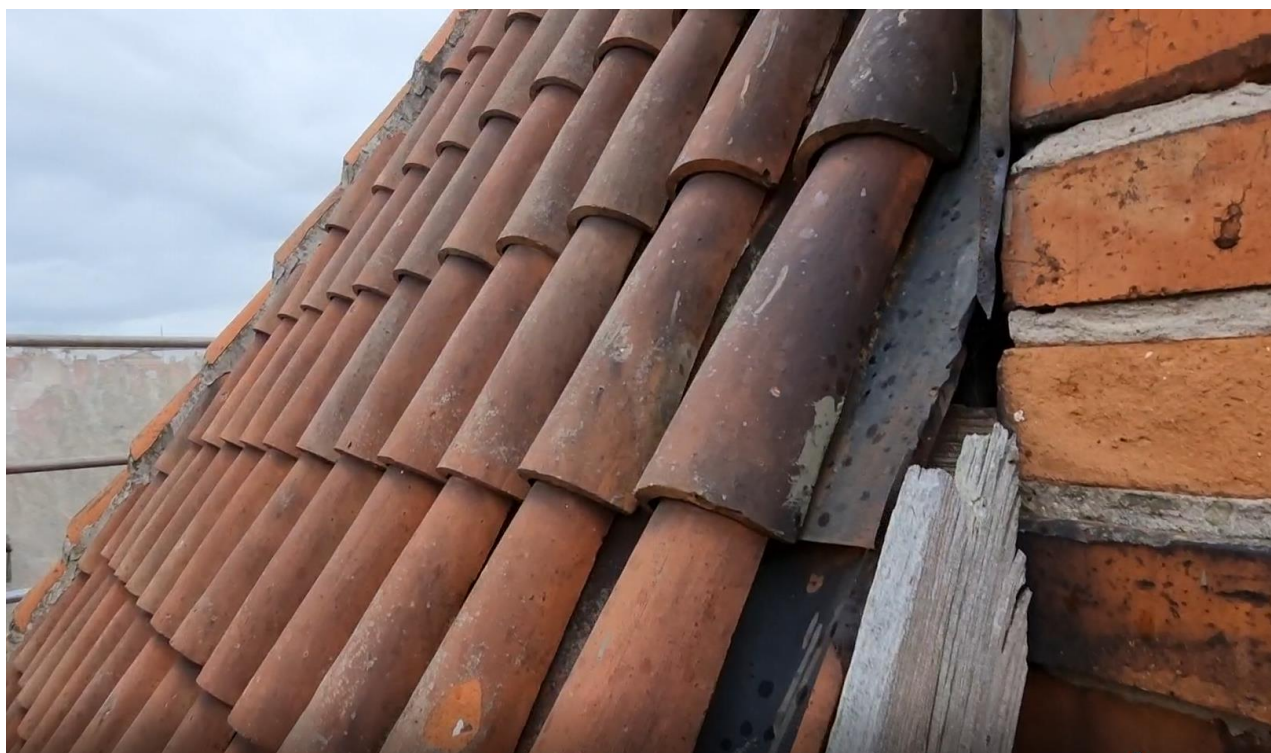
Ilustracja 26. Uszkodzone obróbki blacharskie
