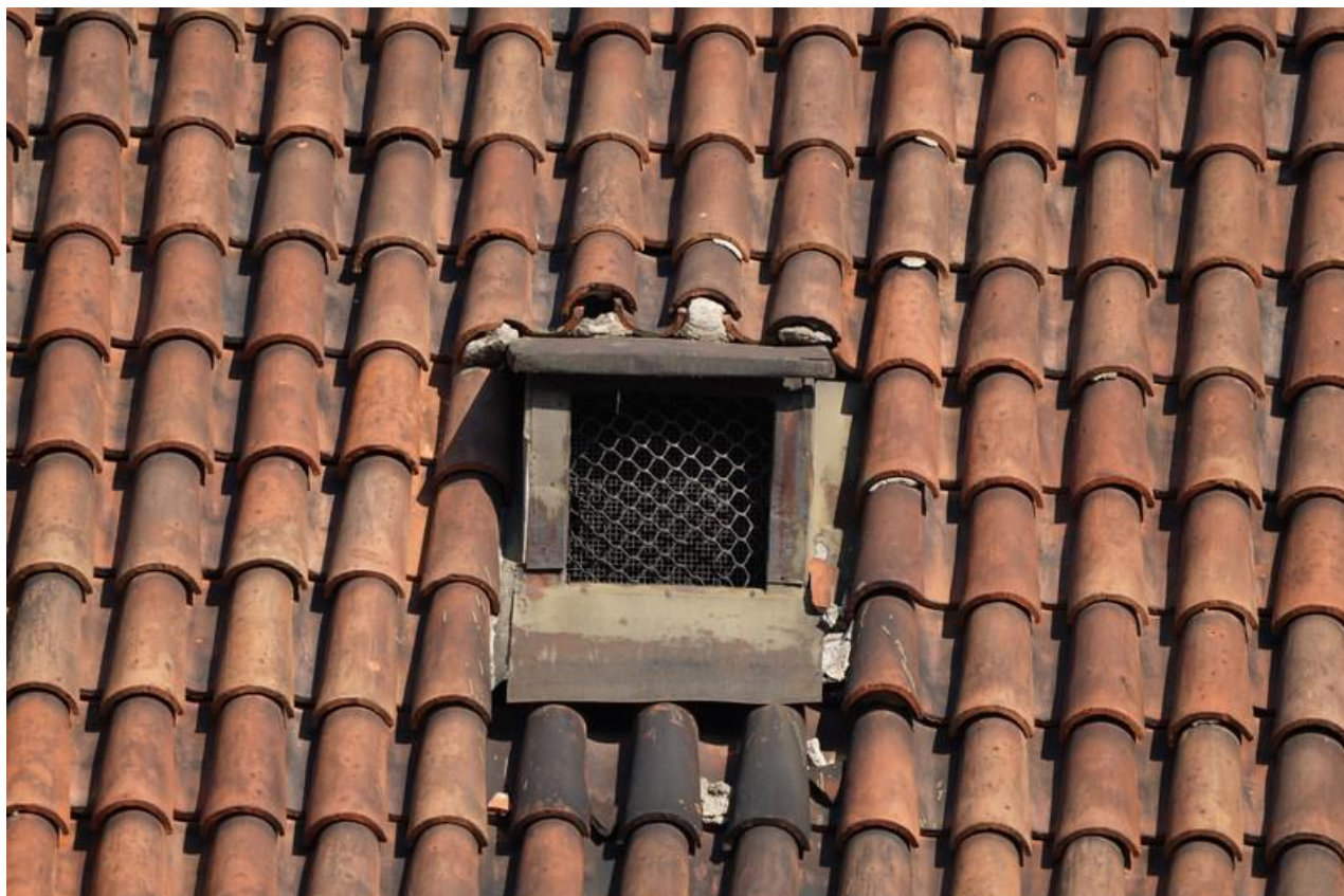
Ilustracja 15. Zniszczone obróbki blacharskie przy lukarnie.
