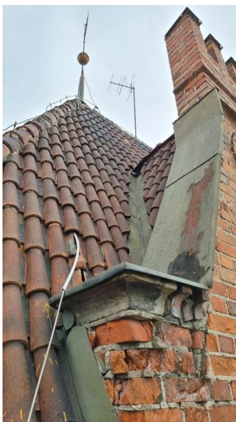
Ilustracja 24. Ubytki dachówek oraz uszkodzone obróbki blacharskie
