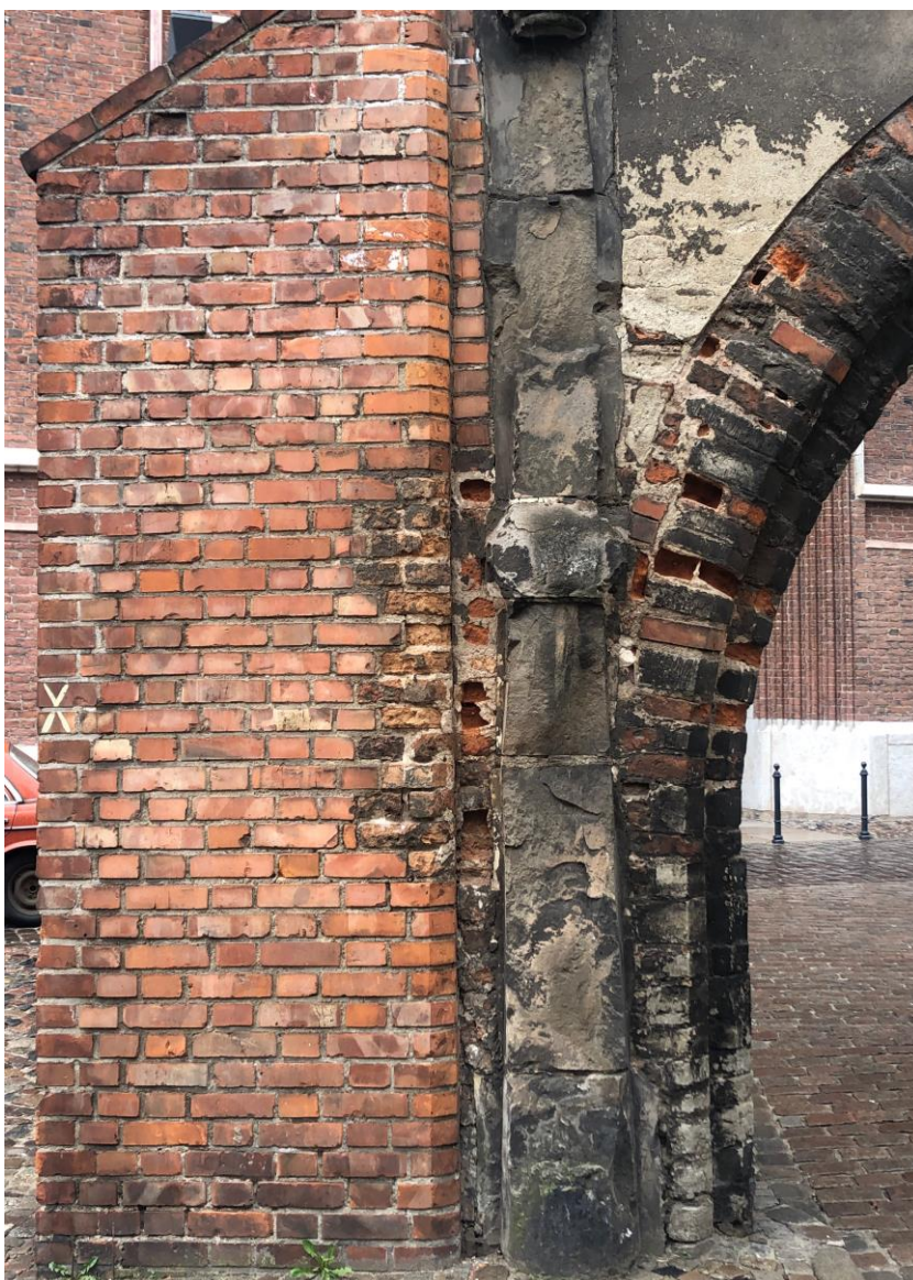
3. Filar zachodni - widoczne zniszczenia kamienia, cegły i tynków.
