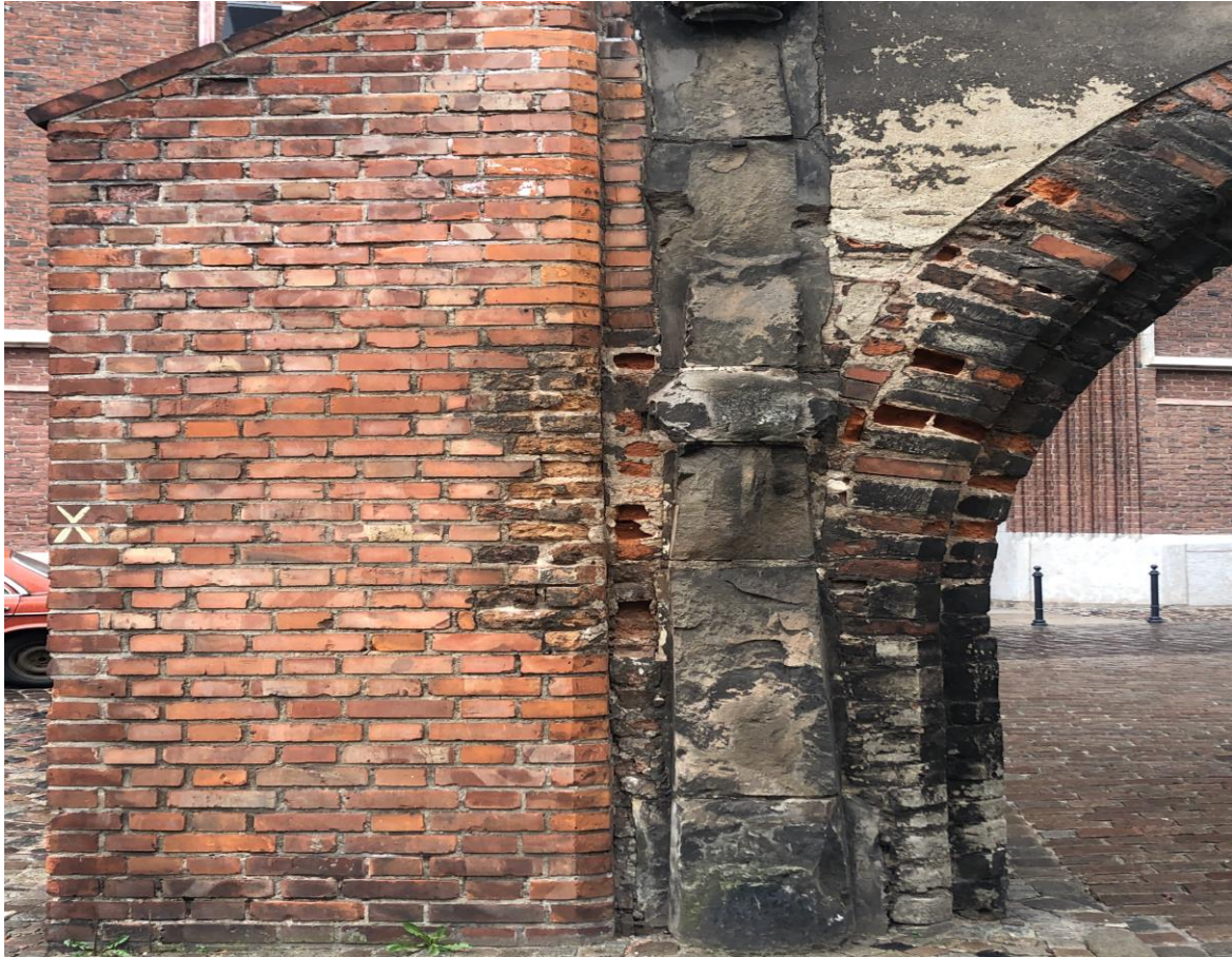
9. Przed konserwacją: filar zachodni od strony południowej. Widoczna destrukcja tynku, pojedynczych cegieł i zniszczona półkolumna.
