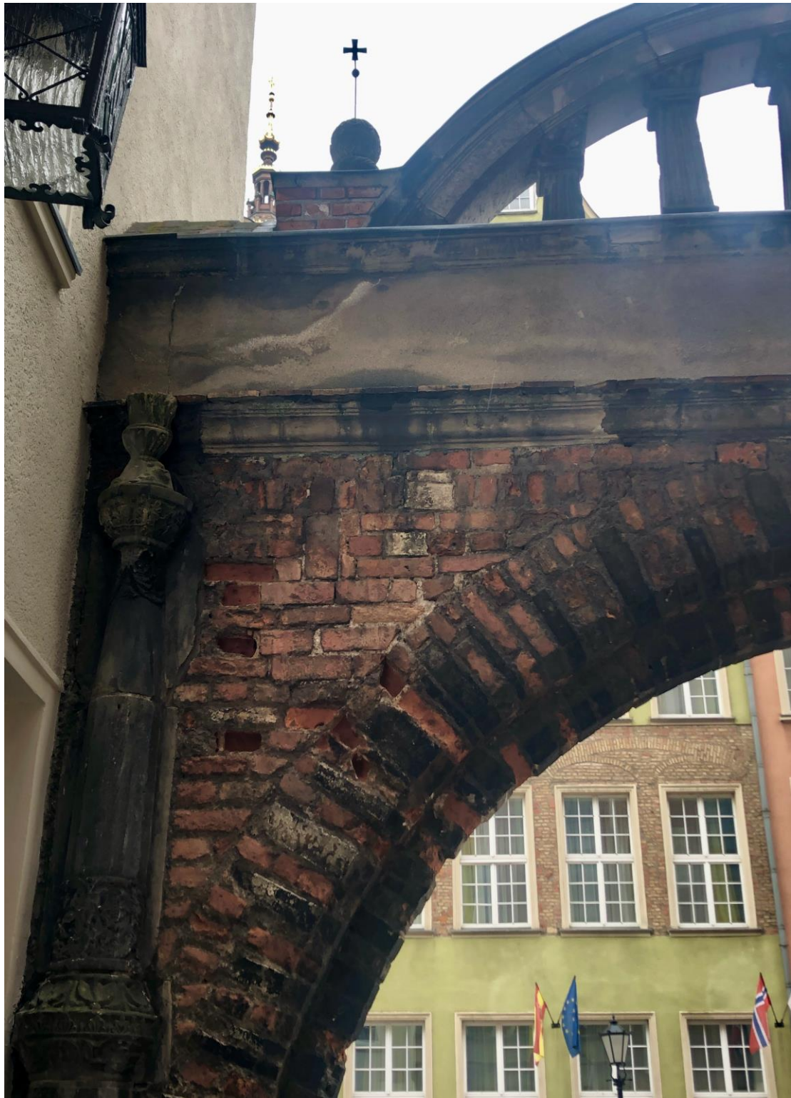
2.Przed konserwacją: wschodnia część łuku - widoczne zacieki i wykwyty soli.
