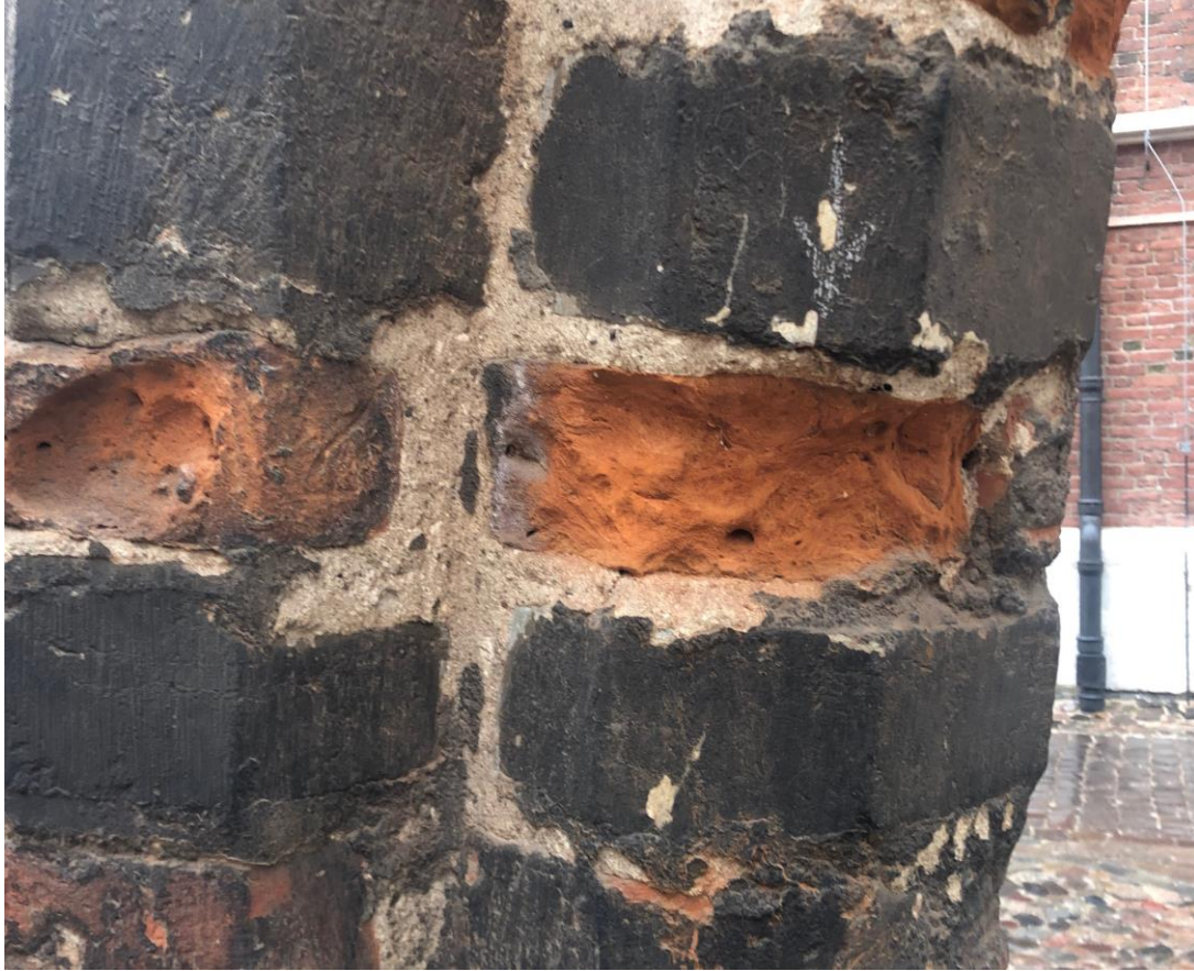
6. Korozja biologiczna cegieł i stopień zanieczyszczenia powierzchni.
