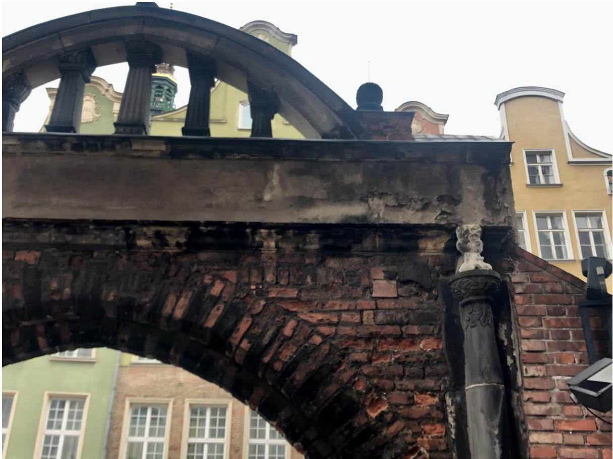
3. Przed konserwacją: zachodnia część łuku od strony północnej – zniszczenia tynku w partii fryzu.
