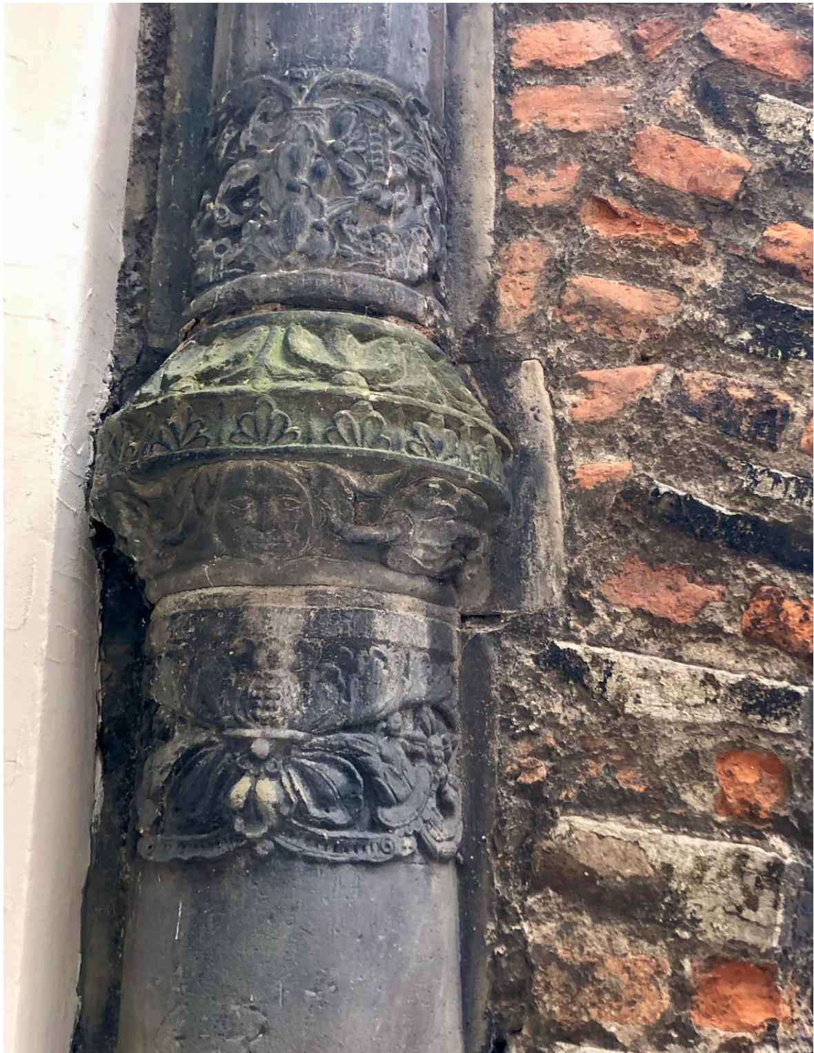
8.Przed konserwacją: półkolumna wschodnia, elewacja północna- widoczne porażenie kamienia glonami.
