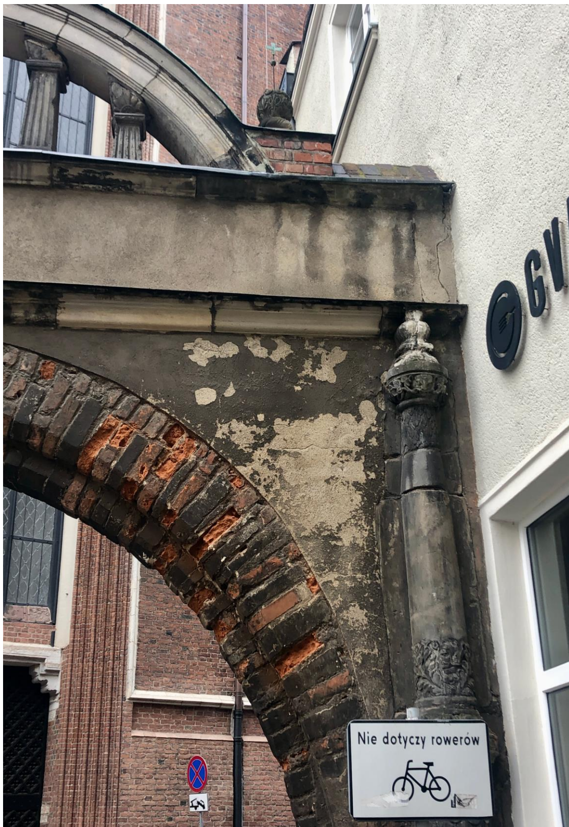
10. Przed konserwacją: filar wschodni od strony południowej- destrukcja tynku, zacieki w partii fryzu.
