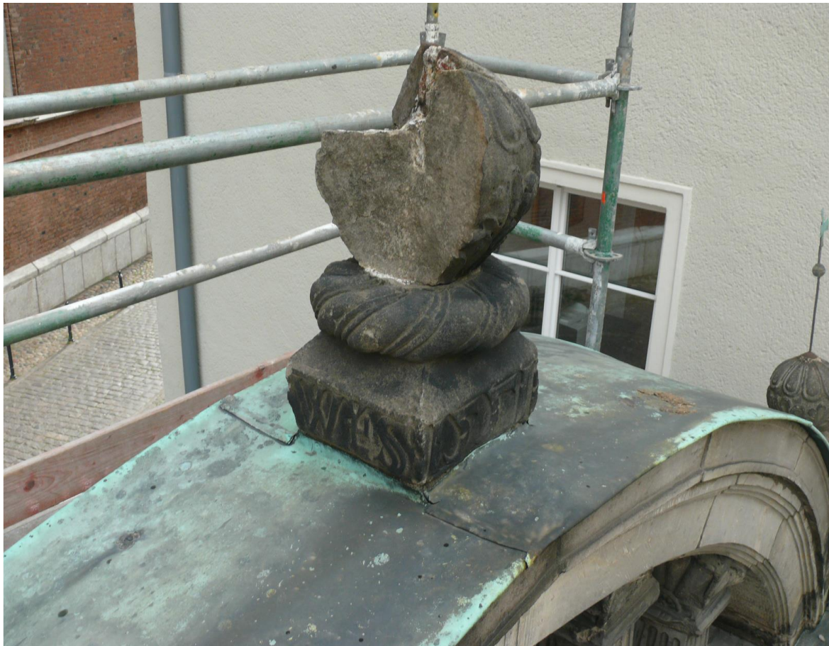
20. Przed konserwacją: ubytek detalu wieńczącego bramę.
