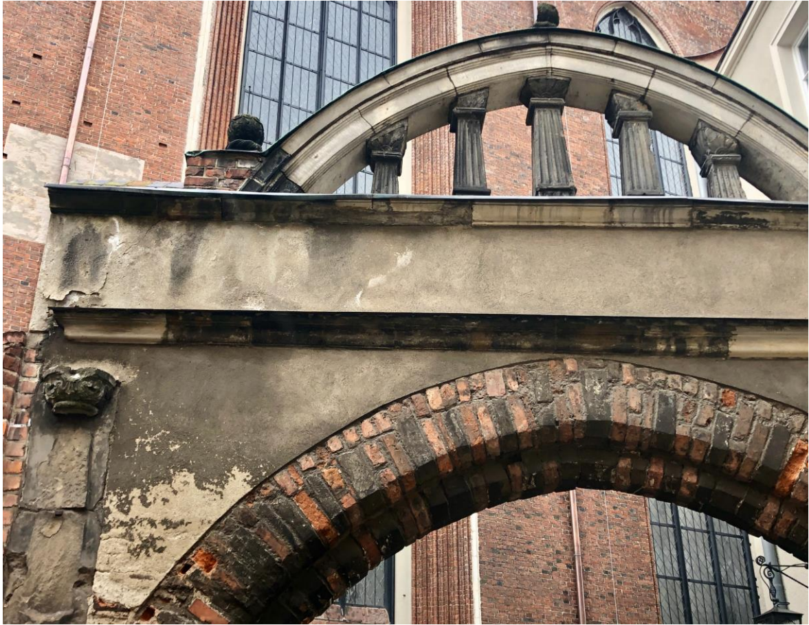
11. Fryz i zwieńczenie od strony południowej - widoczne złuszczenia tynku i zabrudzenia elementów kamiennych.
