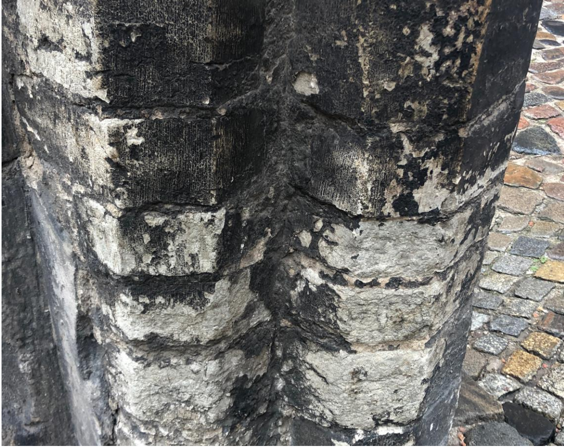
7. Nawarstwienia na powierzchni detalu kamiennego.
