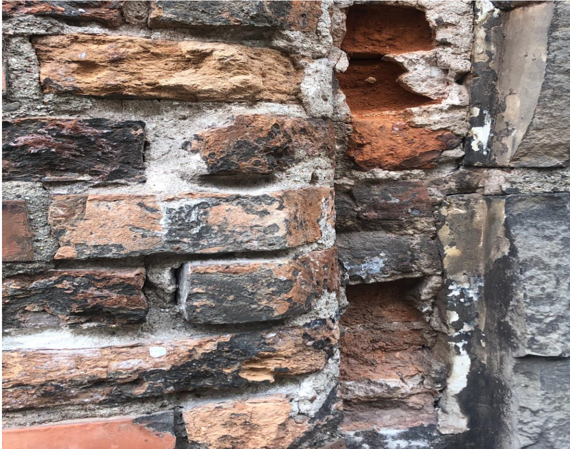
14.Przed konserwacją: zachodni filar od strony południowej - ubytki cegieł i spoin oraz stan zachowania powierzchni cegieł.
