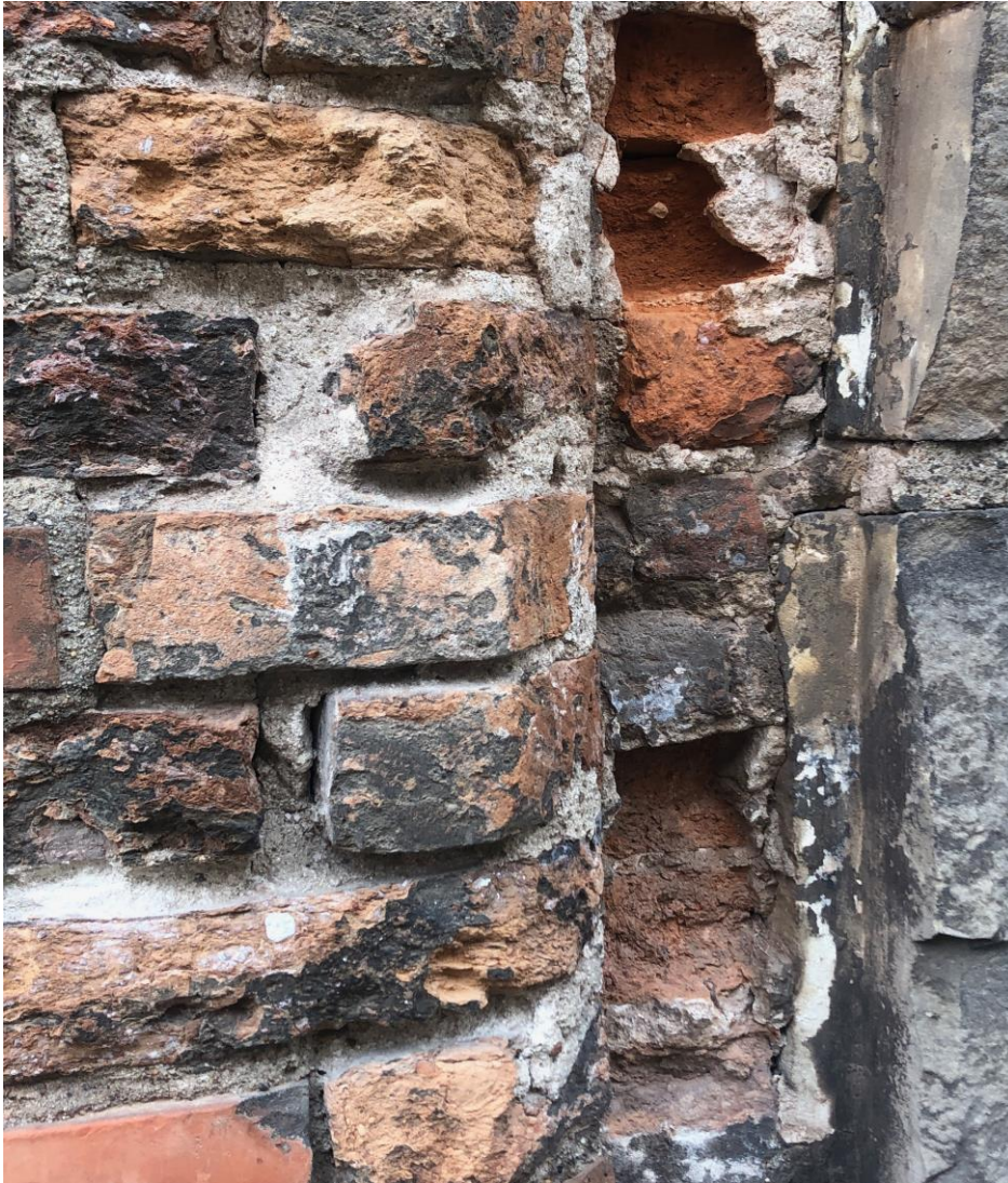
5. Widoczny stopień destrukcji ceglanego wstępu
