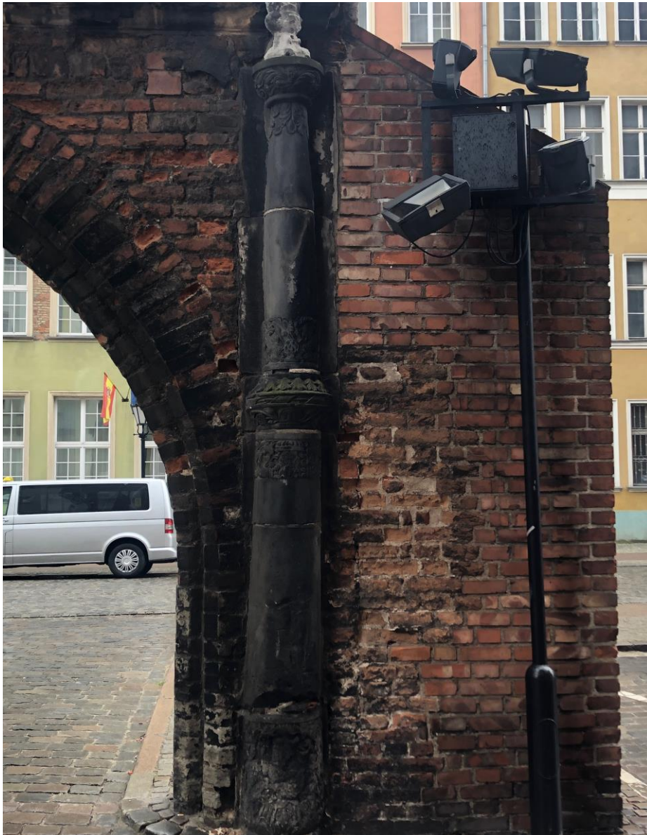
2.Filar zachodni z widocznymi wątkami historycznymi i uzupełnieniami współczesnymi.
