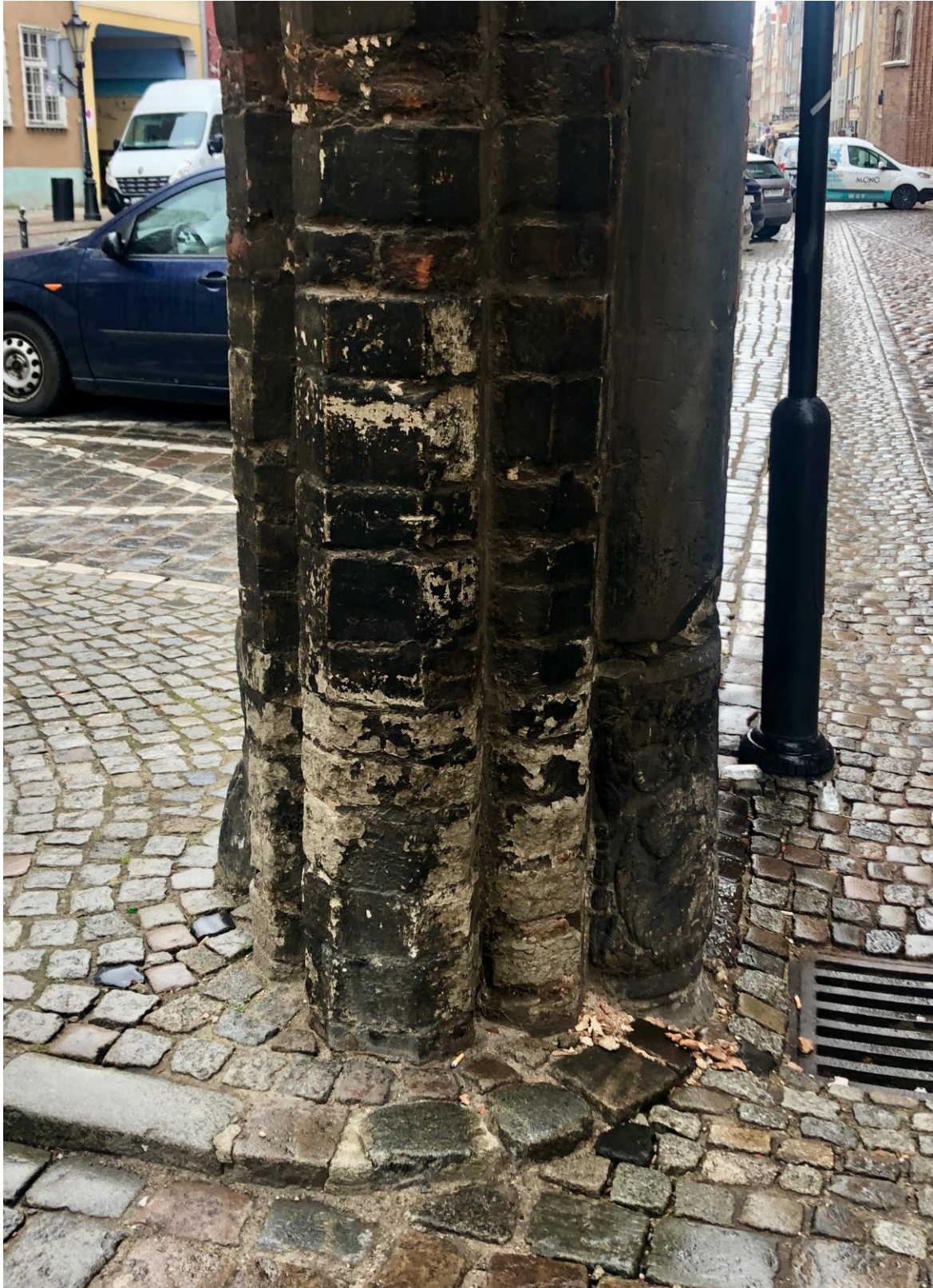
7. Przed konserwacją: filar zachodni, nawarstwienia zaszcelniające.
