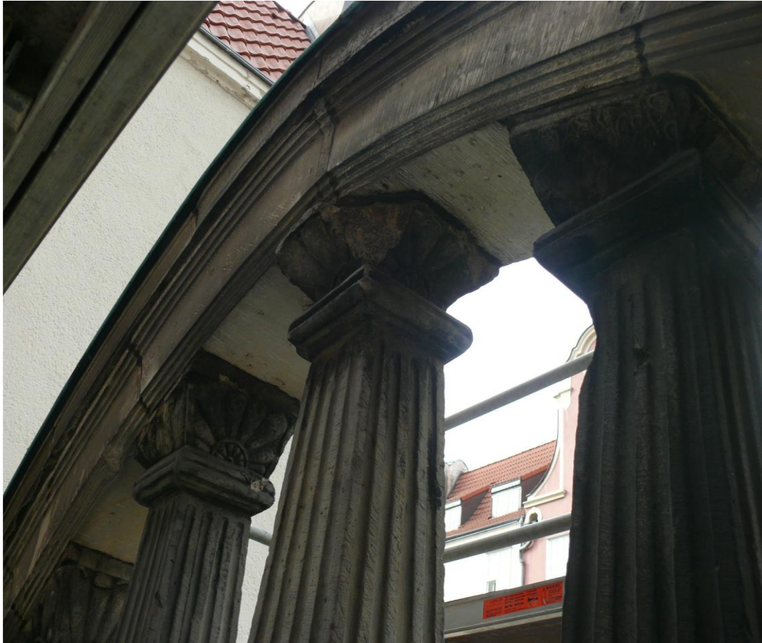
22. Przed konserwacją: ubytki tralek w łuku zwieńczenia.
