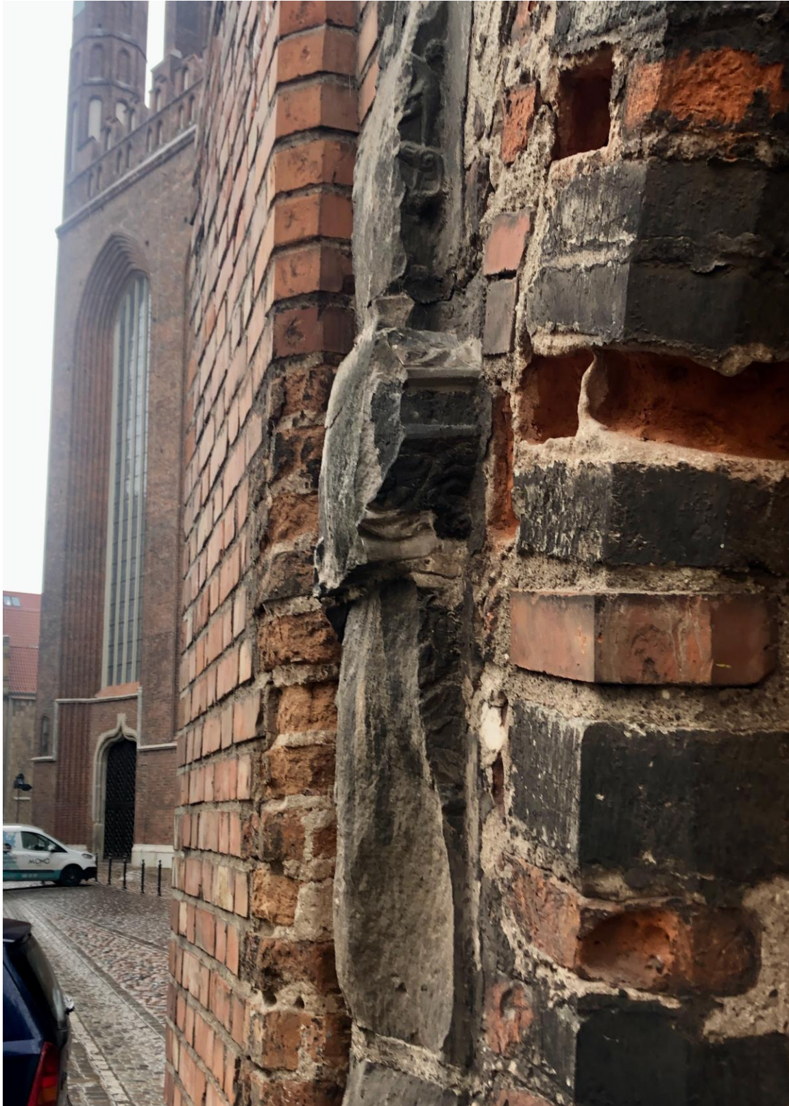
12. Głębokość ubytków zachodniej półkolumny oraz cegieł w konstrukcji łęku.
