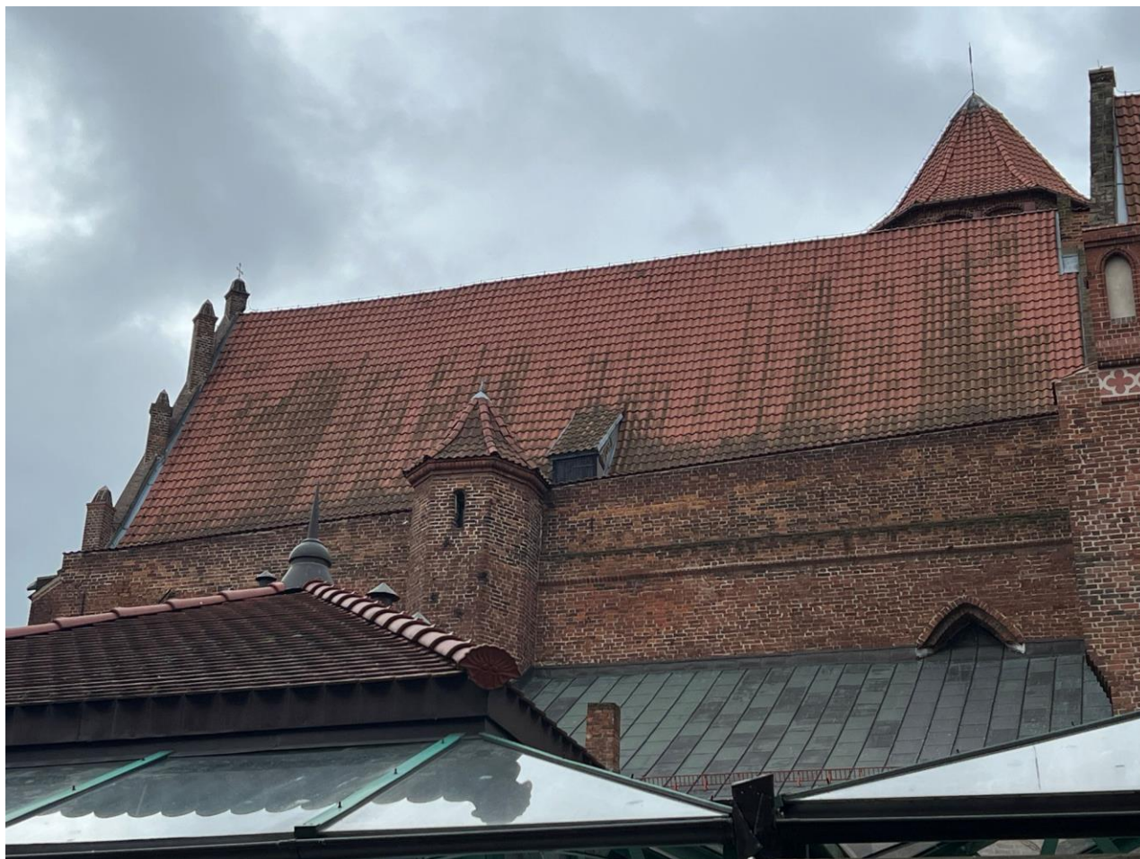
Fot. 1. Widok na elewację północną prezbiterium i kaplicę św. Jacka przed konserwacją (fot. M. Szczepkowski).
