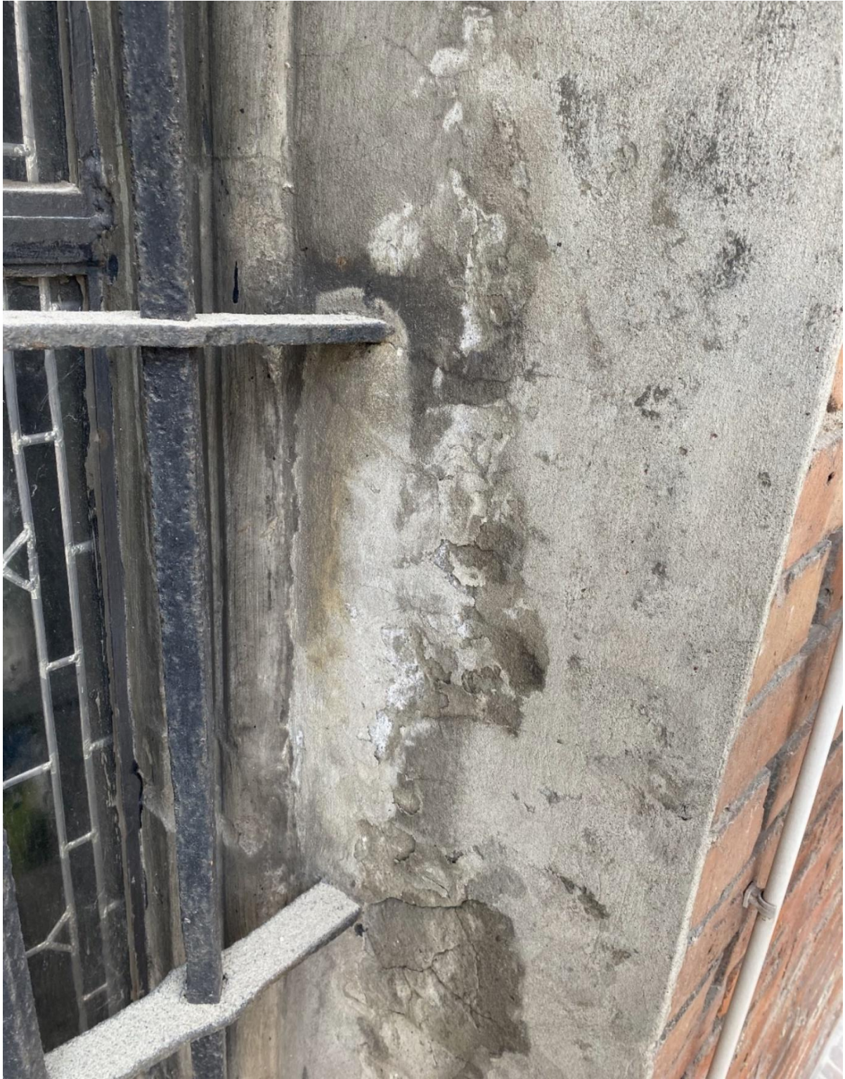
Fot. 11. Osłabiony i zasolony tynk w glifie okiennym elewacji północnej (fot. W. Domagała).
