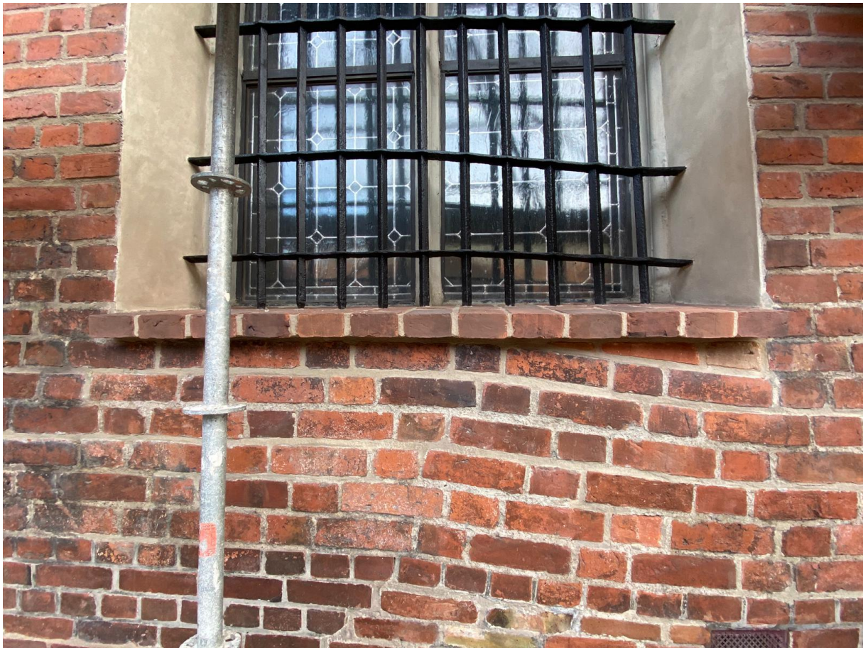
Fot. 23. Usunięto cementowy parapet i zastąpiono ceglanym, spójnym z elewacją (fot. W. Domagała).
