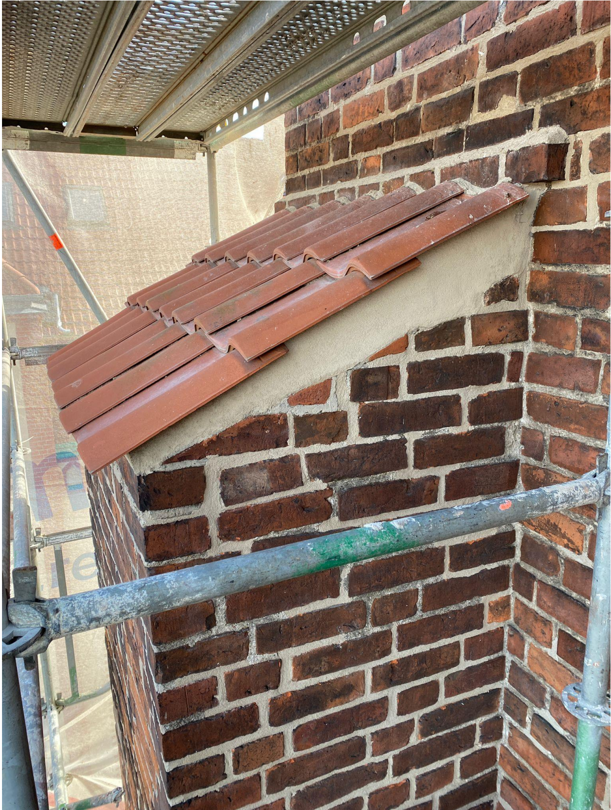
Fot. 21. Przestrzeń pod i na dachówce została dokładnie oczyszczona z wtórnych zapraw i nawarstwień pochodzenia mikrobiologicznego a następnie i uzupełniona (fot. W. Domagała)
