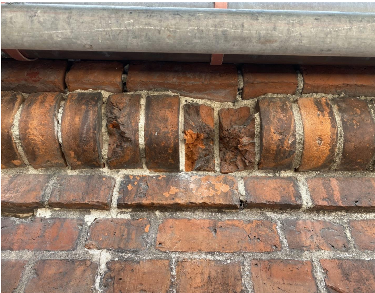
Fot. 6. Ubytki w cegle po wstępnym oczyszczeniu elewacji (fot. W. Domagała).
