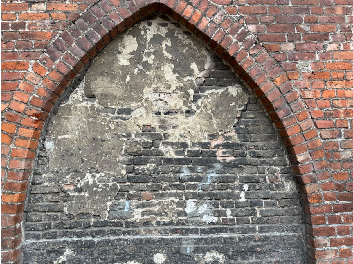
Fot. 14. Blenda elewacji północnej z pozostałościami tynku – stan przed konserwacją (fot. W. Domagała).
