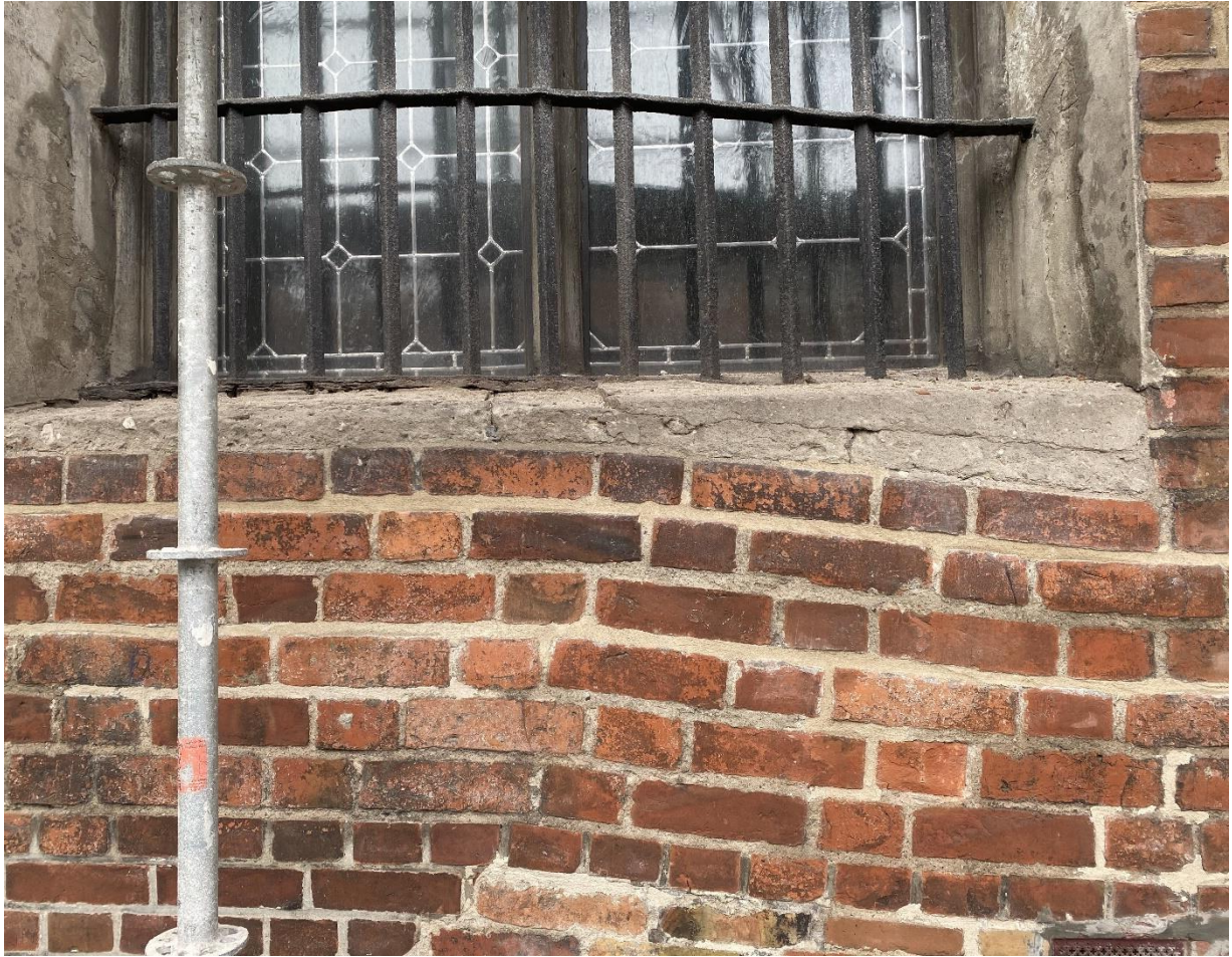
Fot. 12. Wtórne, cementowe uzupełnienie parapetu po wstępnym oczyszczeniu (fot. W. Domagała).
