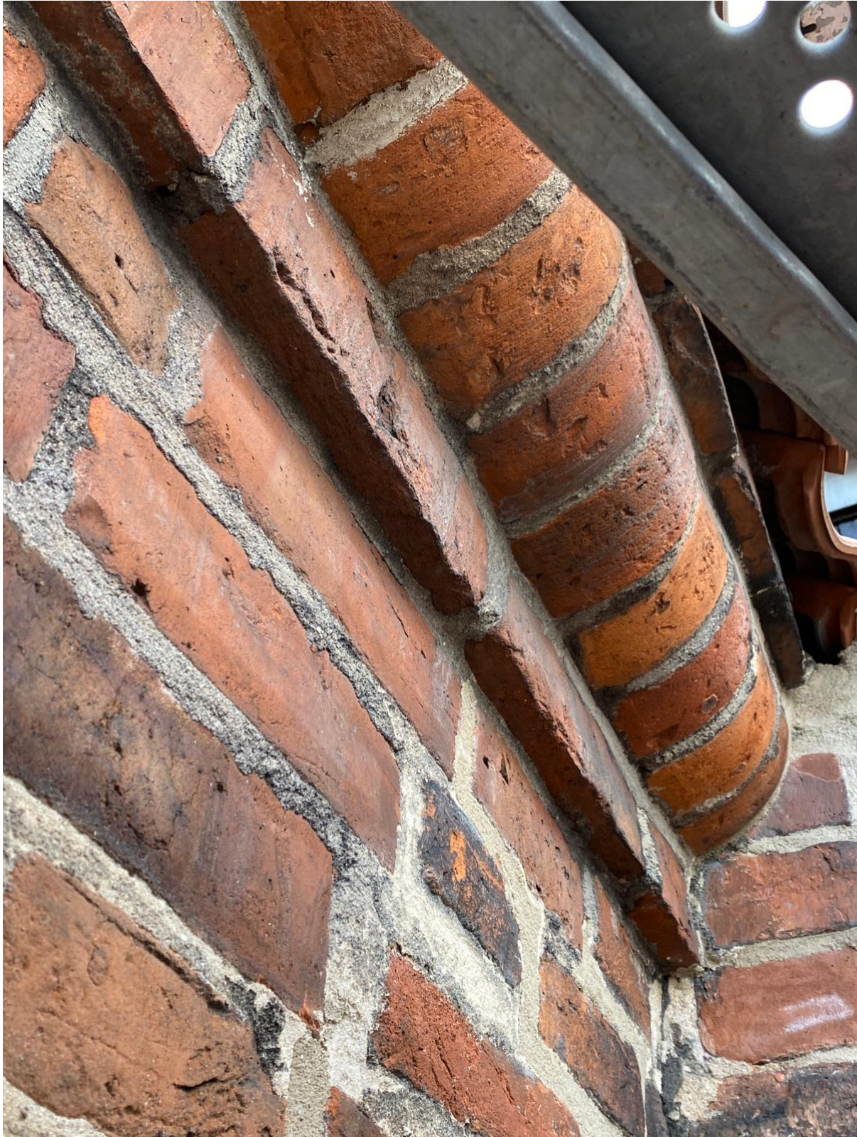
Fot. 18. Rolka ceglana po zabiegach konserwatorskich m.in. wzmocnieniu strukturalnym oraz uzupełnieniu ubytków i spoin (fot. W. Domagała)
