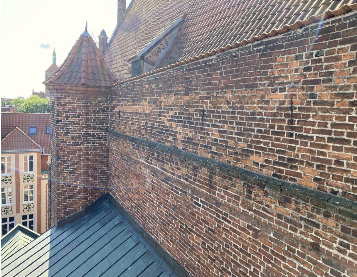
Fot. 2. Widok na elewację północną prezbiterium i kaplicę św. Jacka przed konserwacją (fot. W. Domagała).
