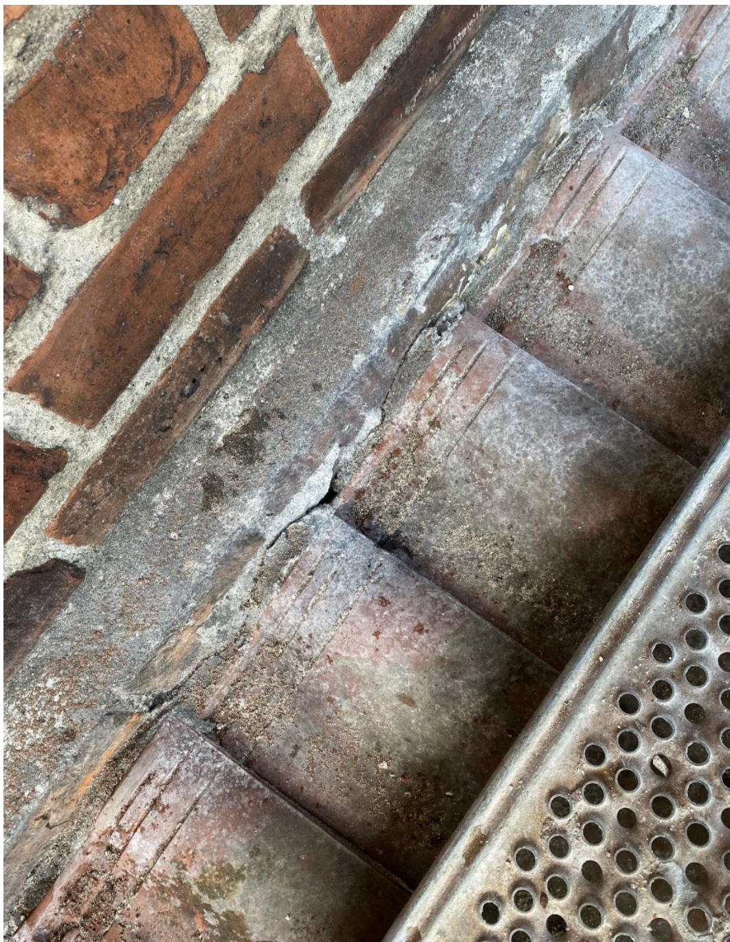
Fot. 10. Nawarstwienia pochodzenia mikrobiologicznego oraz wtórne zaprawy szpecące dachówkę (fot. W. Domagała).
