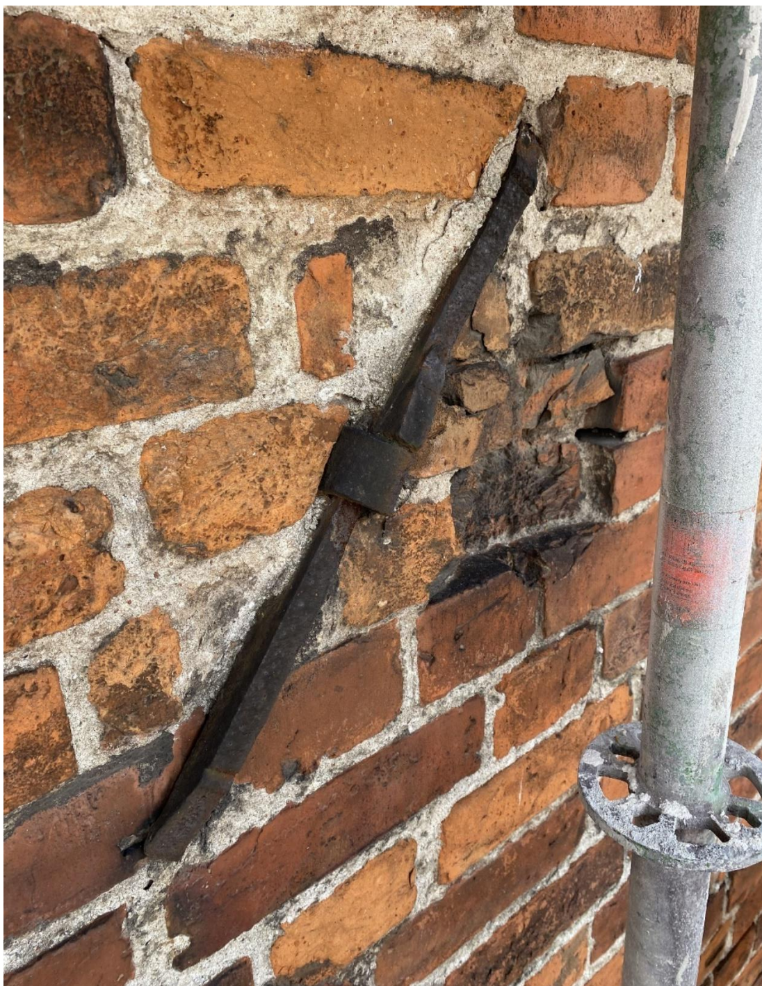
Fot. 16. Korodująca ankra na elewacji przed konserwacją (fot. W.Domagała).
