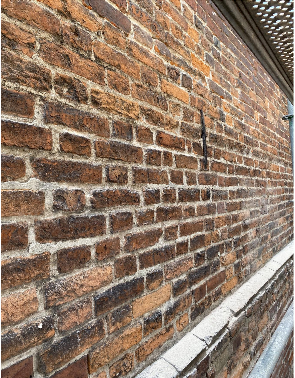
Fot. 4. Stan zachowania elewacji ceglanej przed konserwacją. Widoczna jest zdeintegrowana oraz spatynowana powierzchnia spieku materiału ceramicznego. Zauważalne są ubytki osłabionej i osypującej się spoiny (fot. W. Domagała).
