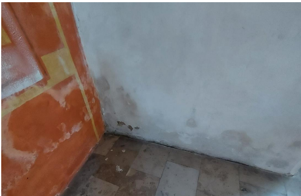
Ilustracja 13. Efekt zawilgocenia: zacieki na ścianach i posadzce, uszkodzenia malowidła.
