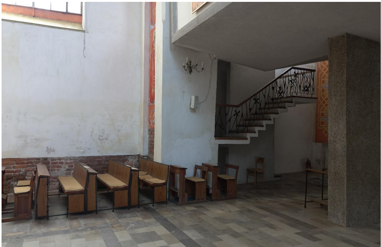
Ilustracja 38. Widok na zachodnią część ściany południowej kościoła po pracach dotowanych w 2023 r. ze środków Gminy Miasta Gdańska oraz MKiDN i wkładu własnego.
