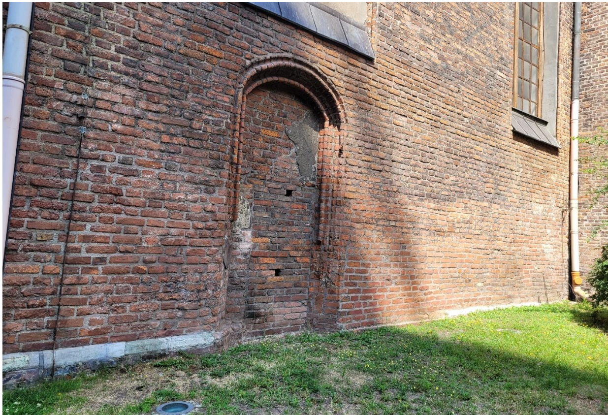
Ilustracja 45. Widok na zachodnią część południowej ściany kościoła po pracach dotowanych w 2023 r. ze środków Gminy Miasta Gdańska oraz MKiDN i wkładu własnego.
