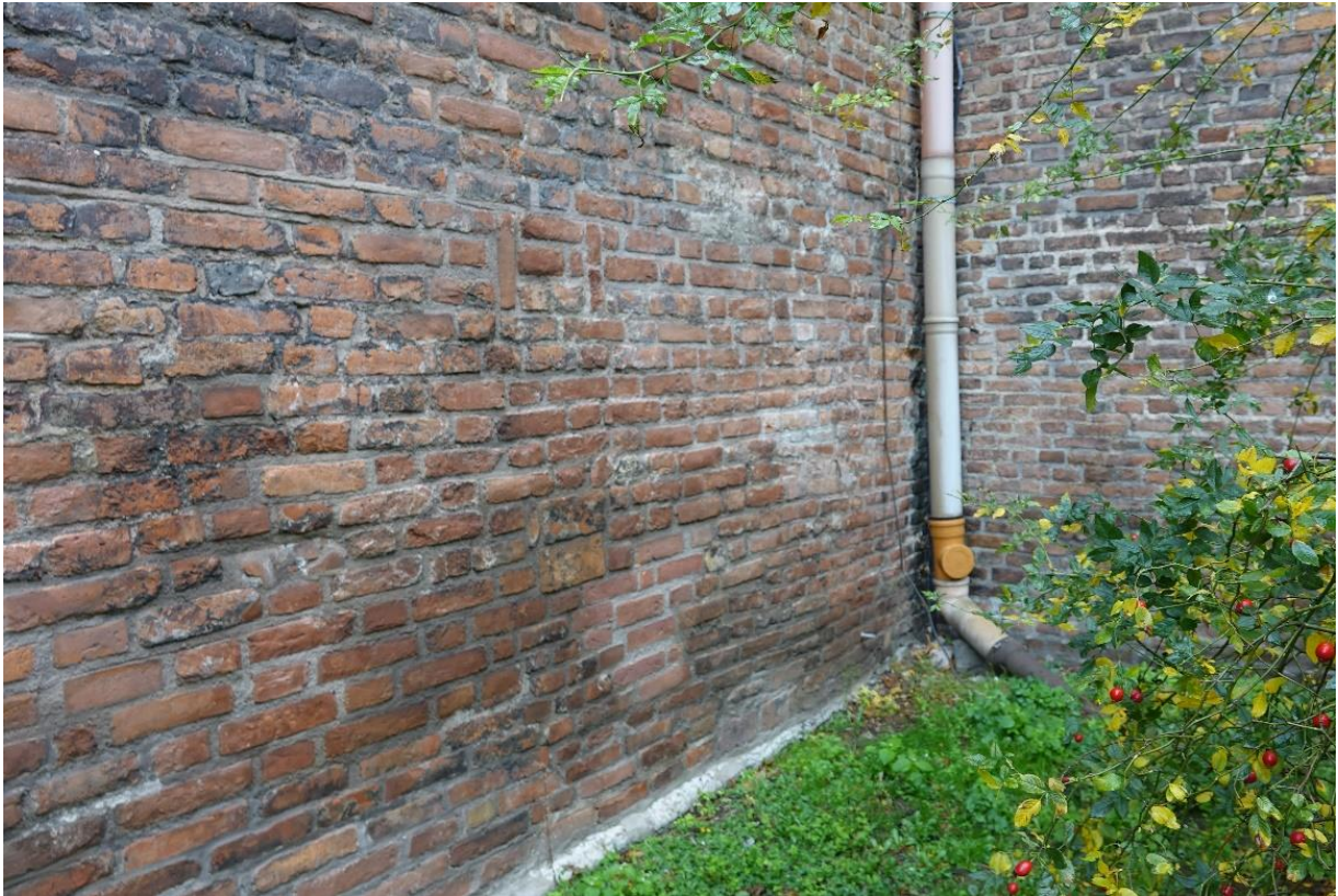
Ilustracja 11. Zawilgocone mury kościoła.
