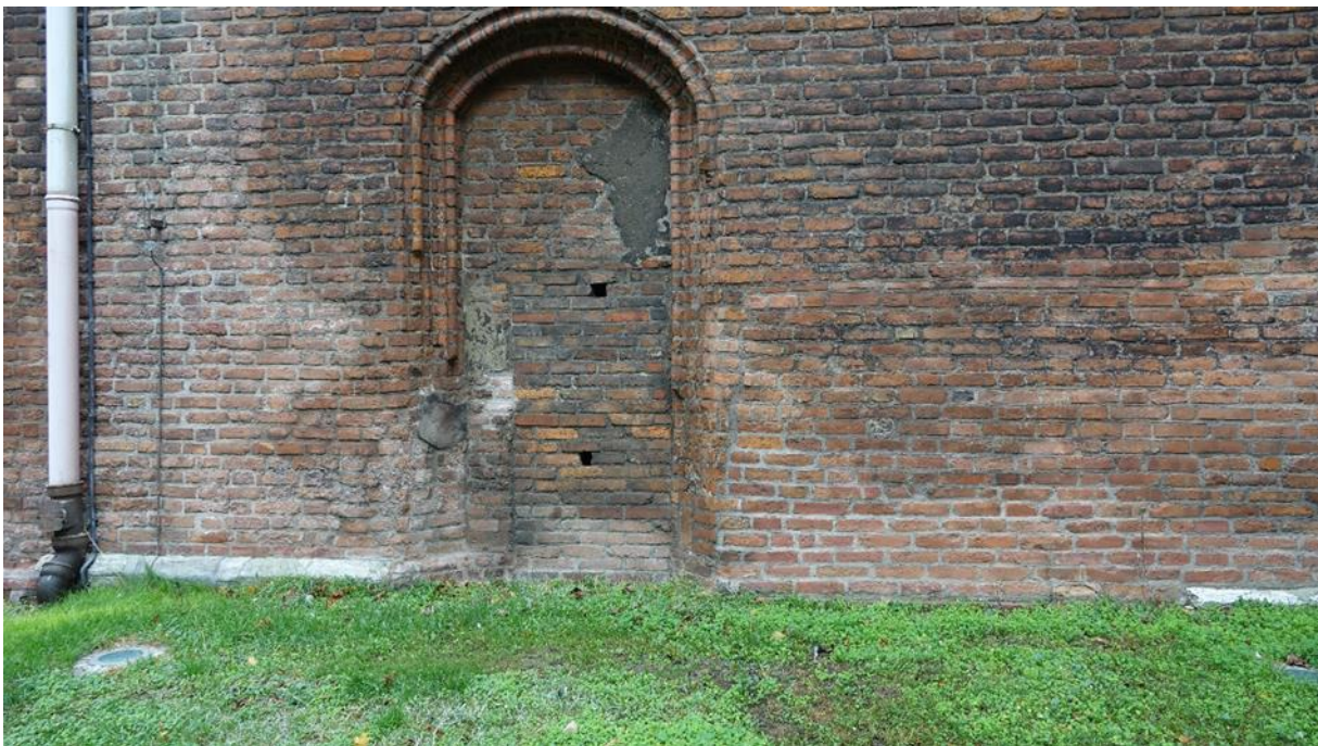
Ilustracja 10. Zawilgocone mury kościoła.
