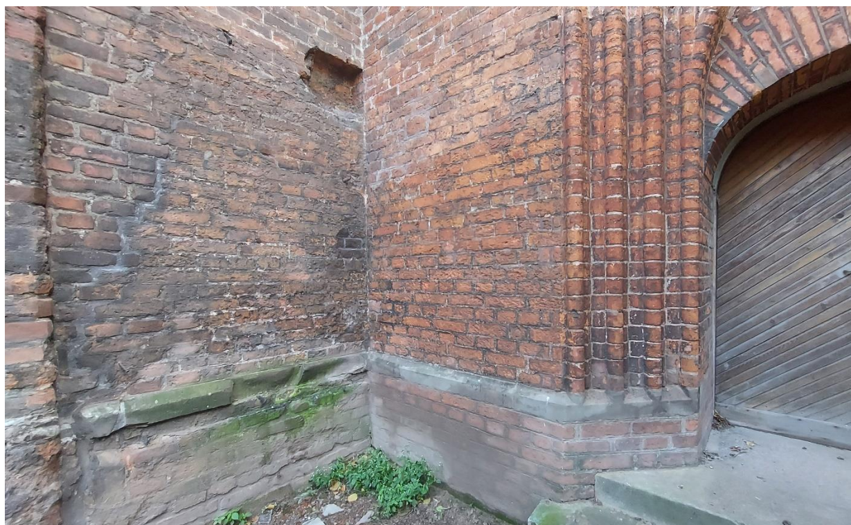
Ilustracja 16. Mur porośnięty mchem w wyniku zawilgocenia.
