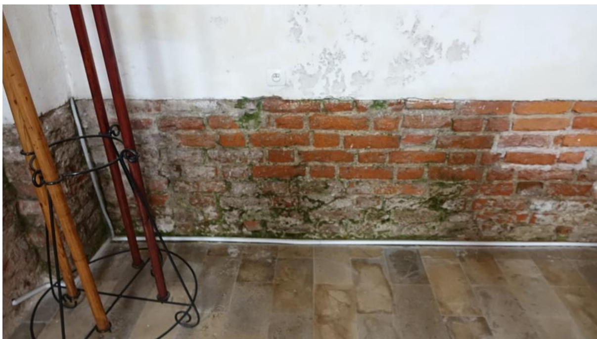
Ilustracja 15. Mur porośnięty mchem w wyniku zawilgocenia.
