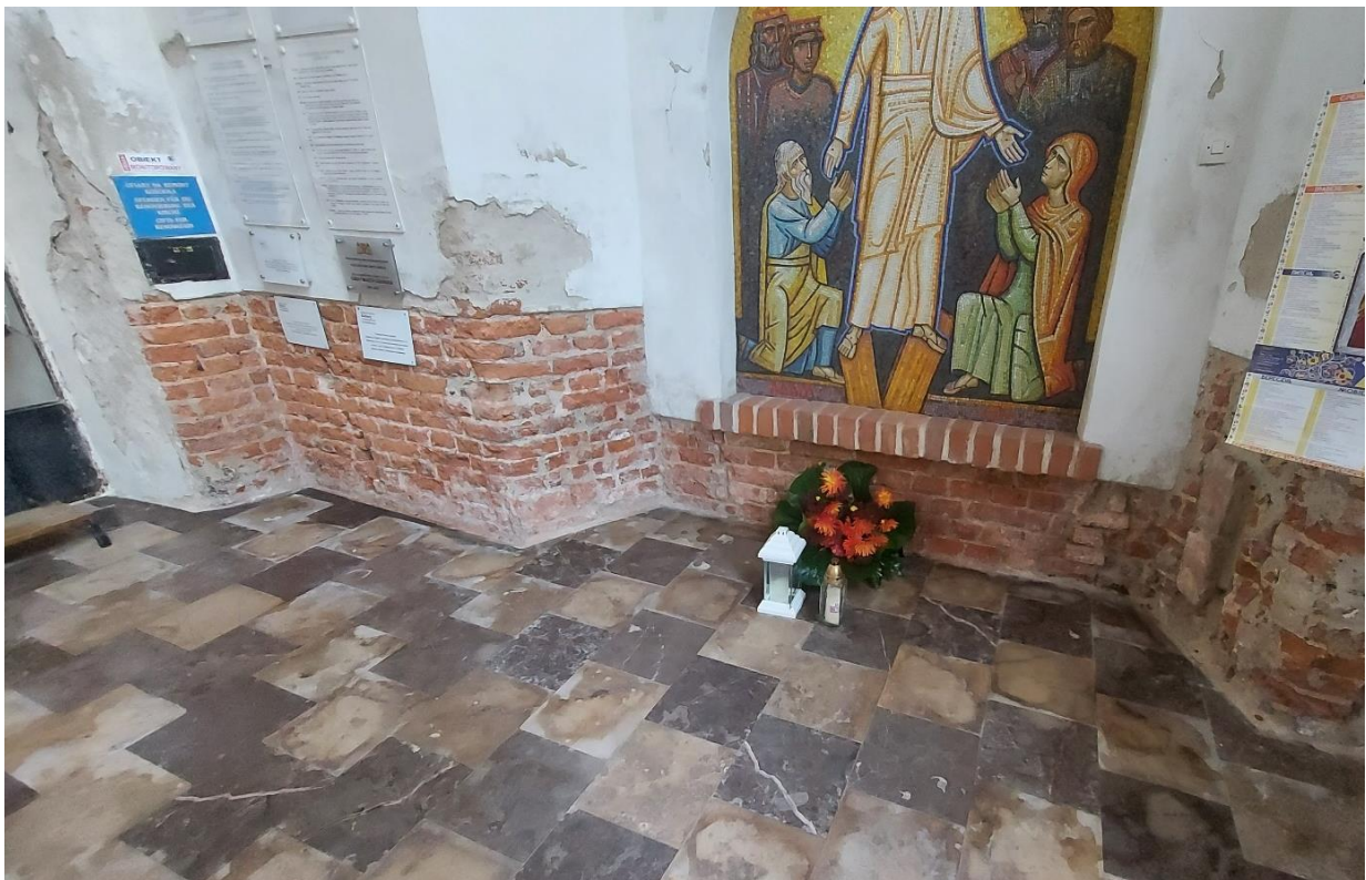
Ilustracja 12. Wnętrze kościoła. Zawilgocenie posadzki i odpajający się tynk.
