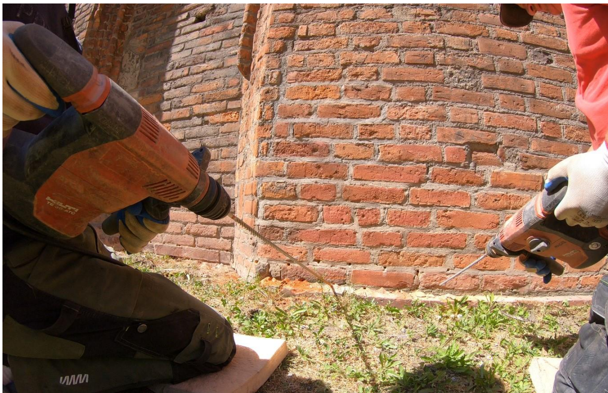
Ilustracja 18. Wykonywanie odwiertów pod iniektory. Z lewej pogłębianie otworów przy użyciu dłuższego wiertła.
