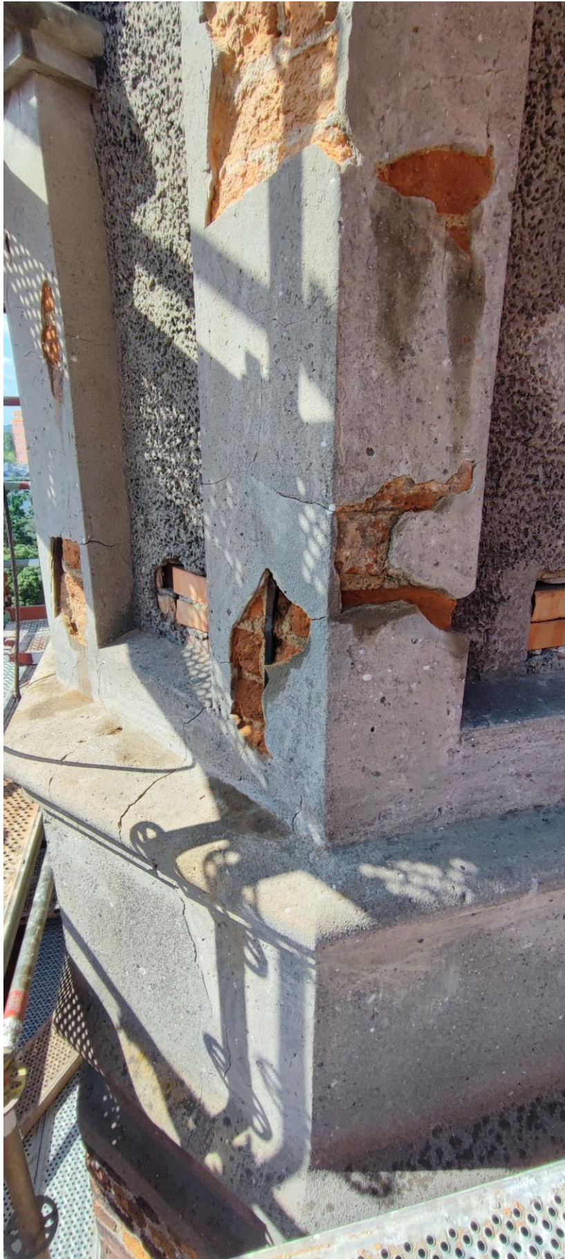
Ilustracja 21. Stan elewacji wieżyczki po usunięciu luźnych elementów, które powodowały zagrożenie.
