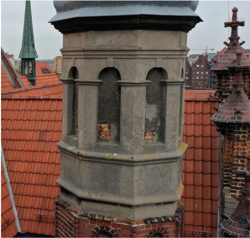
Ilustracja 18. Stan elewacji górnej części wieżyczki – ubytki i spękania tynku.
