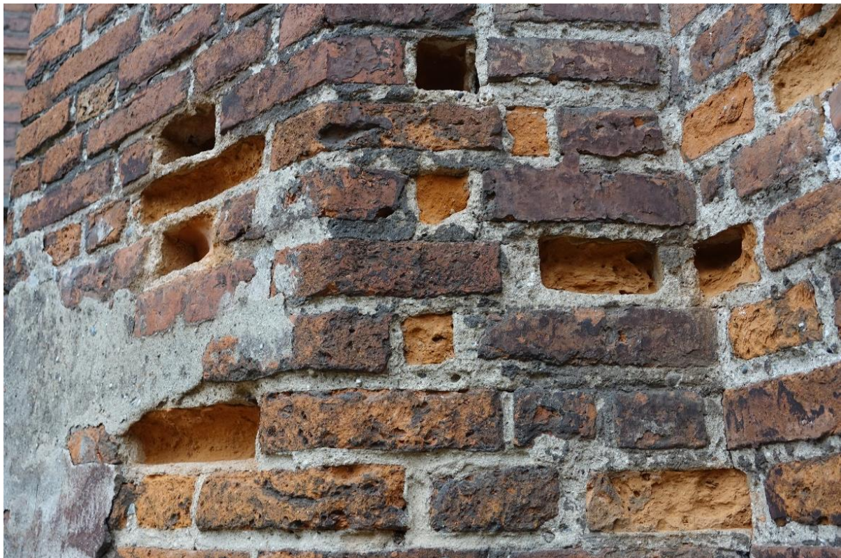
Ilustracja 13. Ubytki cegieł i zapraw elewacji wieżyczki.
