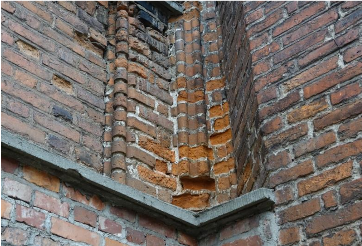
Ilustracja 14. Ubytki kształtek w narożu zachodniej ściany pseudotranseptu i południowej elewacji korpusu kościoła.
