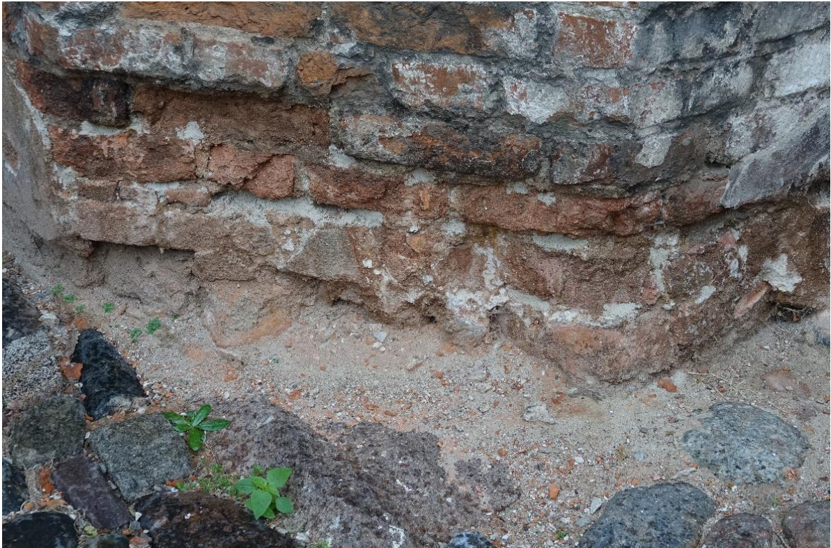
Ilustracja 12. Ubytki cegieł i zapraw w strefie fundamentowej wieżyczki.
