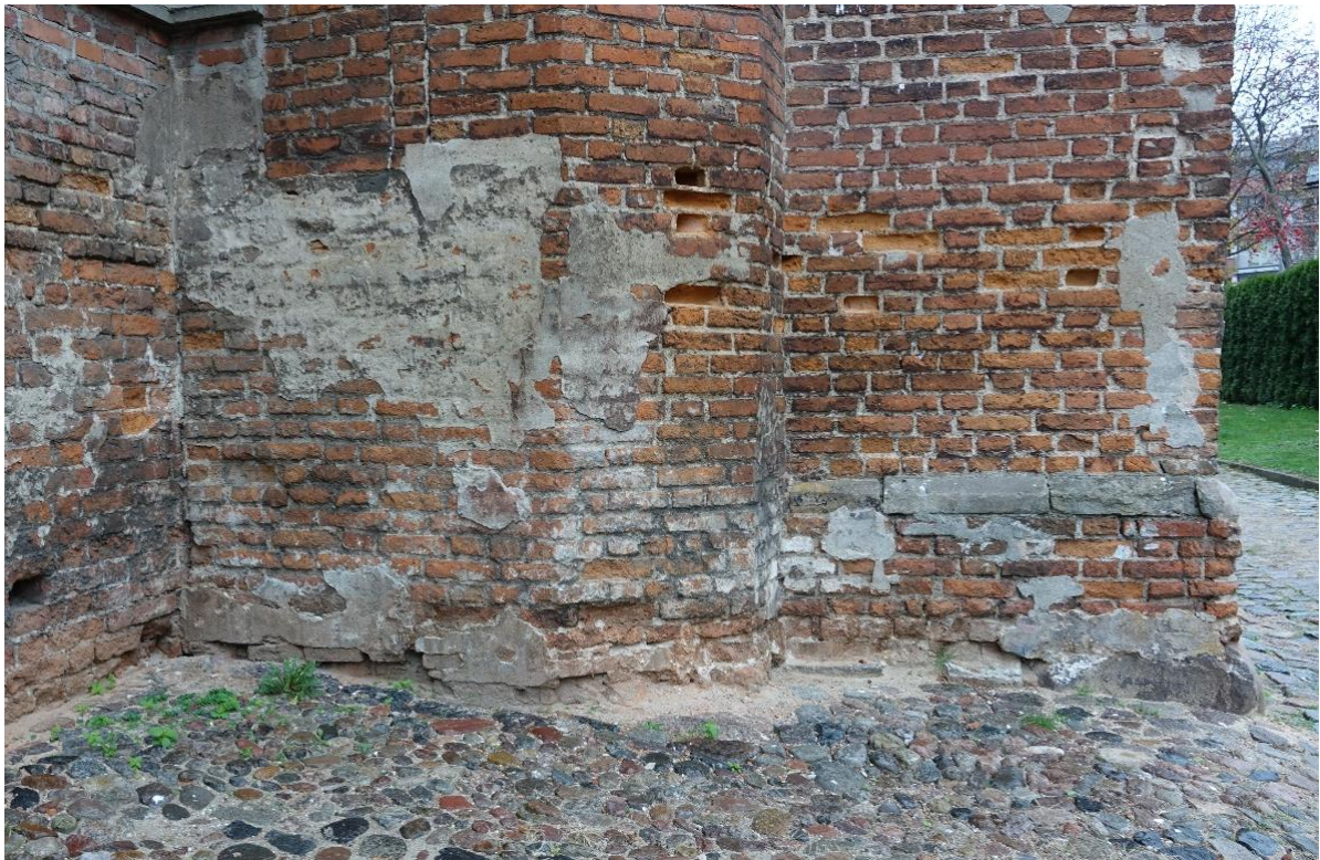
Ilustracja 10. Stan elewacji w strefie przyziemia.
