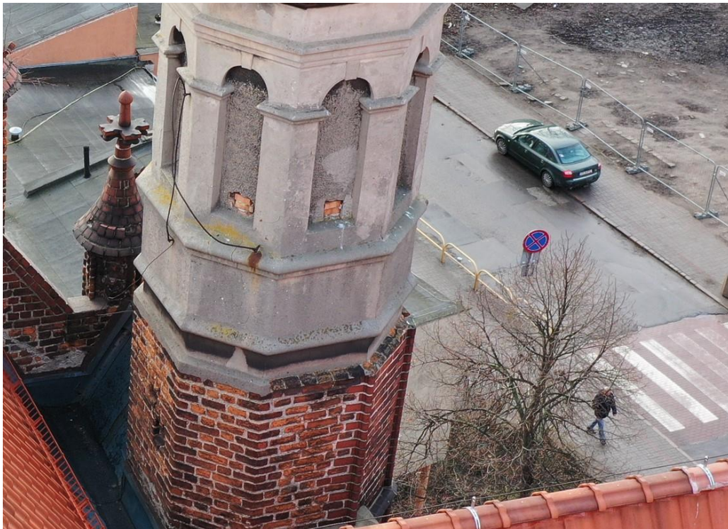
Ilustracja 19. Stan elewacji wieżyczki od strony północno-wschodniej.
