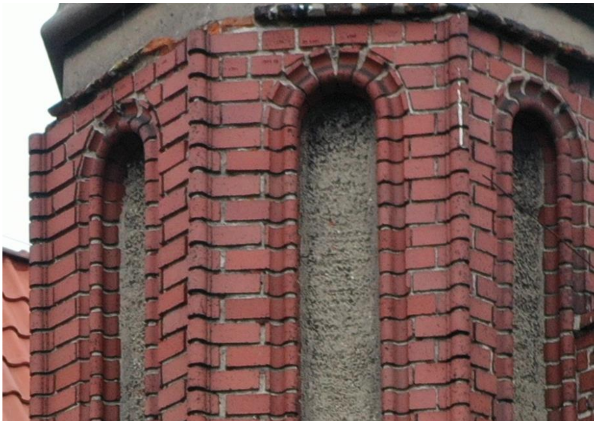
Ilustracja 17. Ubytki kształtek w wałku wieńczącym elewację wieżyczki.
