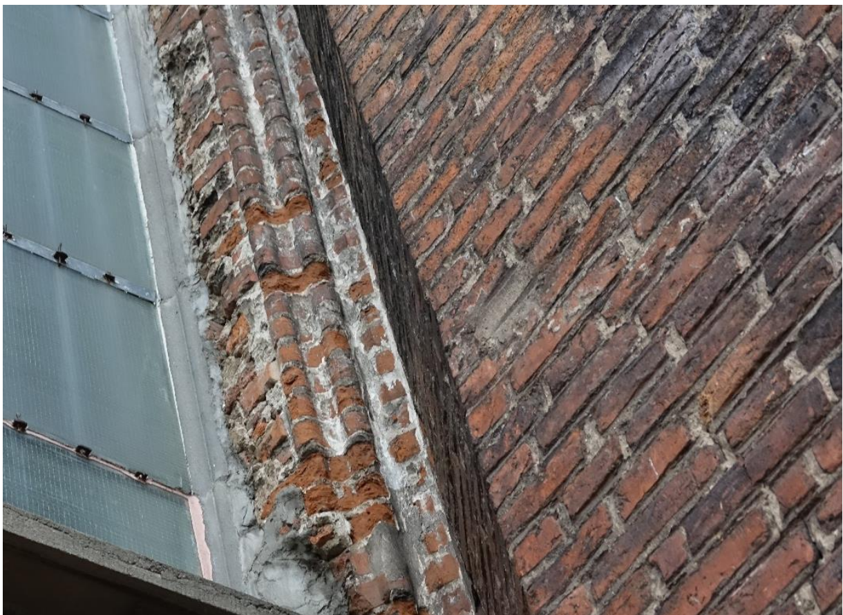
Ilustracja 15. Ubytki kształtek w narożu zachodniej ściany pseudotranseptu i południowej elewacji korpusu kościoła.
