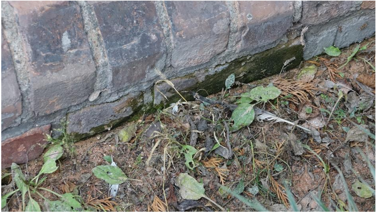
Ilustracja 21. Zawilgocenie strefy przyziemia
