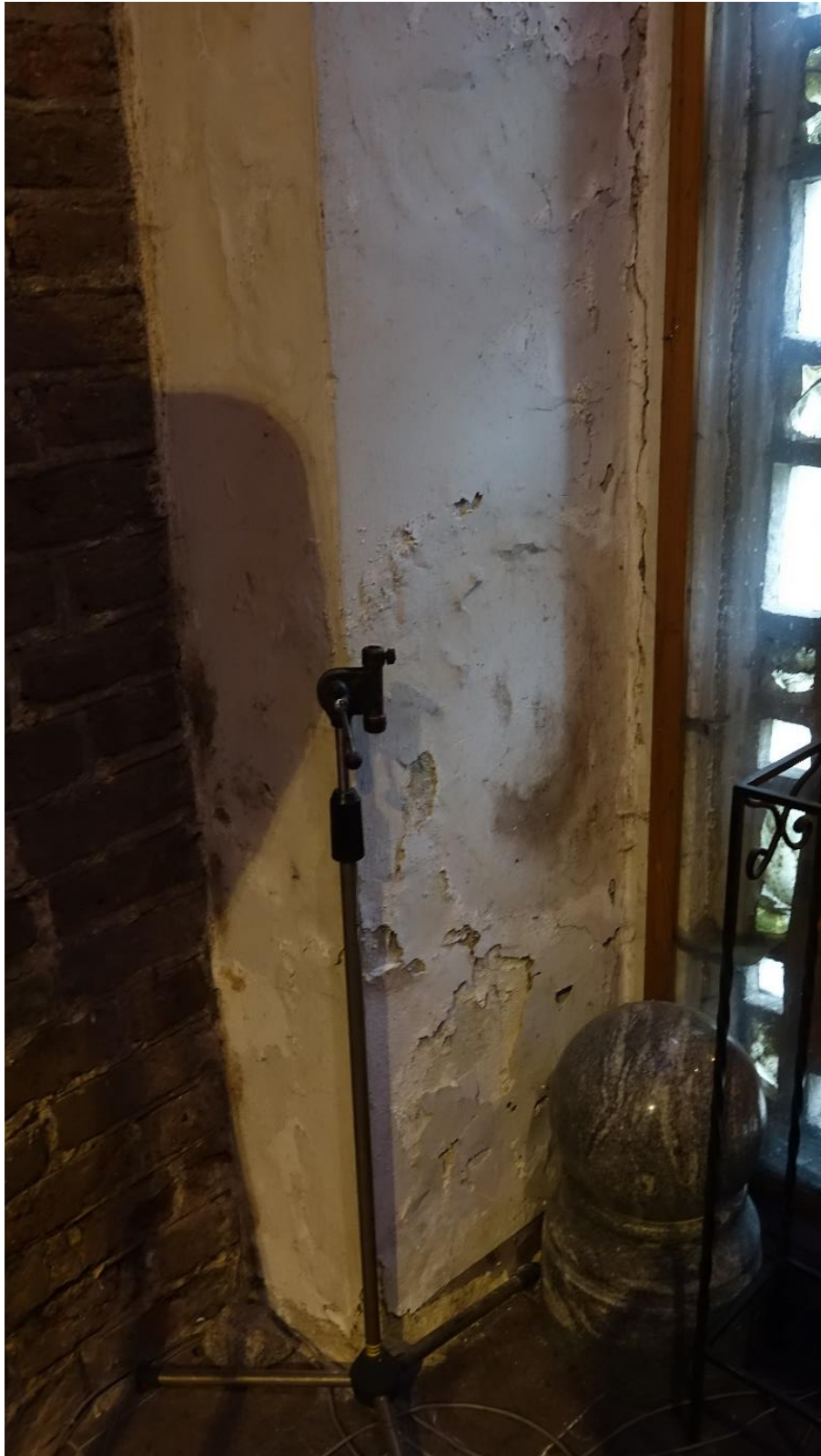
Ilustracja 25. Skutki zawilgocenia: plamy wilgoci i odspajający się tynk
