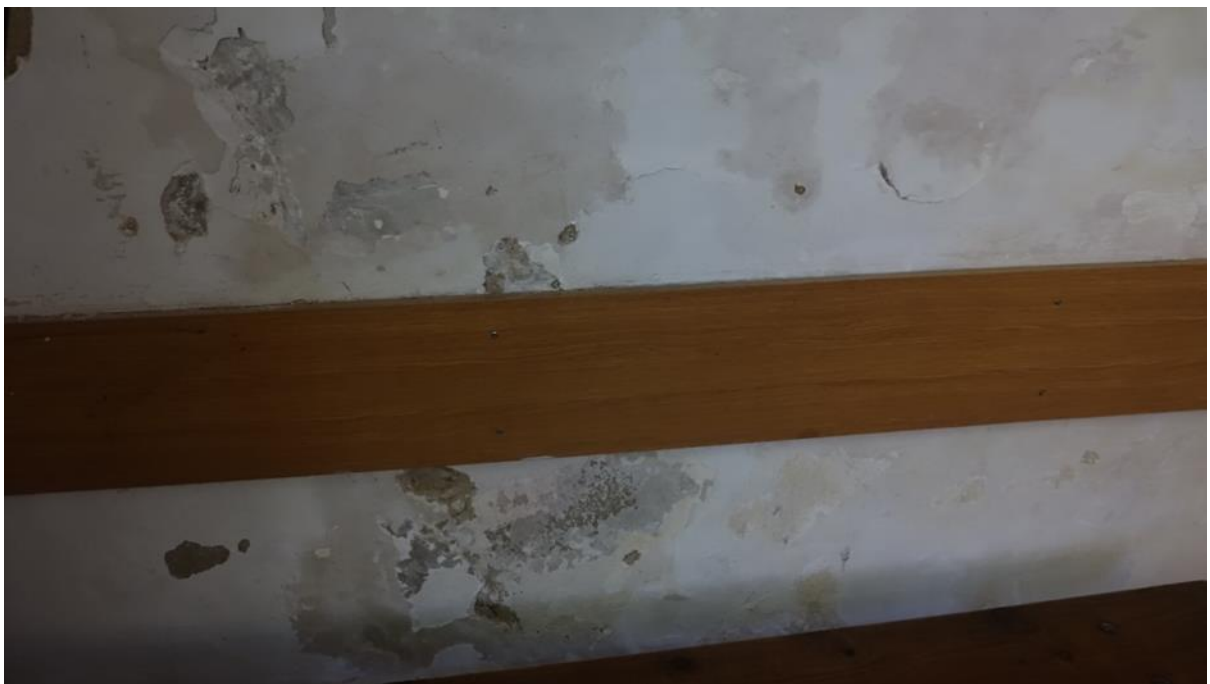
Ilustracja 22. Skutki zawilgocenia: plamy wilgoci i odspajający się tynk
