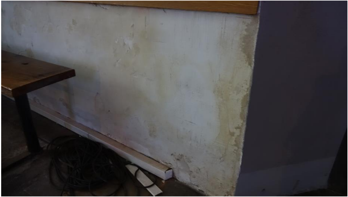
Ilustracja 23. Skutki zawilgocenia: plamy wilgoci i odspajający się tynk
