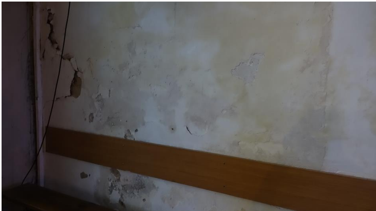
Ilustracja 24. Skutki zawilgocenia: plamy wilgoci i odspajający się tynk
