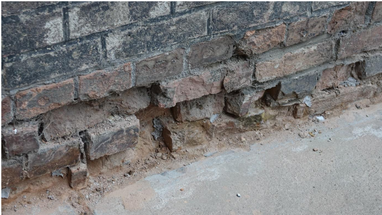
Ilustracja 26. Zniszczenia w partii przyziemia wieży
