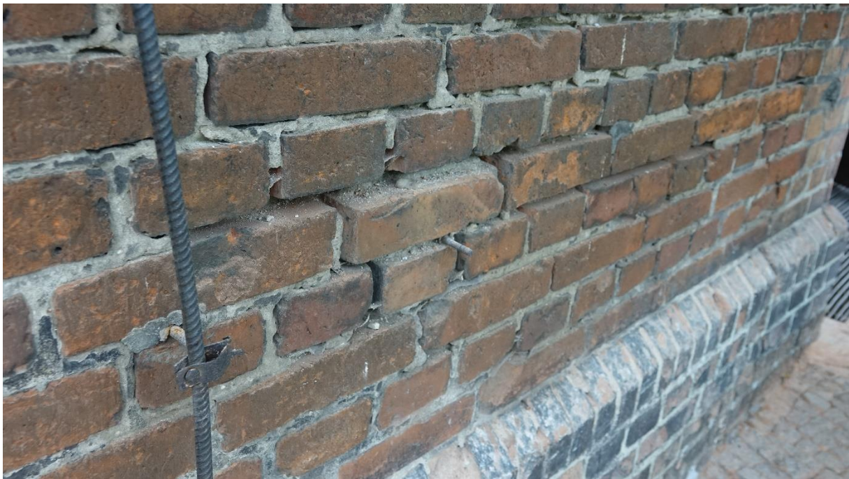
Ilustracja 27. Ubytki zapraw w spoinach w strefie przyziemia
