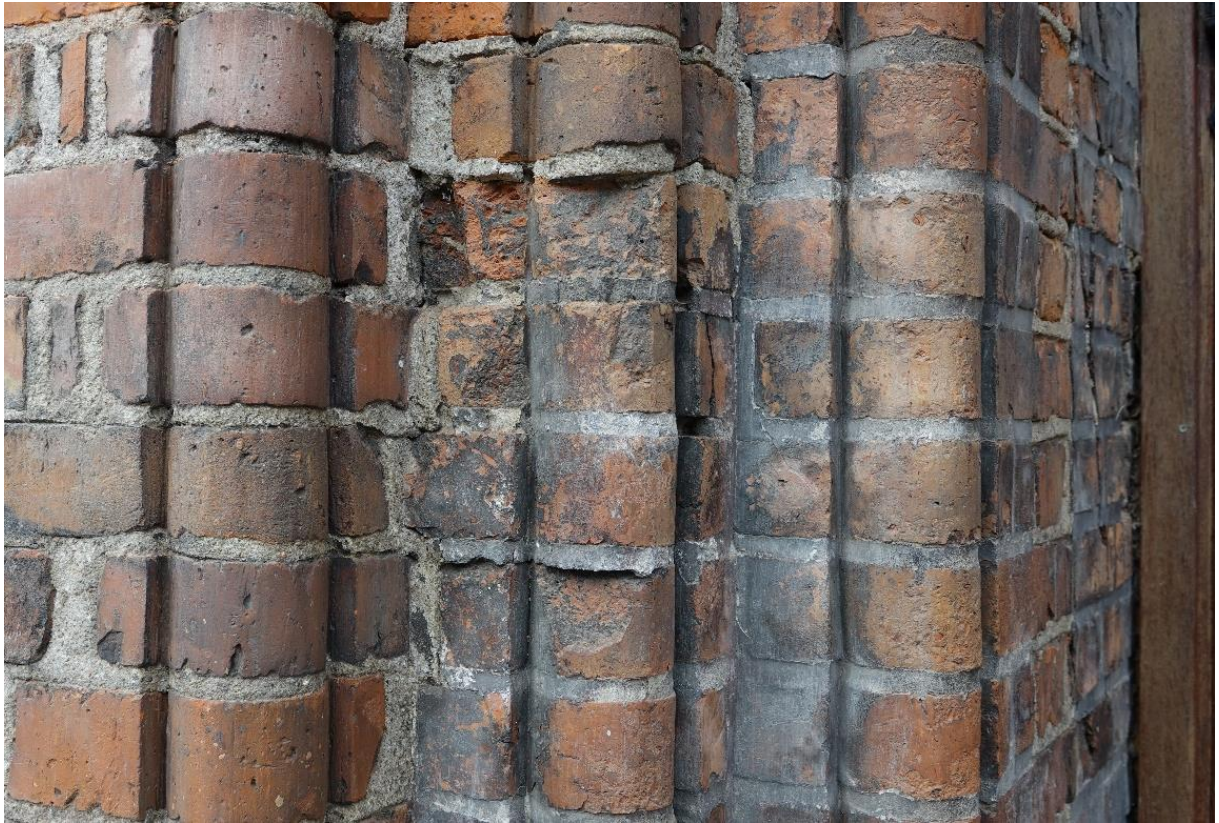
Ilustracja 20. Uszkodzenia cegieł i zapraw
