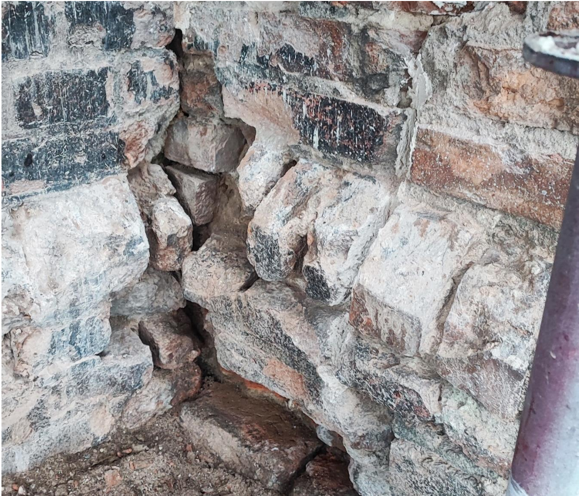
Ilustracja 53. Pęknięcie pomiędzy południową elewacją wieży o ścianą zachodnią korpusu kościoła
