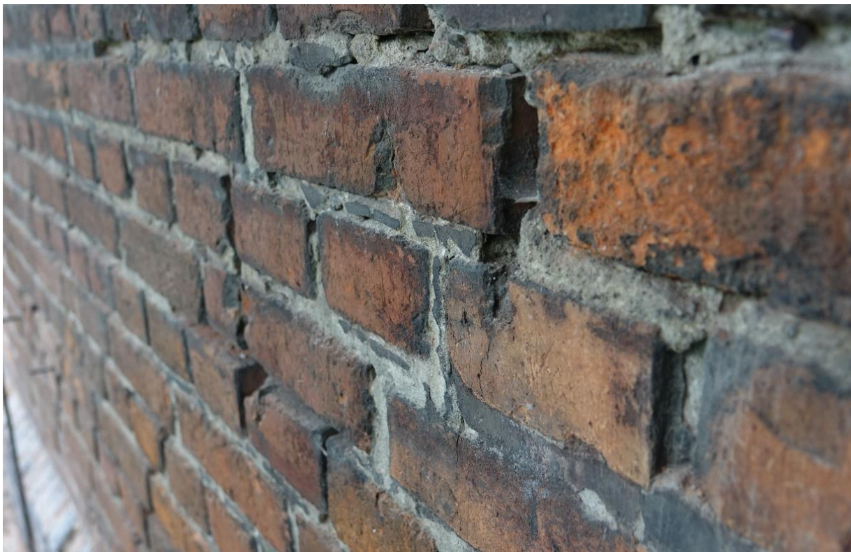
Ilustracja 21. Uszkodzenia cegieł i ubytki zapraw
