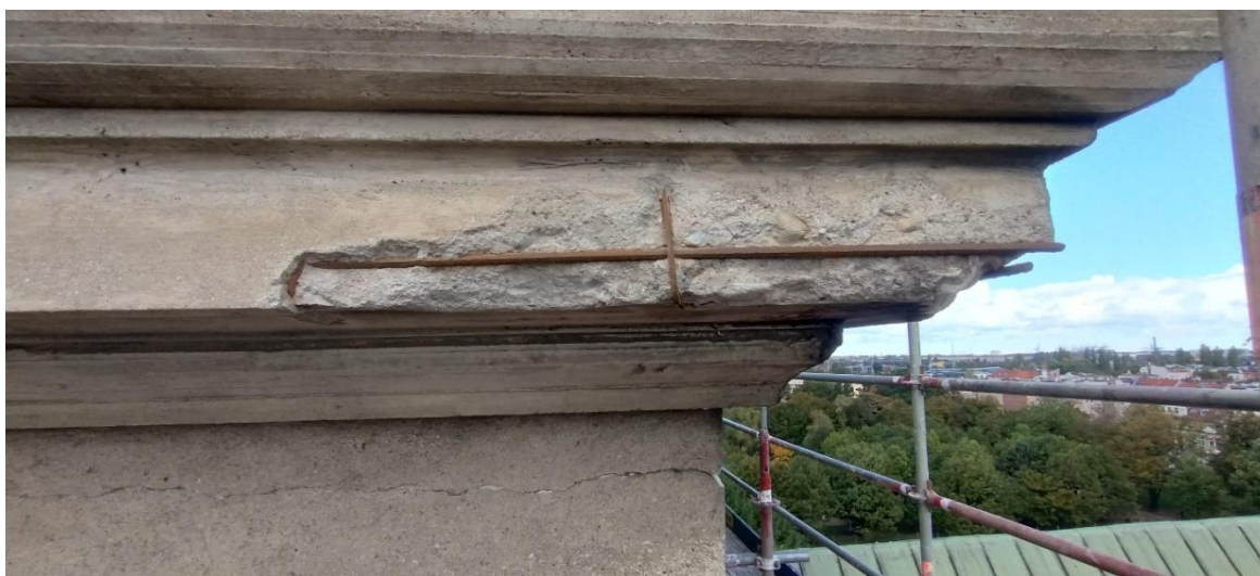
Ilustracja 28. Gzyms po zdemontowaniu luźnych elementów
