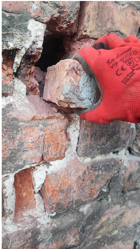
Ilustracja 37. Demontaż luźnych elementów, które powodowały zagrożenie
