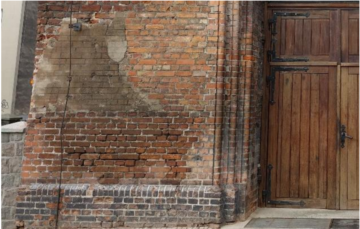
Ilustracja 16. Betonowe uzupełnienia w cegle z okresu powojennych prac konserwatorskich
