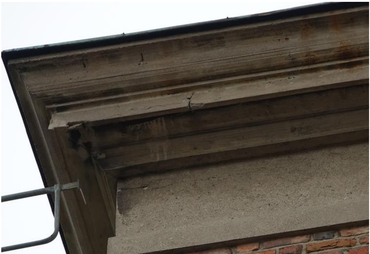
Ilustracja 13. Ubytki i pęknięcia gzymsu
