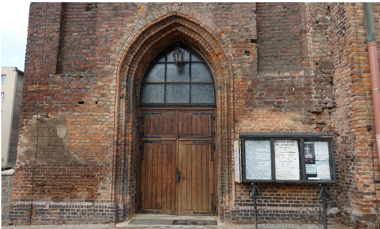
Ilustracja 15. Zniszczenia elewacji w dolnej partii wieży
