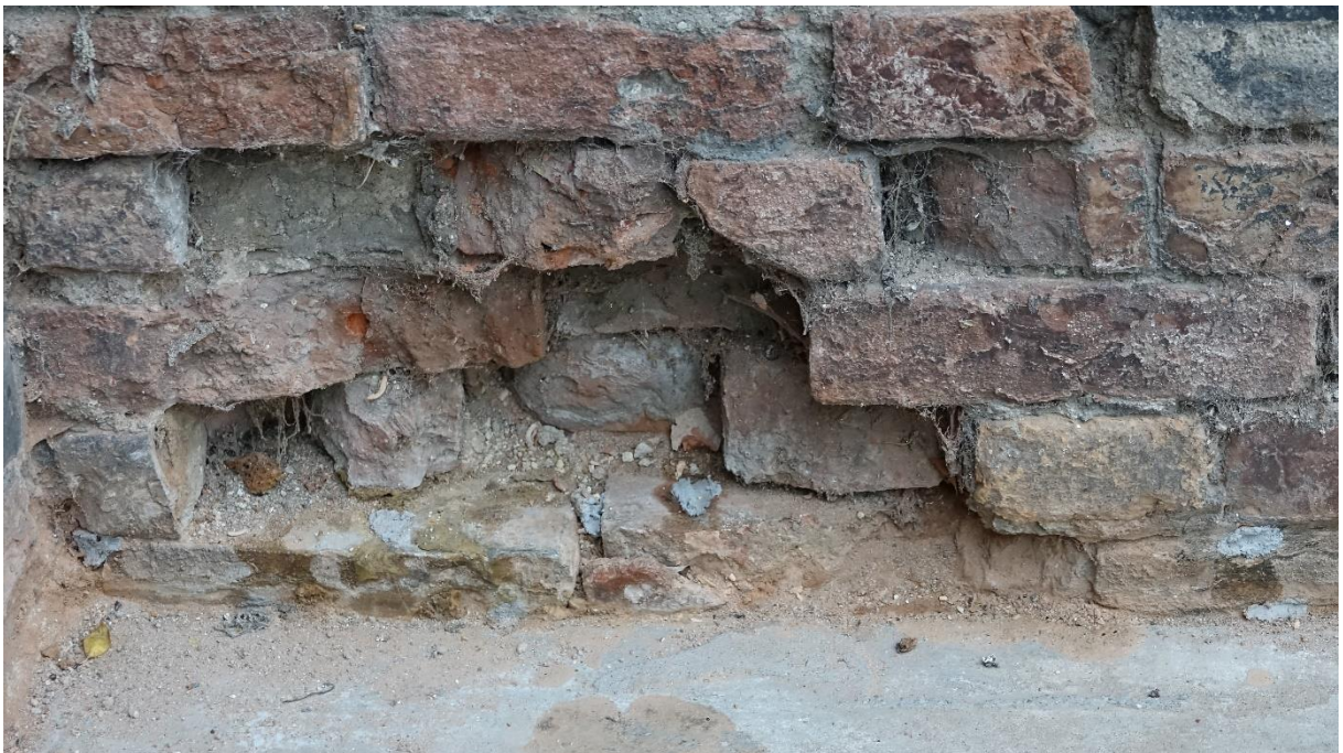
Ilustracja 25. Zniszczenia w partii przyziemia wieży
