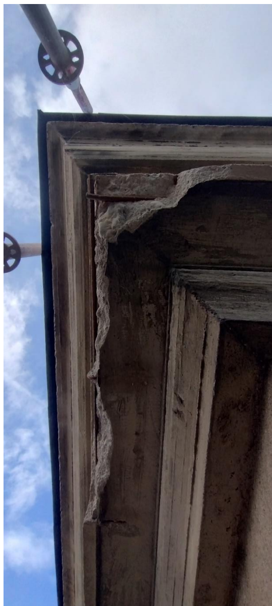
Ilustracja 31. Gzyms po zdemontowaniu luźnych elementów
