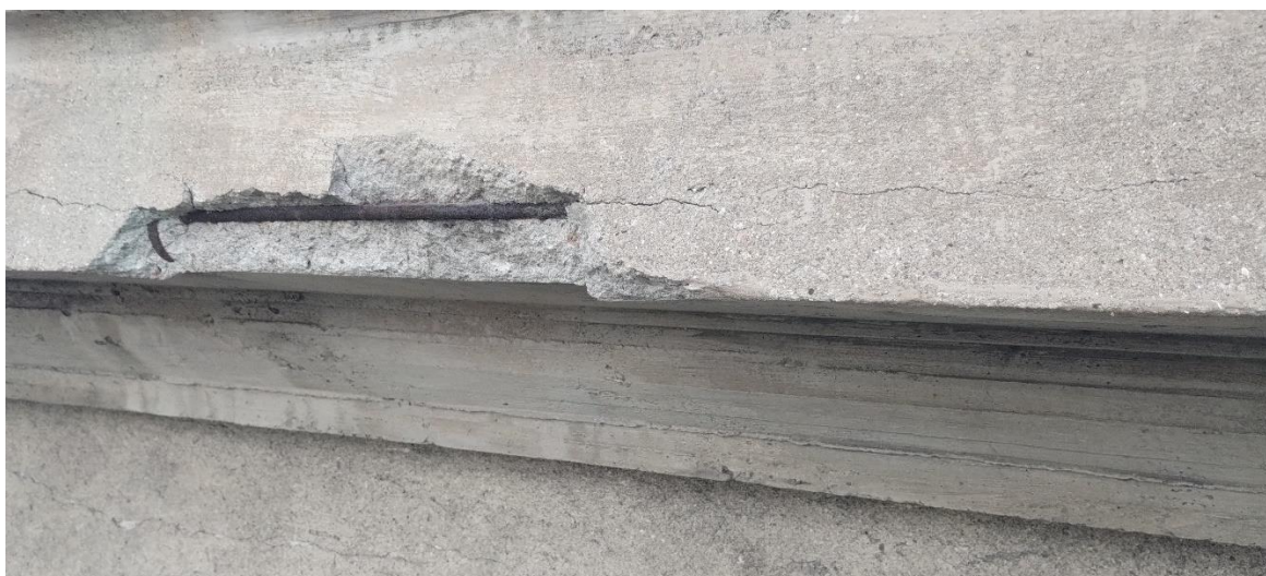
Ilustracja 29. Gzyms po zdemontowaniu luźnych elementów
