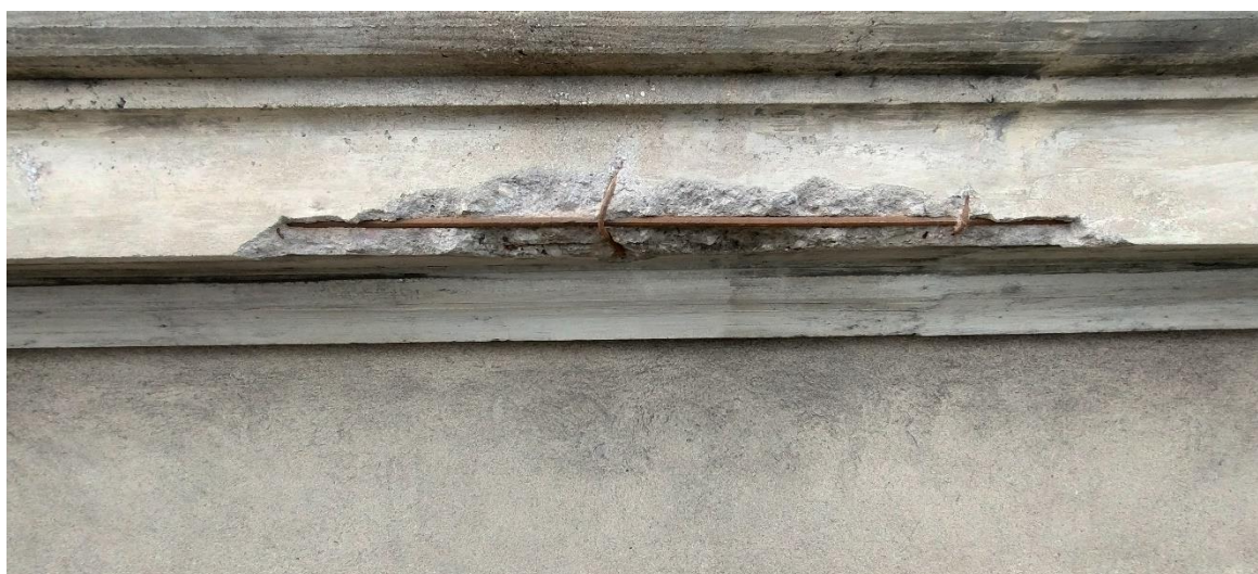
Ilustracja 30. Gzyms po zdemontowaniu luźnych elementów
