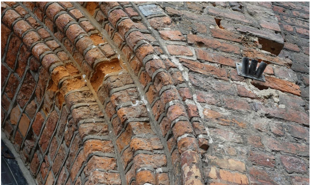
Ilustracja 17. Uszkodzenia i ubytki cegieł
