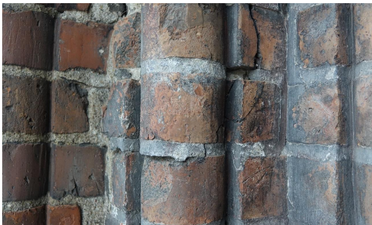
Ilustracja 19. Uszkodzenia cegieł i zapraw
