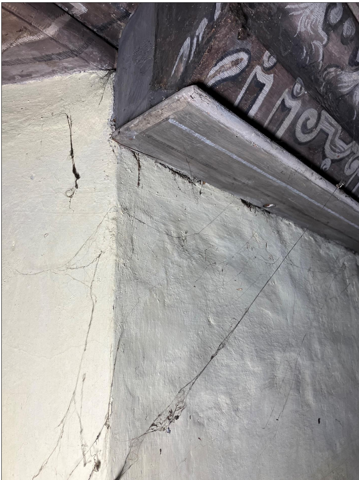
Fot. 19. Fragment ściany z gzymsem przed pracami konserwatorskimi.
