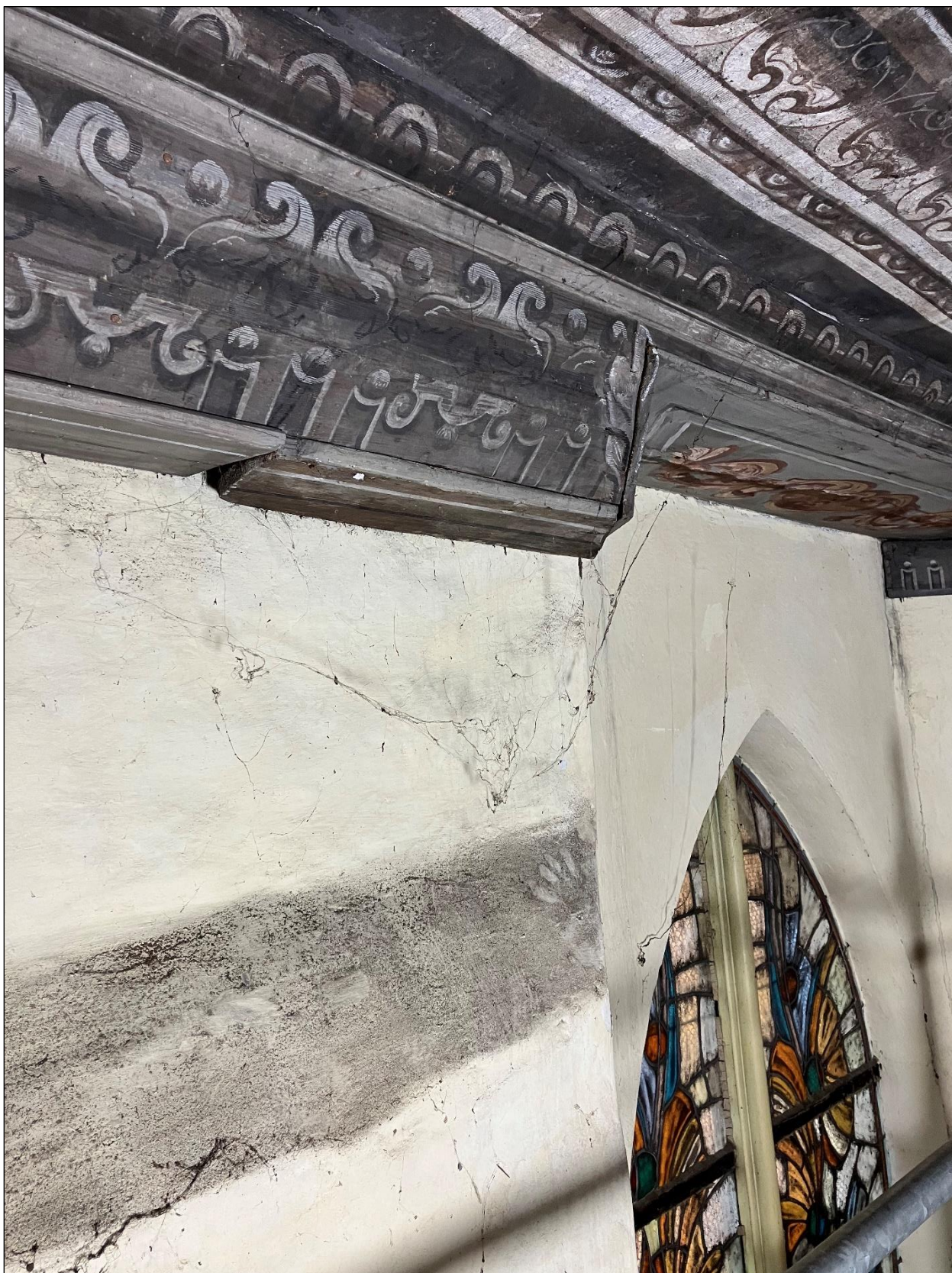
Fot. 18. Fragment ściany z gzymsem przed przeprowadzeniem prac w 2023 r.
