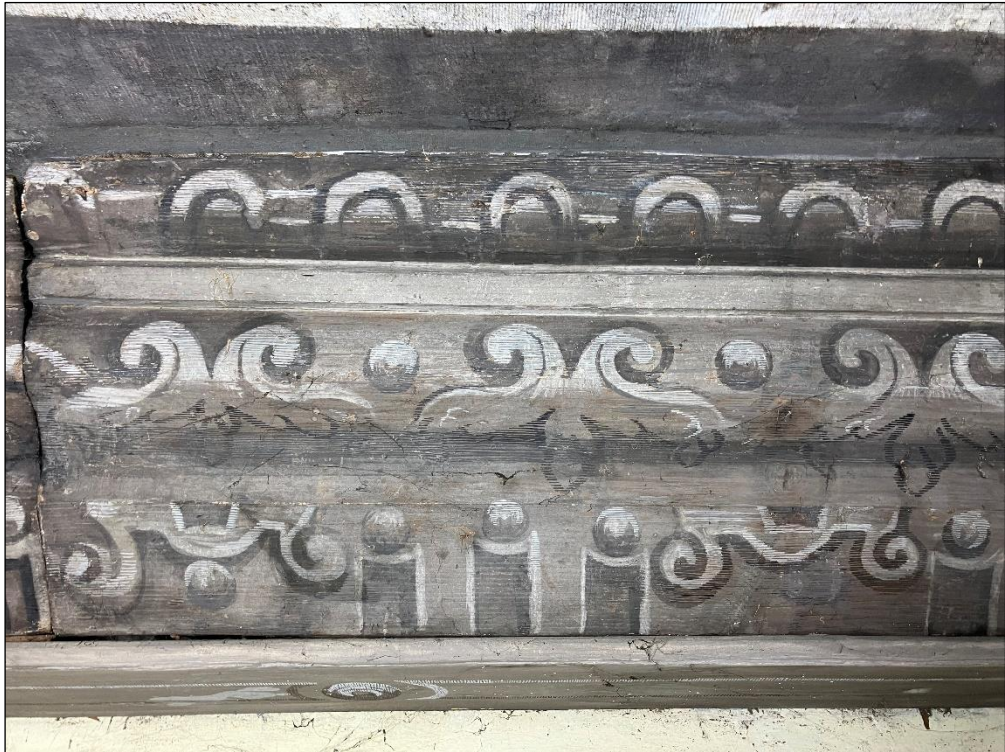
Fot. 23. Fragment gzymsu przed pracami, odspojenia warstwy malarskiej.
