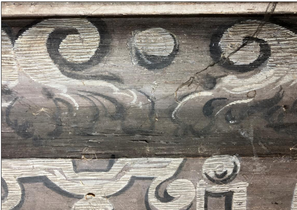
Fot. 24. Fragment gzymsu przed pracami. Ubytki warstwy malarskiej.
