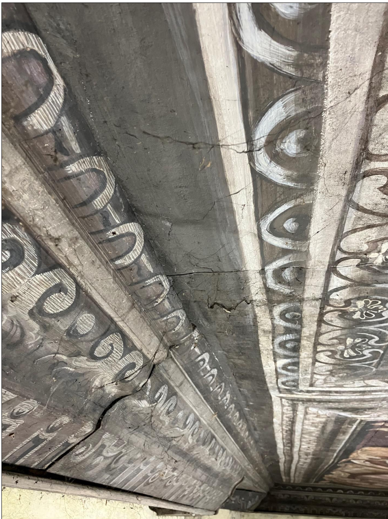
Fot. 20. Fragment gzymsu przed pracami, widoczne ubytki warstwy malarskiej.
