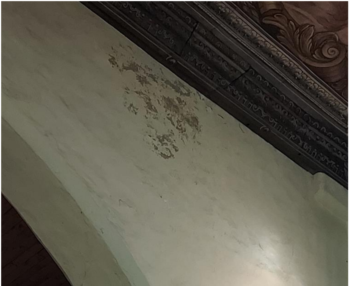
Ilustracja 23. Zacieki i odpajający się tynk
