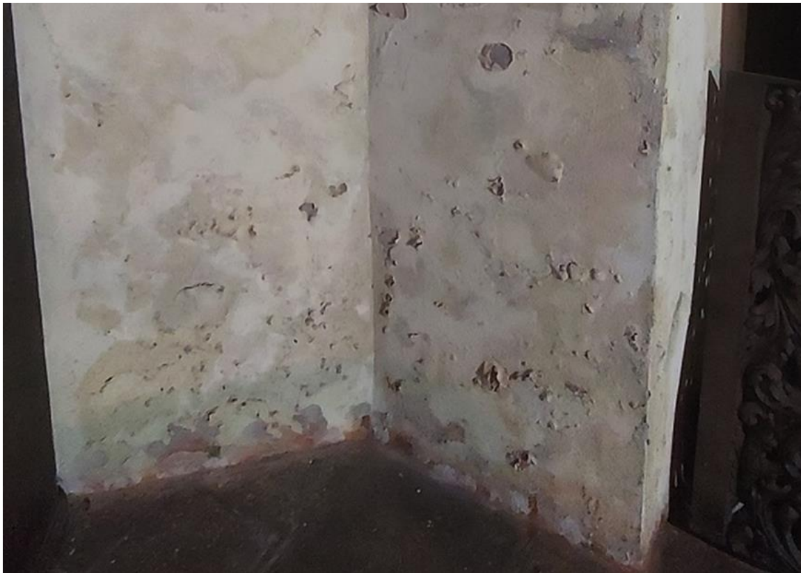
Ilustracja 19. Wnętrze kościoła. Zacieki i tynki odspajające się od ścian w wyniku zawilgocenia murów
