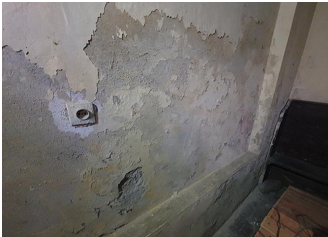
Ilustracja 20. Tynki odspajające się od ścian w wyniku zawilgocenia murów
