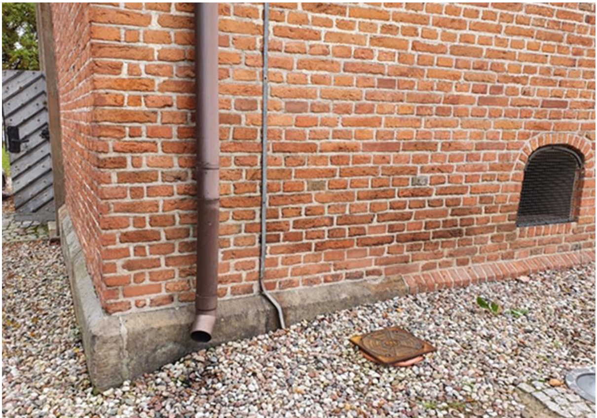
Ilustracja 16. Zawilgocona ściana kościoła w części północno-zachodniej
