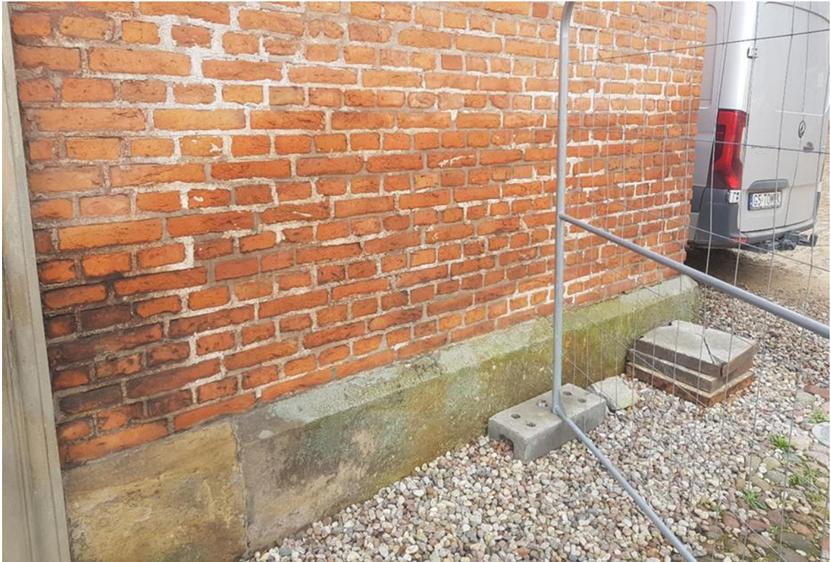
Ilustracja 17. Zawilgocona ściana kościoła
