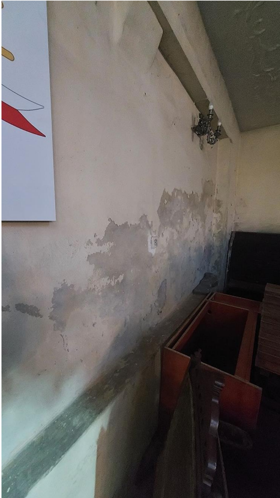
Ilustracja 22. Tynki odpajające się od ścian w wyniku zawilgocenia murów
