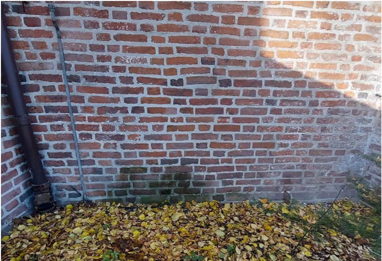
Ilustracja 18. Zawilgocona ściana kościoła
