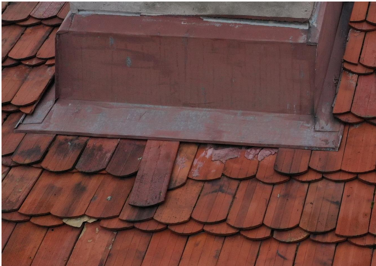
Ilustracja 16. Połączenie skrzydła zachodniego – uszkodzenia pokrycia dachu.
