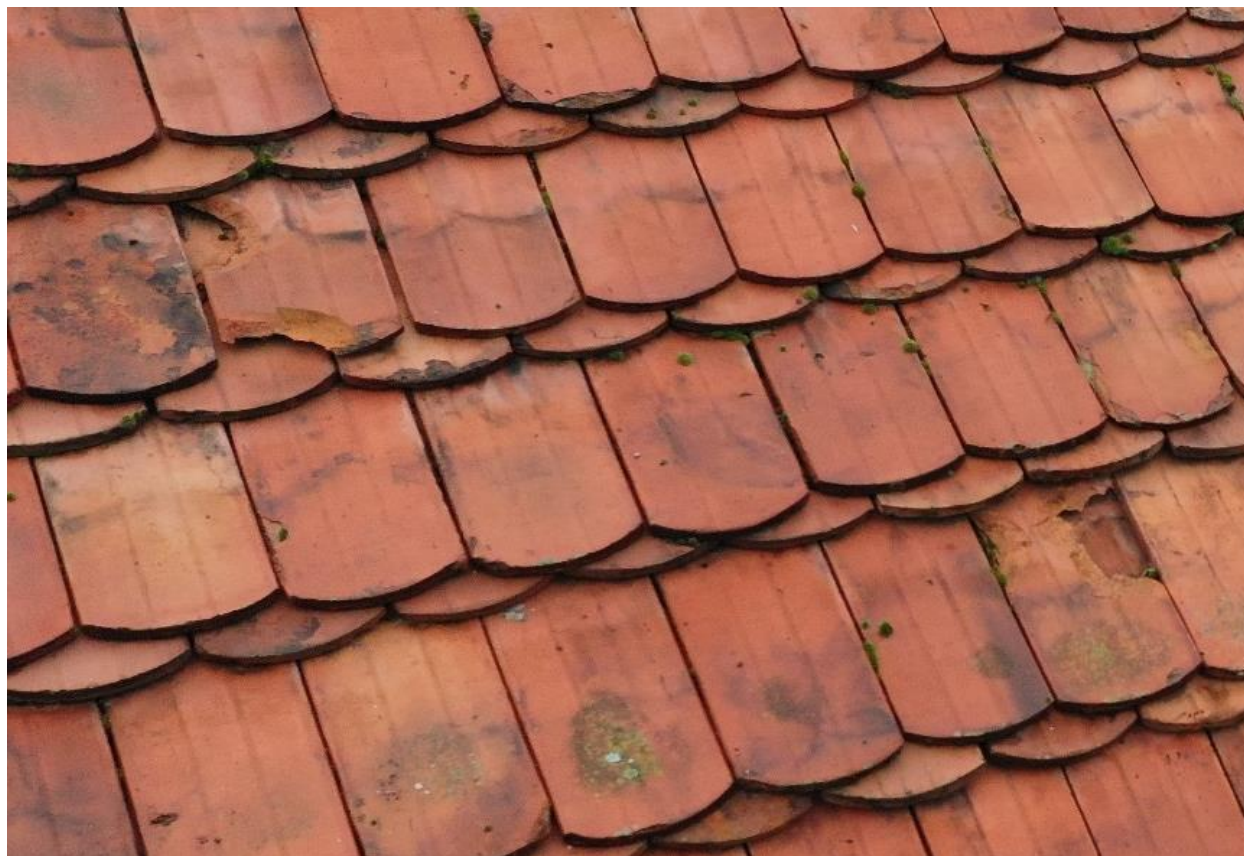
Ilustracja 12. Połać wschodnia skrzydła zachodniego – uszkodzone dachówki.
