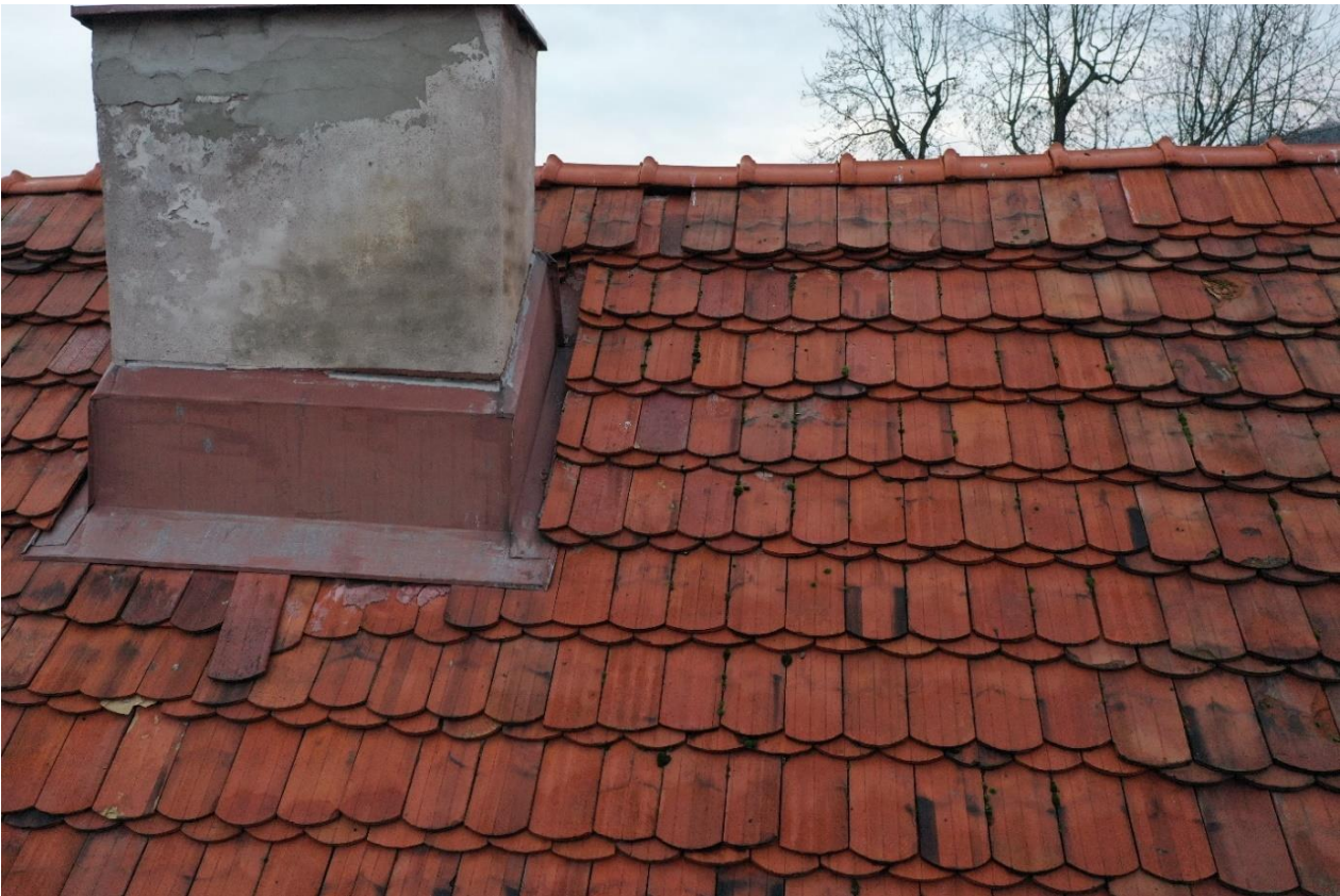
Ilustracja 15. Połąc wschodnia skrzydła zachodniego – uszkodzenia pokrycia dachu.
