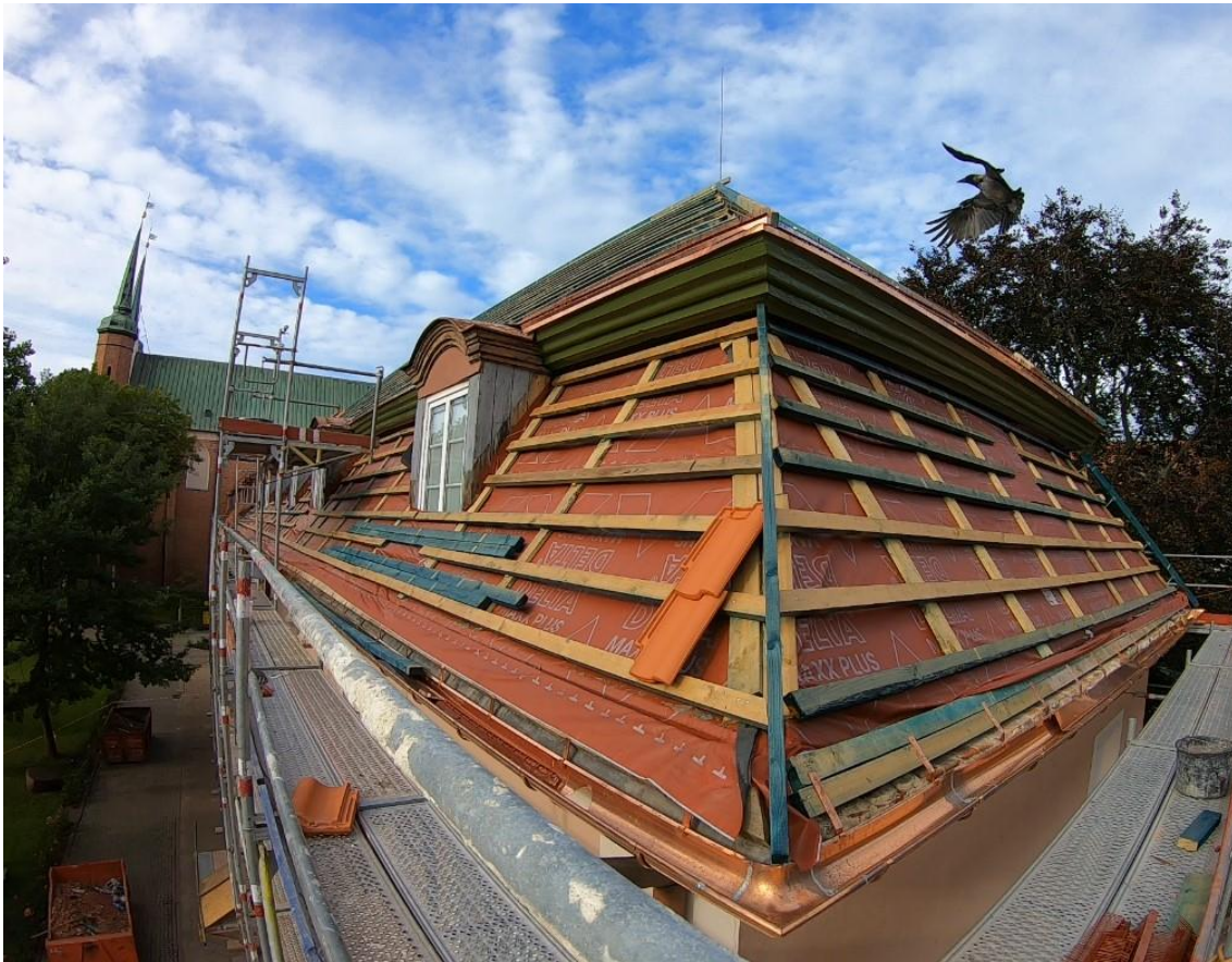
Ilustracja 25. Połacie południowa skrzydła zachodniego. Stan po zamontowaniu łączenia, rynien miedzianych oraz obróbek blacharskich.
