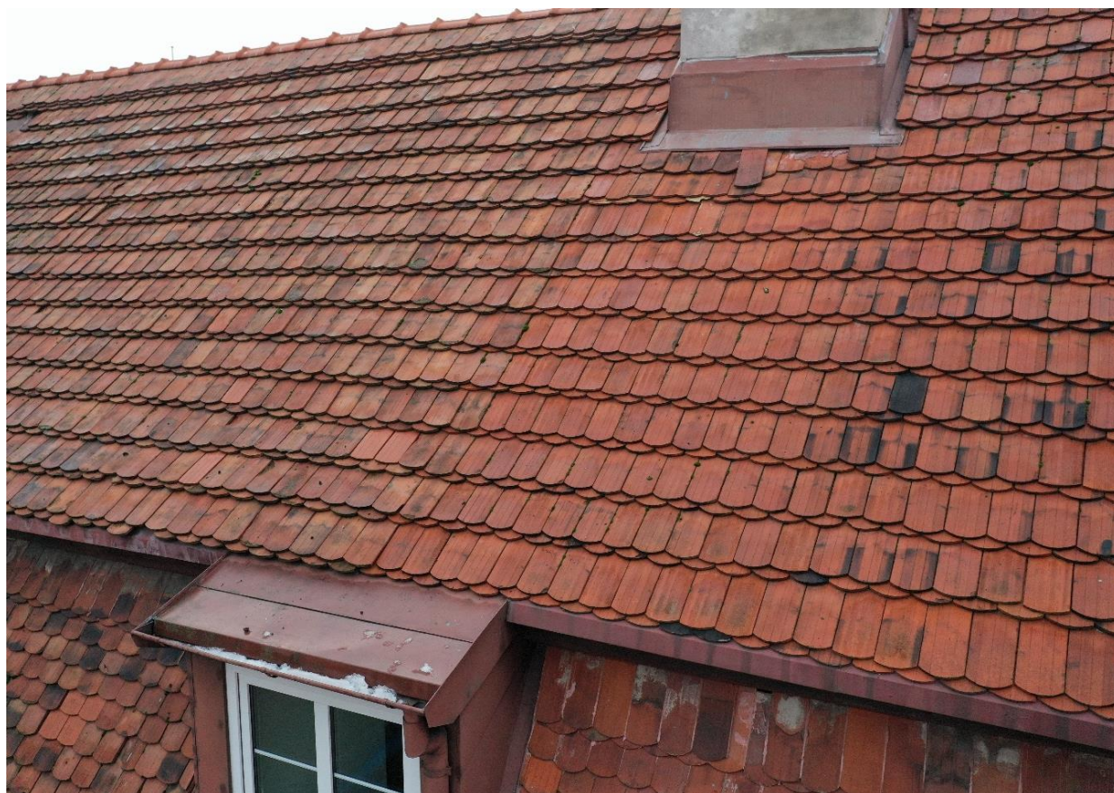
Ilustracja 13. Połać wschodnia skrzydła zachodniego – uszkodzone dachówki.
