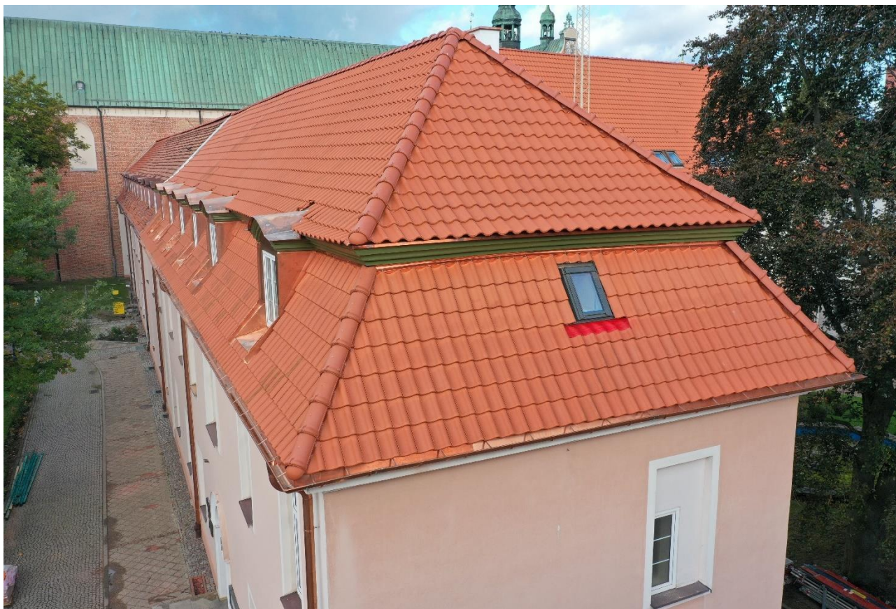
Ilustracja 43. Połączenie południowej skrzydła zachodniego. Pod oknem widoczna ołowiana taśma tymczasowo zabezpieczająca dachówki przed planowanymi pracami termomodernizacyjnymi, wiążącymi się m.in. z wymianą okna.
