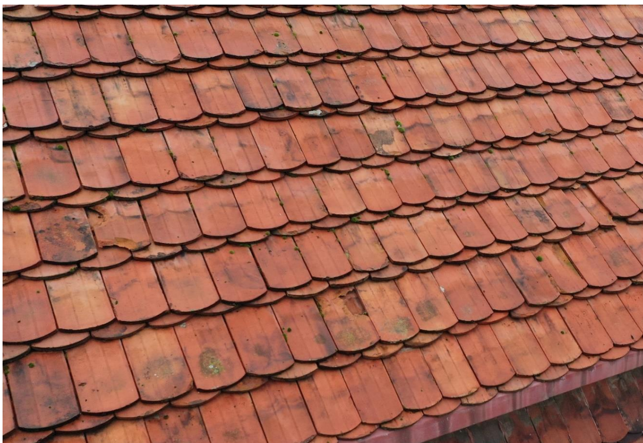
Ilustracja 11. Połąć wschodnia skrzydła zachodniego – uszkodzone dachówki.
