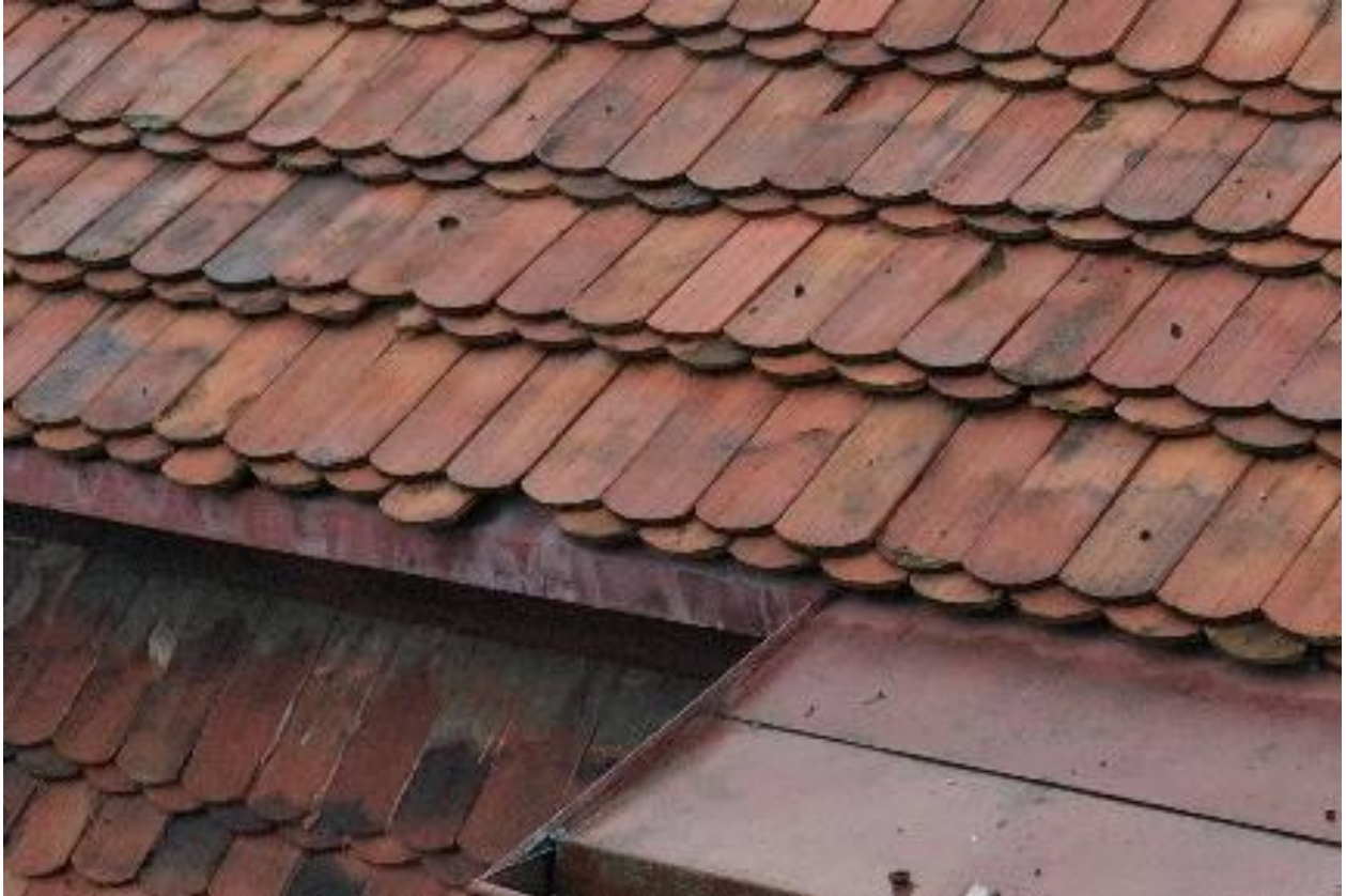
Ilustracja 14. Połąc wschodnia skrzydła zachodniego – uszkodzone dachówki.
