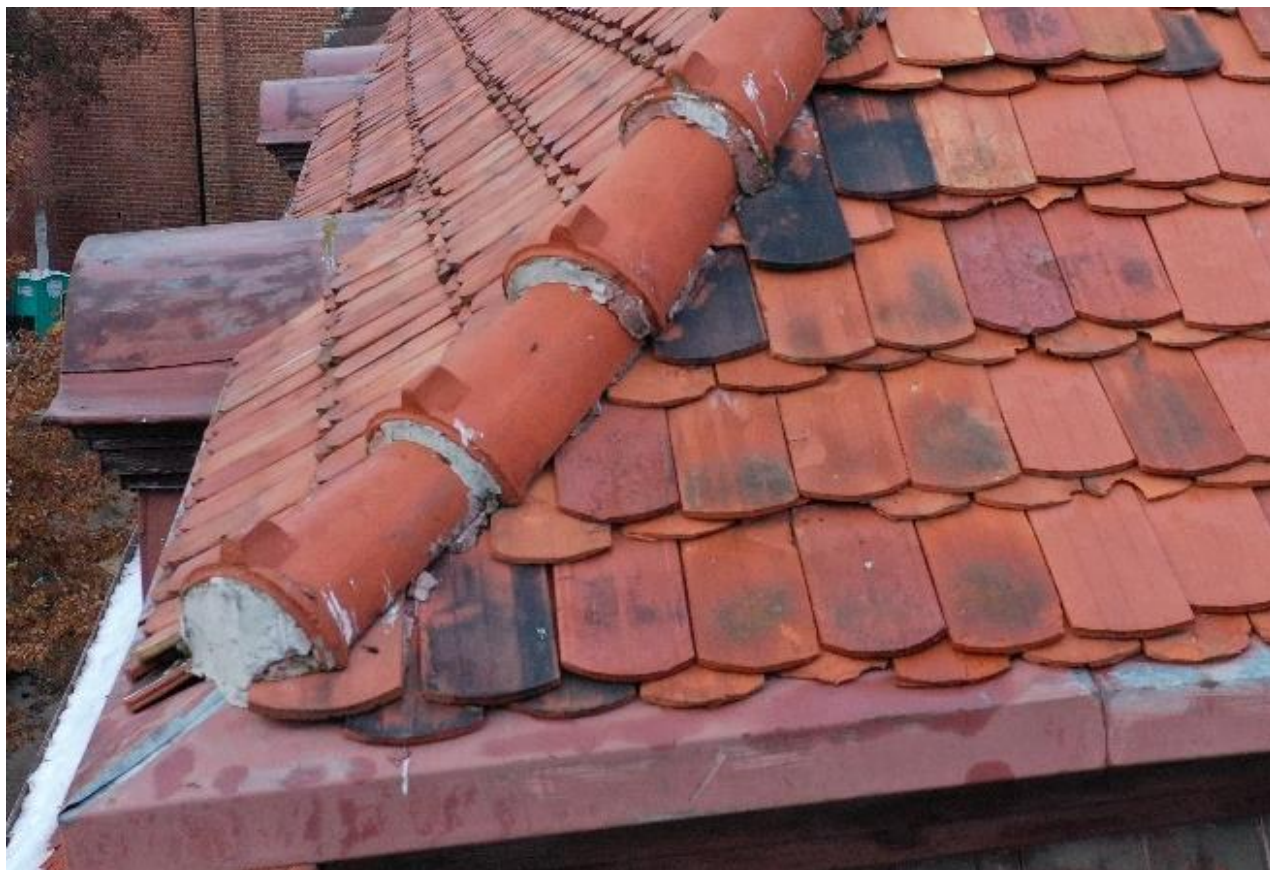
Ilustracja 10. Połąć południowa skrzydła zachodniego – uszkodzone dachówki.
