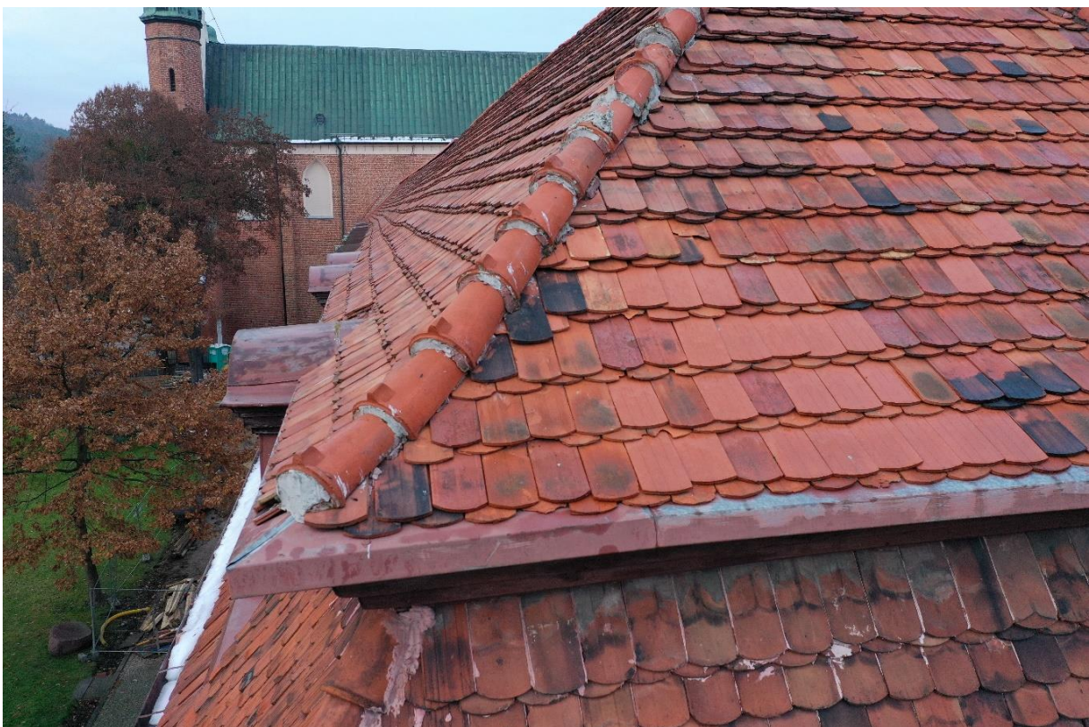
Ilustracja 9. Połąc południowa skrzydła zachodniego – uszkodzone dachówki.
