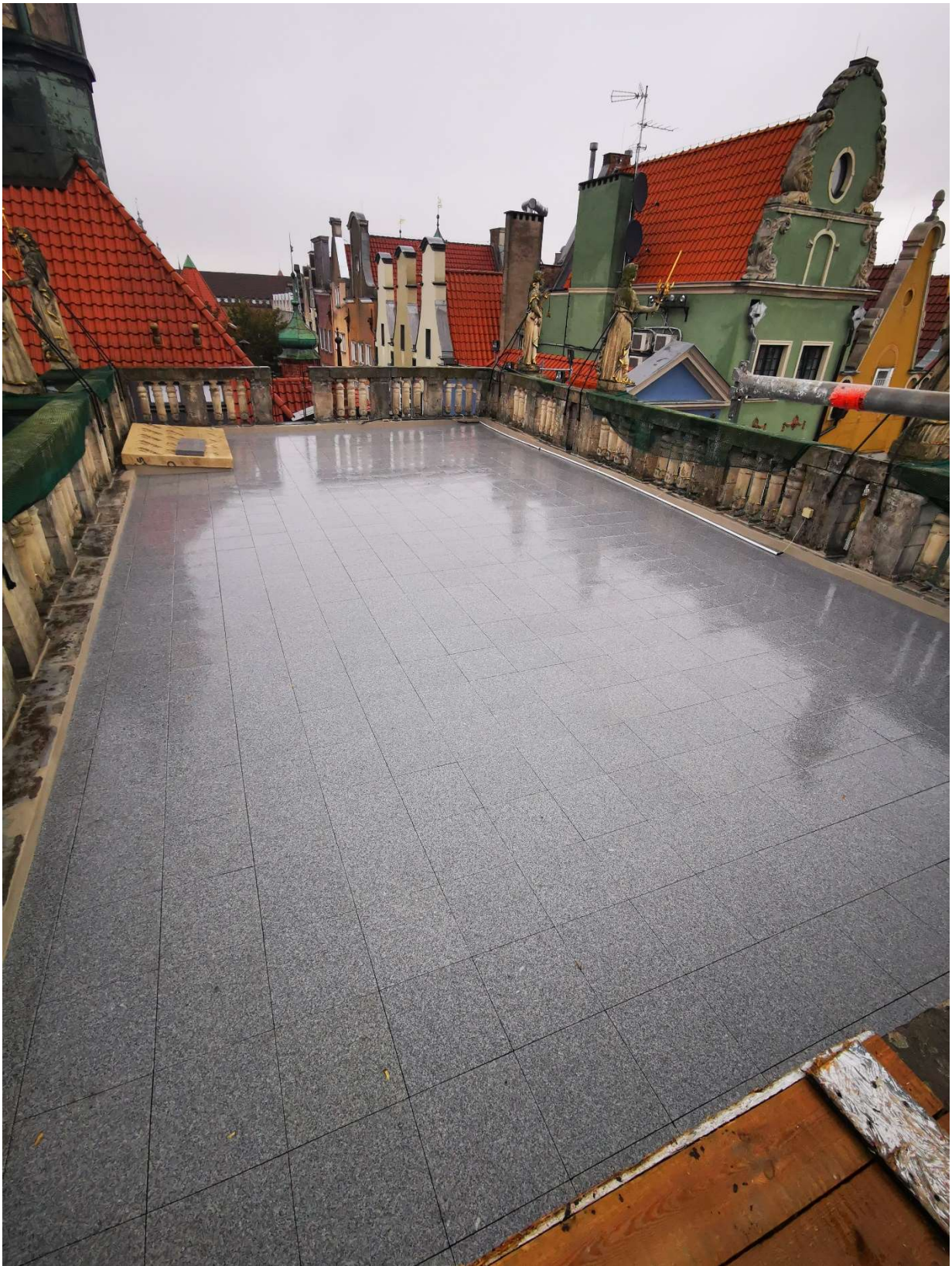
Fot. 28. Wewnętrzna część tarasu po konserwacji – ułożenie posadzki, usunięcie nawarstwień pochodzenia mikrobiologicznego oraz wyrównanie kamiennego cokołu zaprawą cementowo-wapienną (fot. M. Gruchała-Więsierska)
