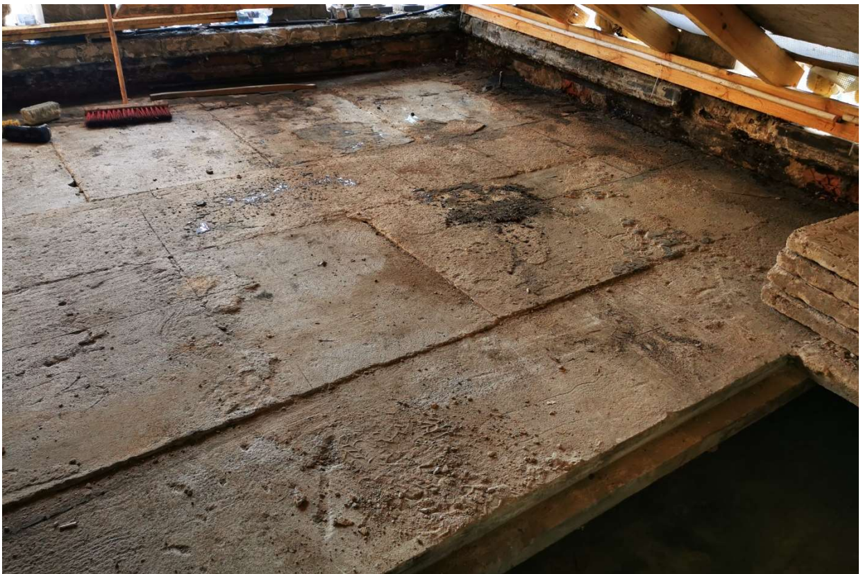
Fot. 11. W trakcie prac – stropowe płyty betonowe - ostatnia warstwa tarasu (fot. M. Gruchała-Więsierska)
