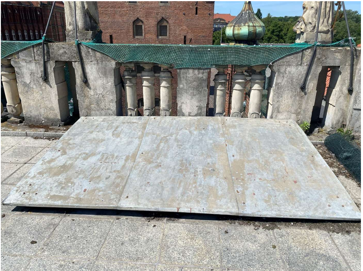
Fot. 2. Stan tarasu przed konserwacją – metalowa kłapa (fot. W. Domagała)
