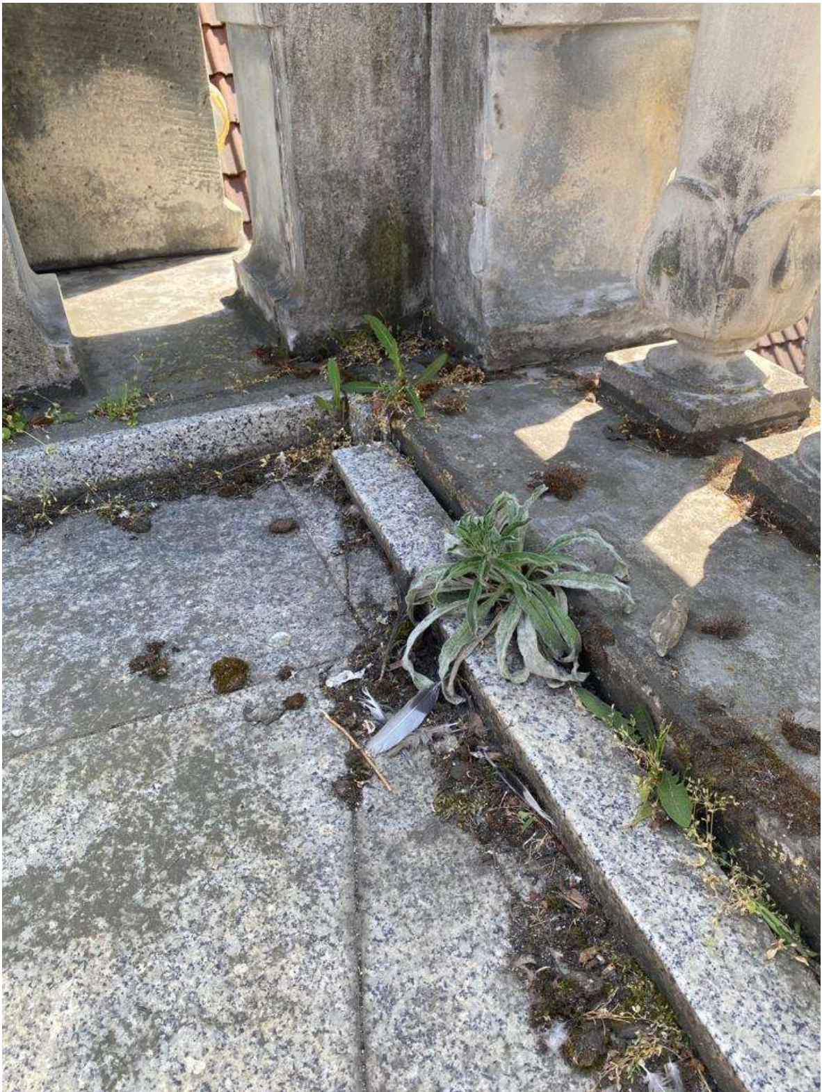
Fot. 5. Stan posadzki przed konserwacją – liczne nawarstwienia pochodzenia mikrobiologicznego powstające ze względu na nieszczelność elementów posadzki i degradację spoin (fot. W. Domagała)
