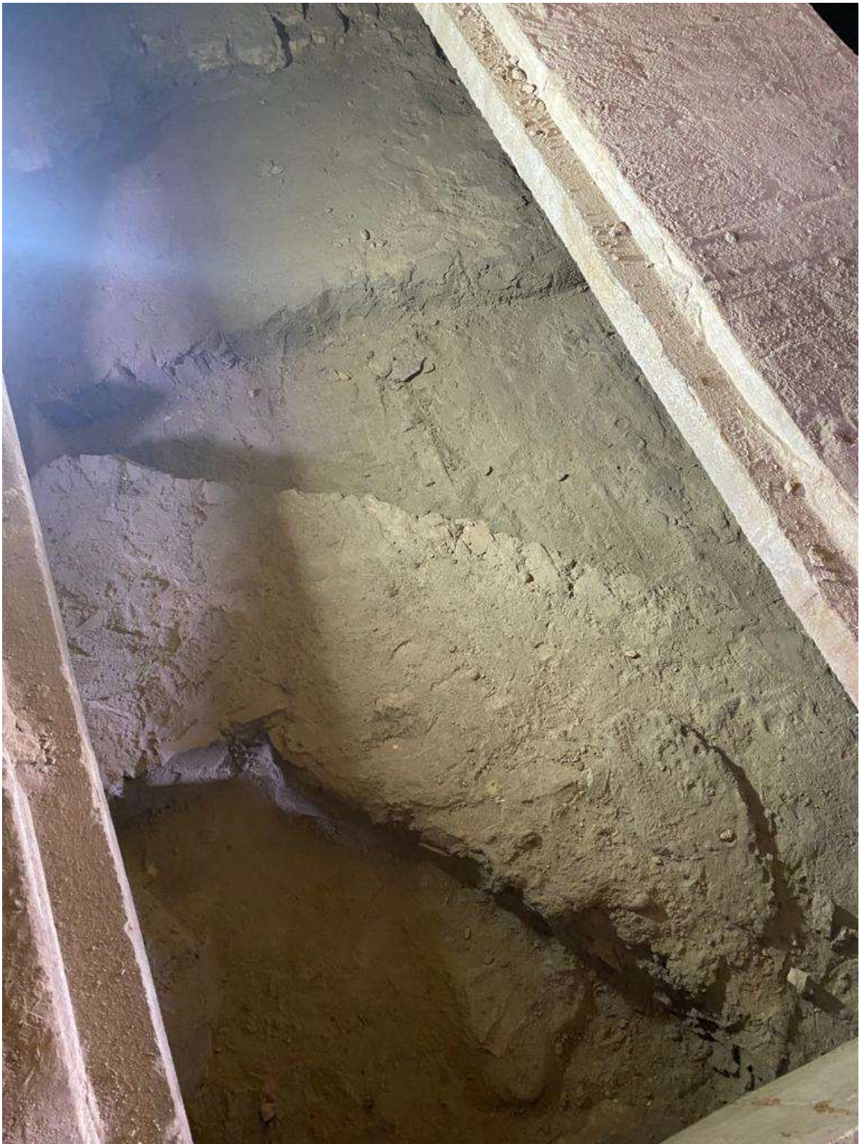
Fot. 14. Powierzchnia sklepień widoczna po usunięciu betonowych płyt i konserwacji (fot. W. Domagała)
