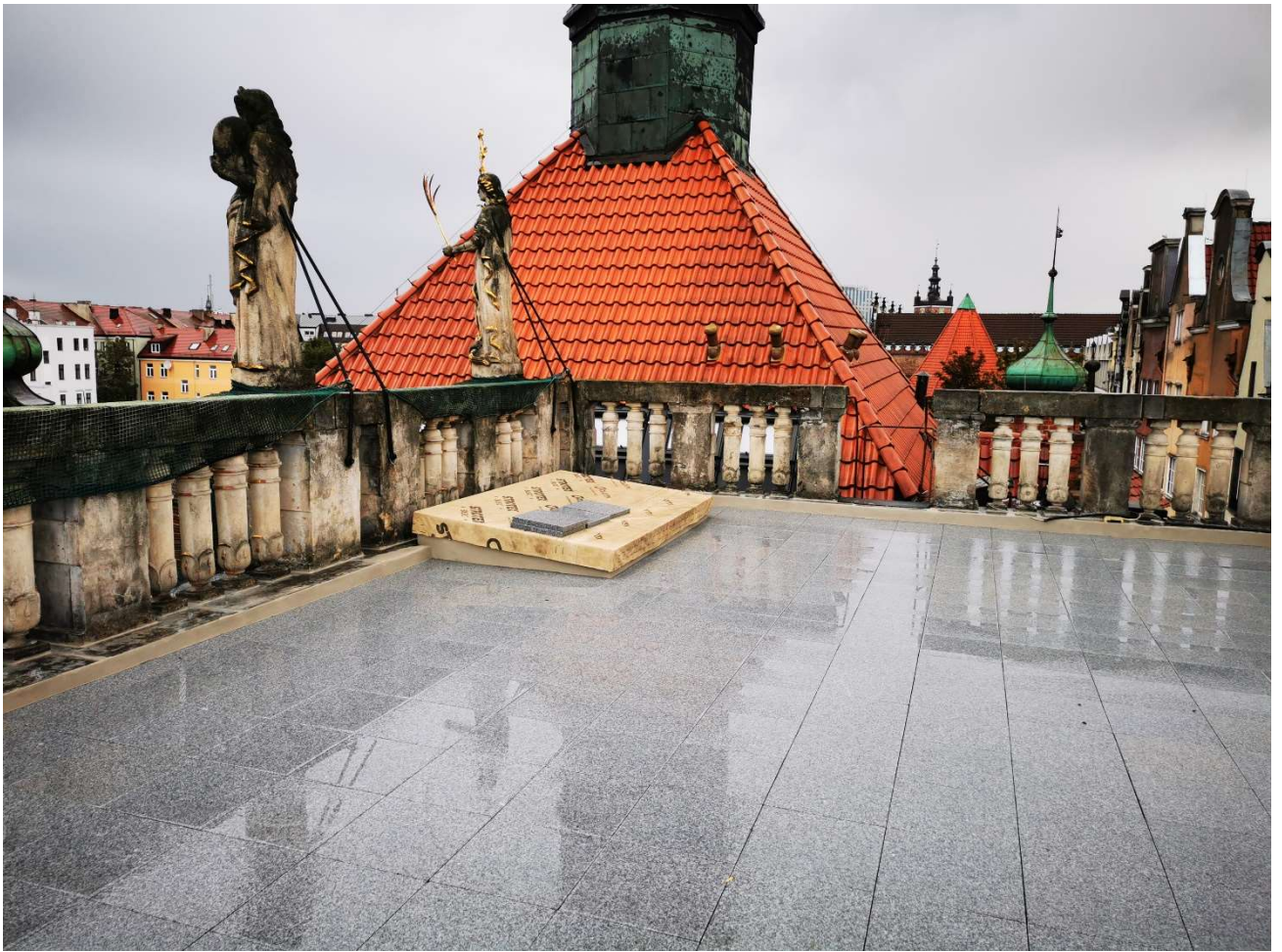
Fot. 27. Wewnętrzna część tarasu po konserwacji – ułożenie posadzki, usunięcie nawarstwień pochodzenia mikrobiologicznego oraz wyrównanie kamiennego cokołu zaprawą cementowo-wapienną. Metalowa kłapa została dodatkowo zabezpieczona. (fot. M. Gruchała-Więsierska)
