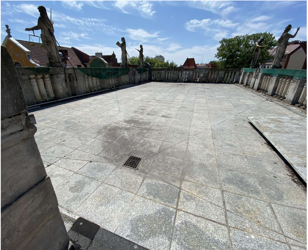
Fot. 1. Stan posadzki przed konserwacją (fot. W. Domagała)
