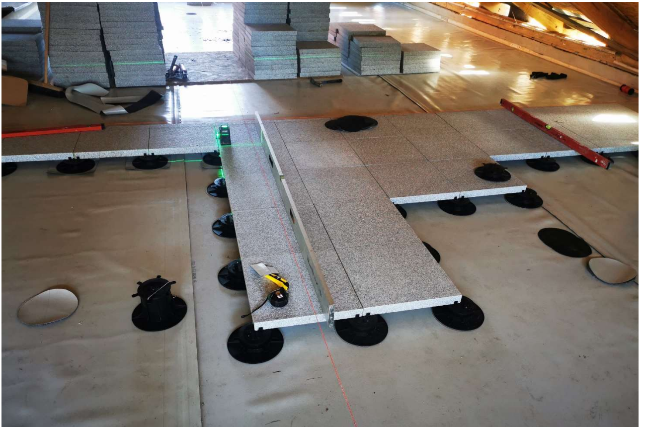
Fot. 24. W trakcie prac – Układanie płytek granitowych na wspornikach tarasowych (fot. M. Gruchała-Więsierska)
