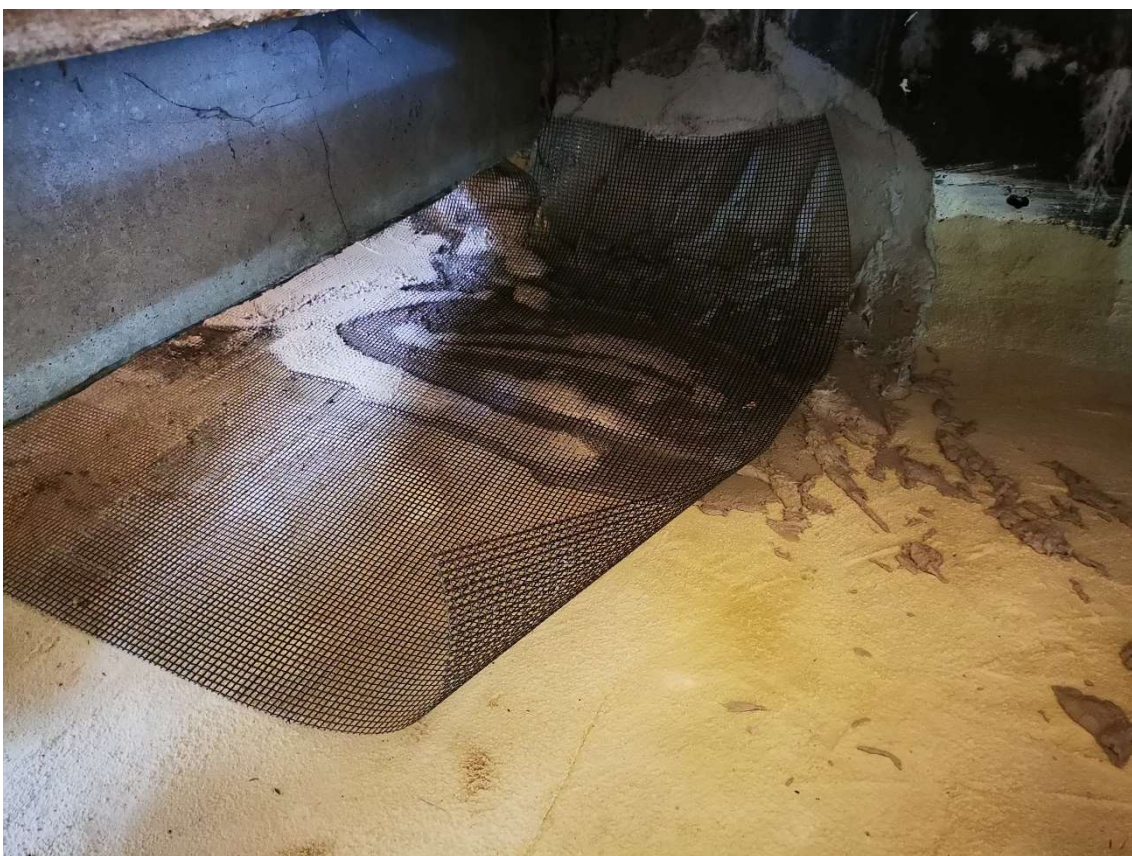
Fot. 17. W trakcie prac- układanie siatki z włókna bazaltowego na przygotowanej powierzchni sklepień (fot. M. Gruchała-Więsierska).
