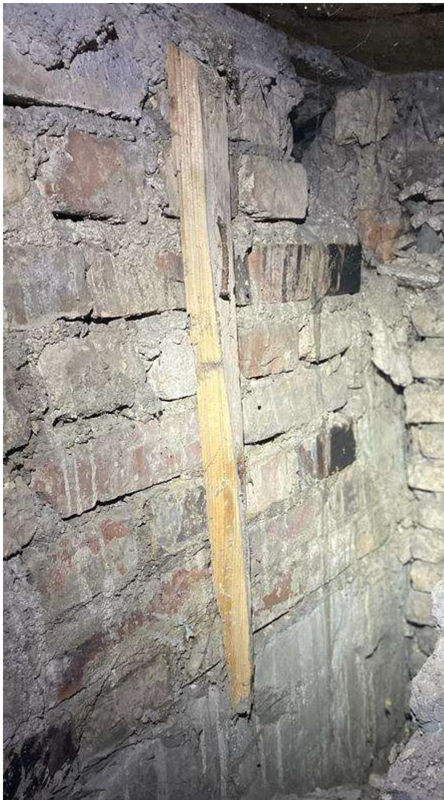
Fot. 13. Wątek ceglany murów obwodowych widoczny od wewnątrz, po usunięciu betonowych płyt. (fot. W. Domagała)
