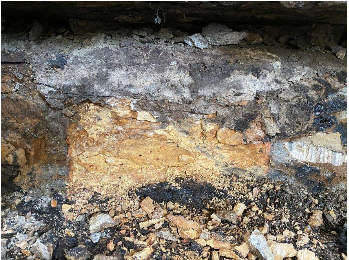
Fot. 7. W trakcie prac - zdeintegrowana cegła cokołu (fot. W. Domagała)
