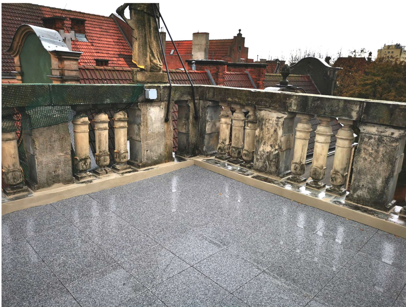
Fot. 25. Wewnętrzna część tarasu po konserwacji – ułożenie posadzki, usunięcie nawarstwień pochodzenia mikrobiologicznego oraz wyrównanie kamiennego cokołu zaprawą z domieszką związków krzemooorganicznych o wysokiej dyfuzyjności (fot. M. Gruchała-Więsierska)
