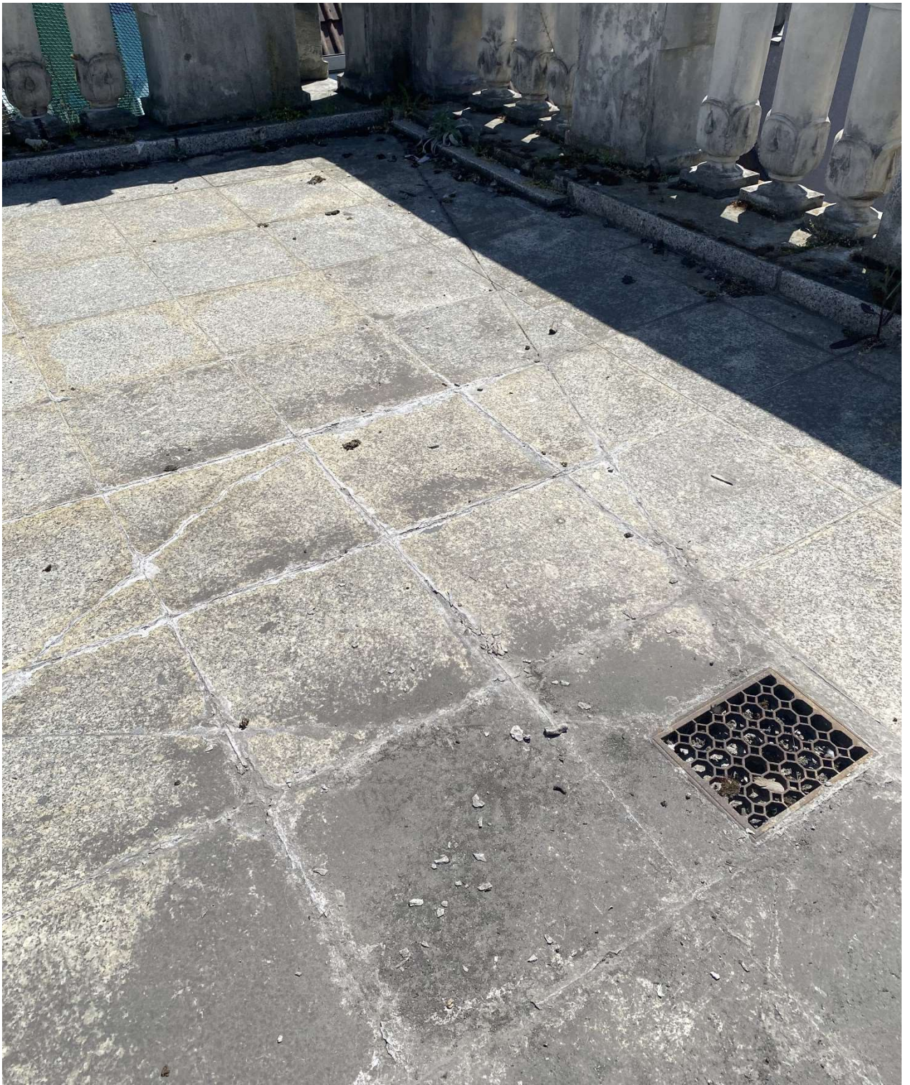
Fot. 4. Stan posadzki przed konserwacją – uszkodzenia mechaniczne oraz wtórne nawarstwienia gromadzące się w okolicy zardzewiałej kratki wentylacyjnej (fot. W. Domagała)
