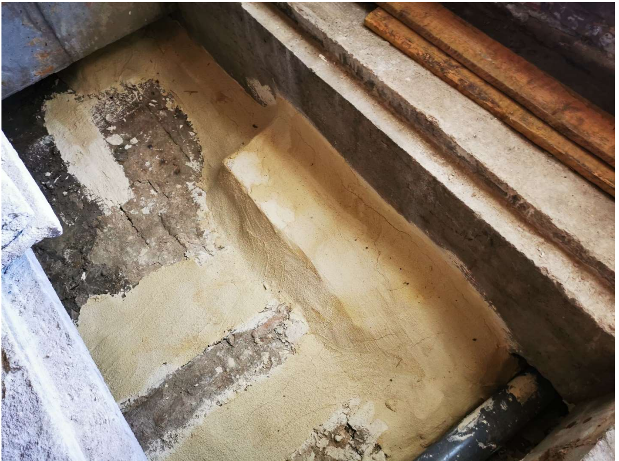
Fot. 16. W trakcie prac- Wykonywanie fasety na powierzchni sklepienia (fot. M. Gruchała-Więsierska).
