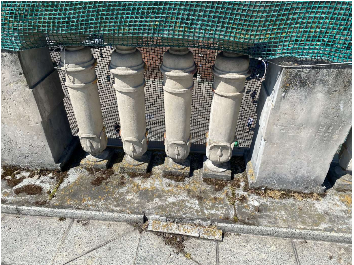
Fot. 3. Stan tarasu przed konserwacją – uszkodzenia mechaniczne oraz rozległe porażenie mikrobiologiczne (fot. W. Domagała)
