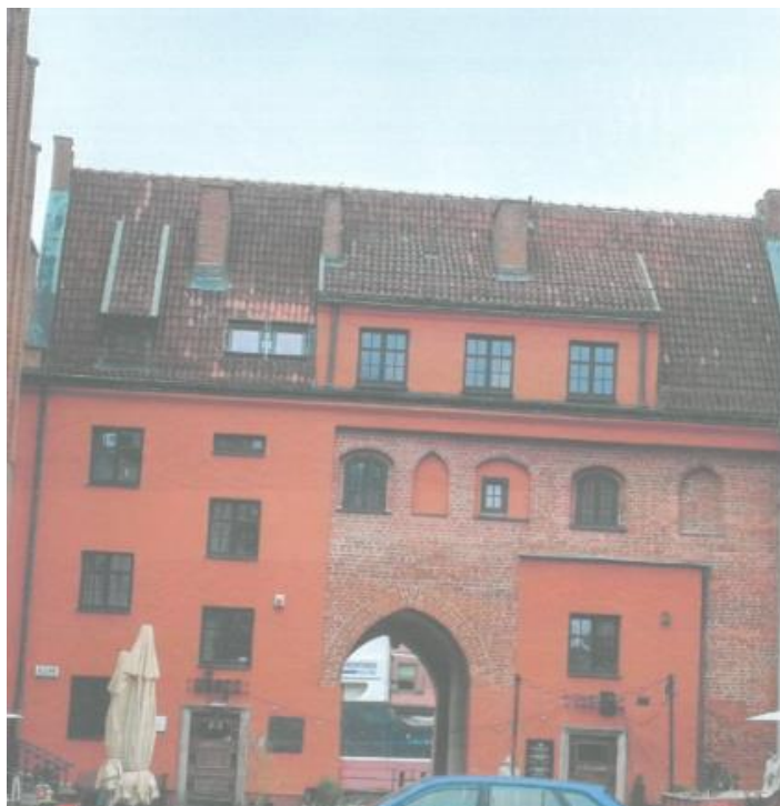
Fot. 1: Połąć zachodnia dachu Bramy Świętojańskiej przed rozpoczęciem prac remontowych: widok ogólny (listopad 2021r.)
