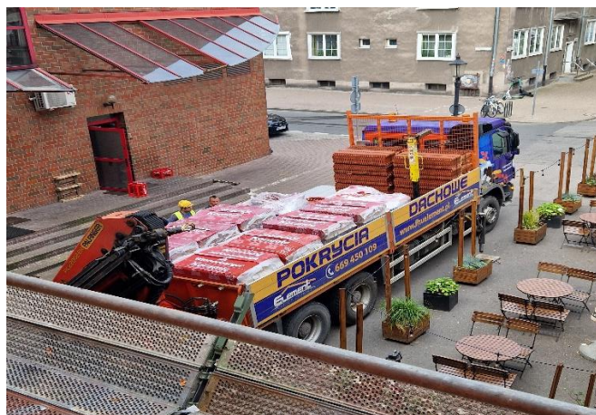
Fot. 13: Rozładunek dachówki przewidzianej do wbudowania w połac zachodnią dachu budynku Bramy Świętojańskiej
