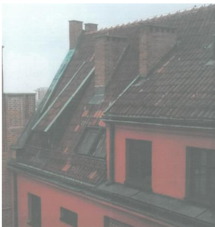
Fot. 2: Połąć zachodnia dachu Bramy Świętojańskiej przed rozpoczęciem prac remontowych: widok strony lewej w zbliżeniu (listopad 2021r.)
