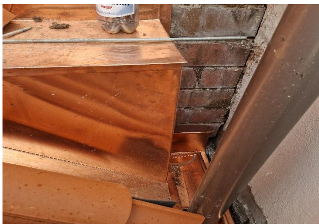
Fot. 4: Szczegół wykonania obróbek blacharskich przy attyce od strony prawej zachodniej połaci dachowej
