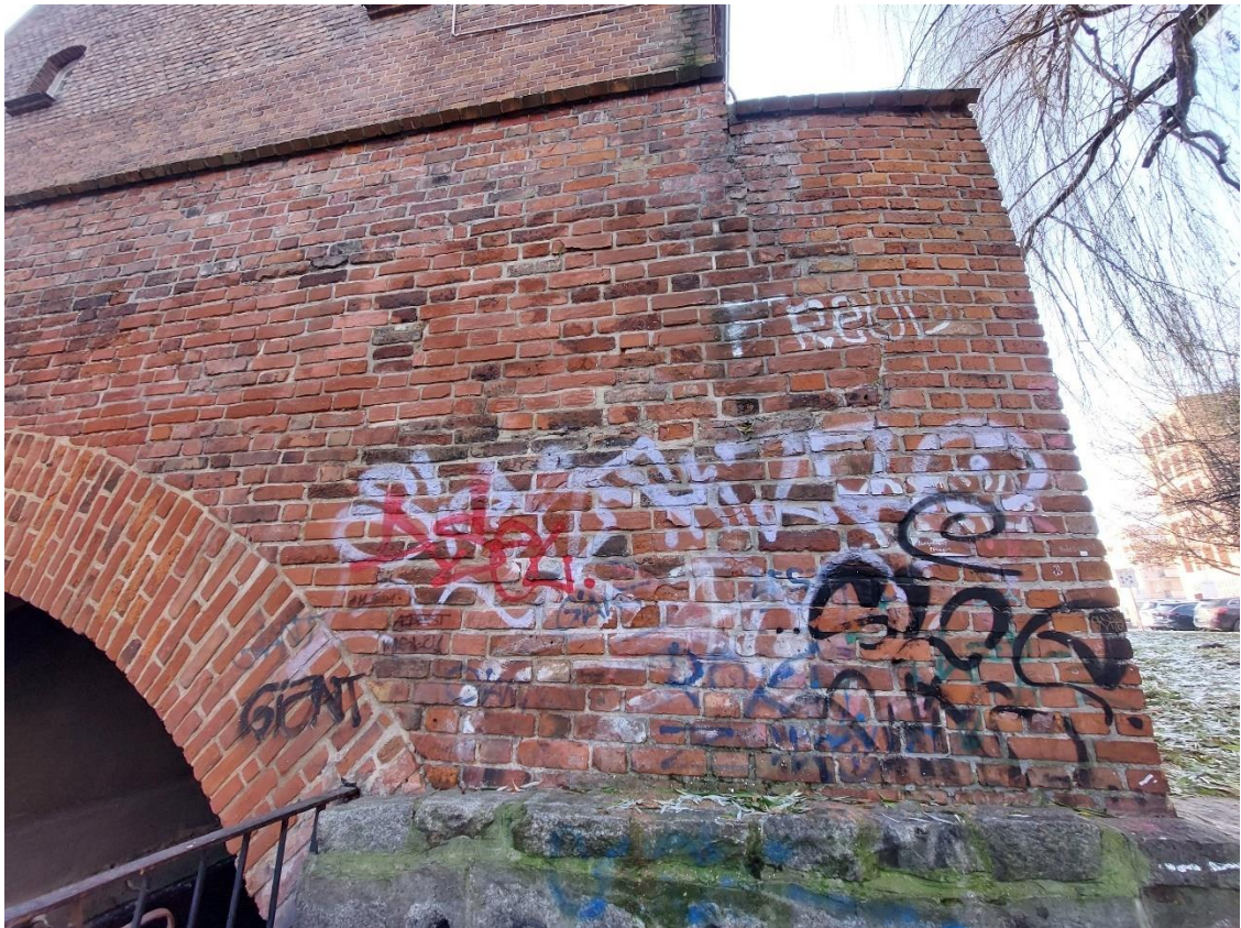
Ilustracja 8. Stan elewacji przed podjęciem prac konserwatorskich
