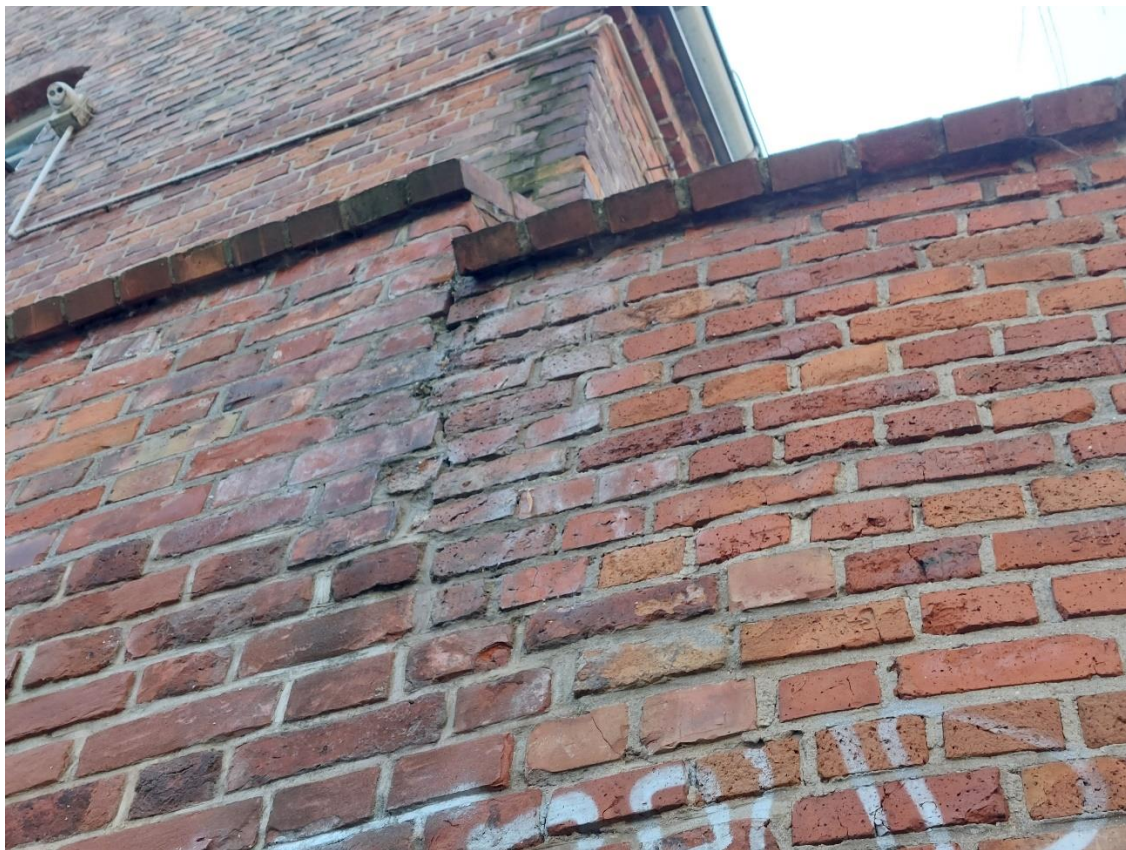
Ilustracja 9. Stan elewacji przed podjęciem prac konserwatorskich
