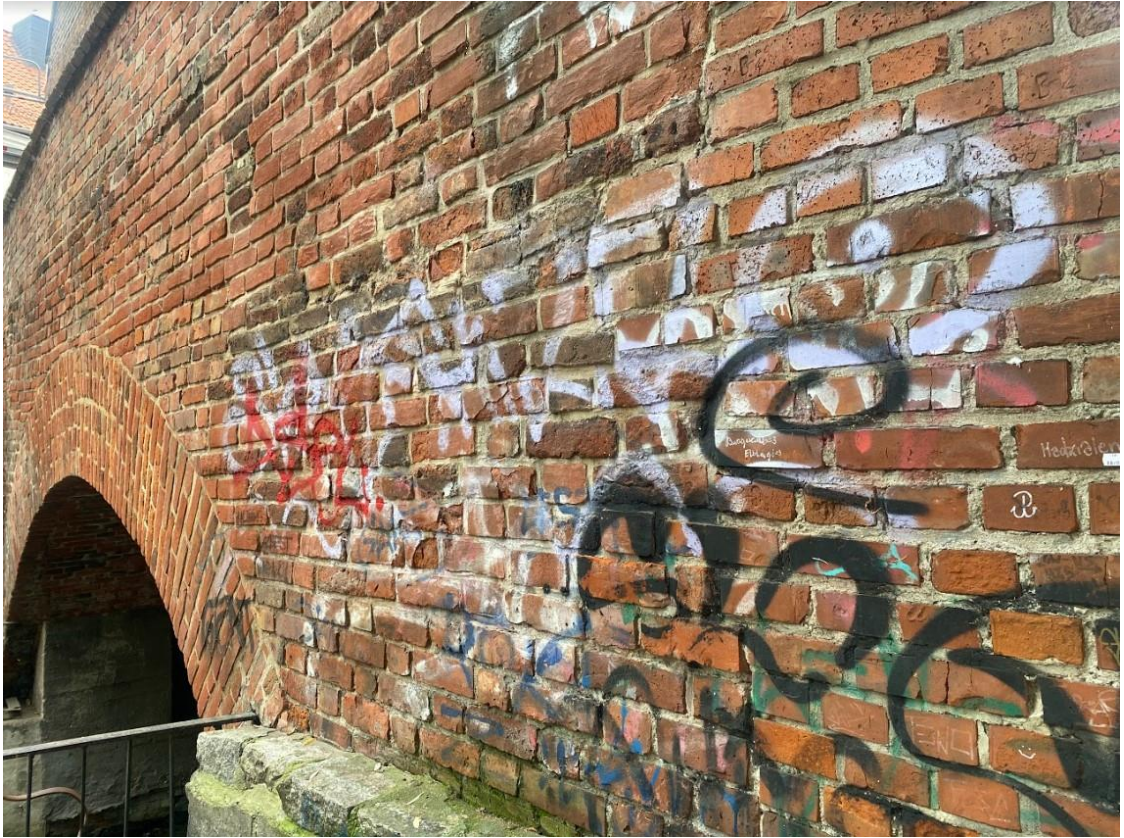
Ilustracja 7. Stan elewacji przed podjęciem prac konserwatorskich
