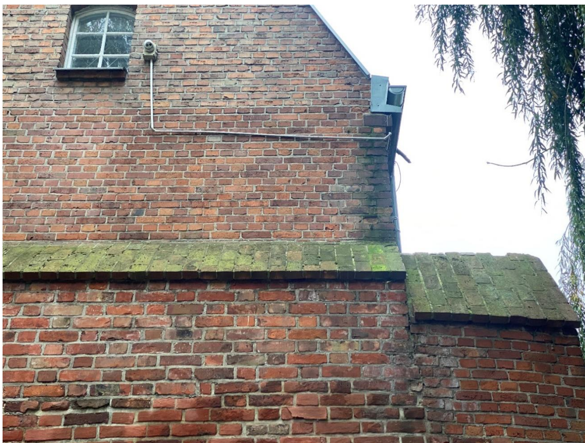
Ilustracja 10. Stan elewacji przed podjęciem prac konserwatorskich
