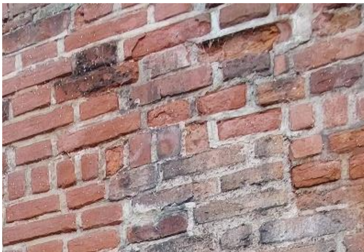
Ilustracja 12. Stan elewacji przed podjęciem prac konserwatorskich
