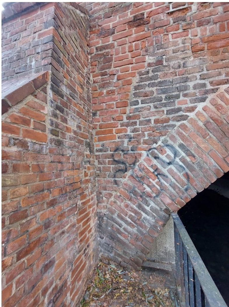
Ilustracja 11. Stan elewacji przed podjęciem prac konserwatorskich
