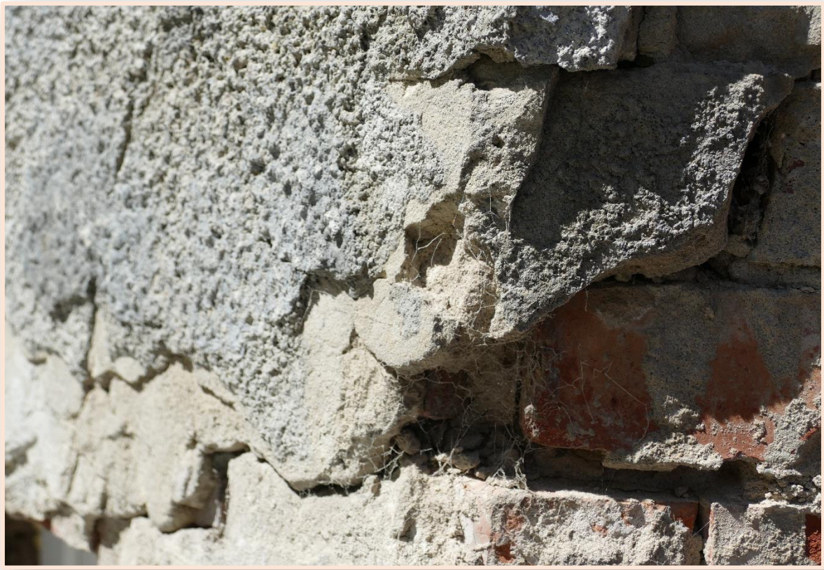
11, 12,13. Miejscowy stan zachowania tynków elewacyjnych, podokienników i gzymsów okapowych.
