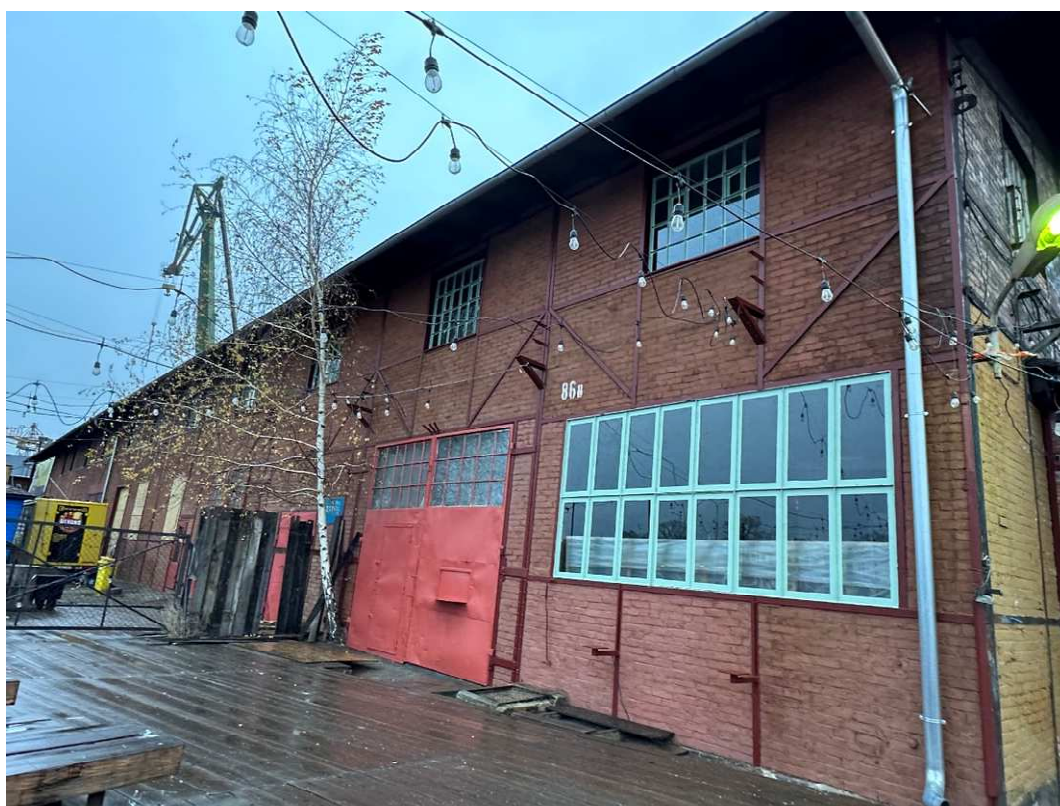
Fot. 33 Budynku dawnych garaży elektrowozów/magazyn (86B), fragment el. południowo-zachodnia, stan po pracach, fot. 2023r.
