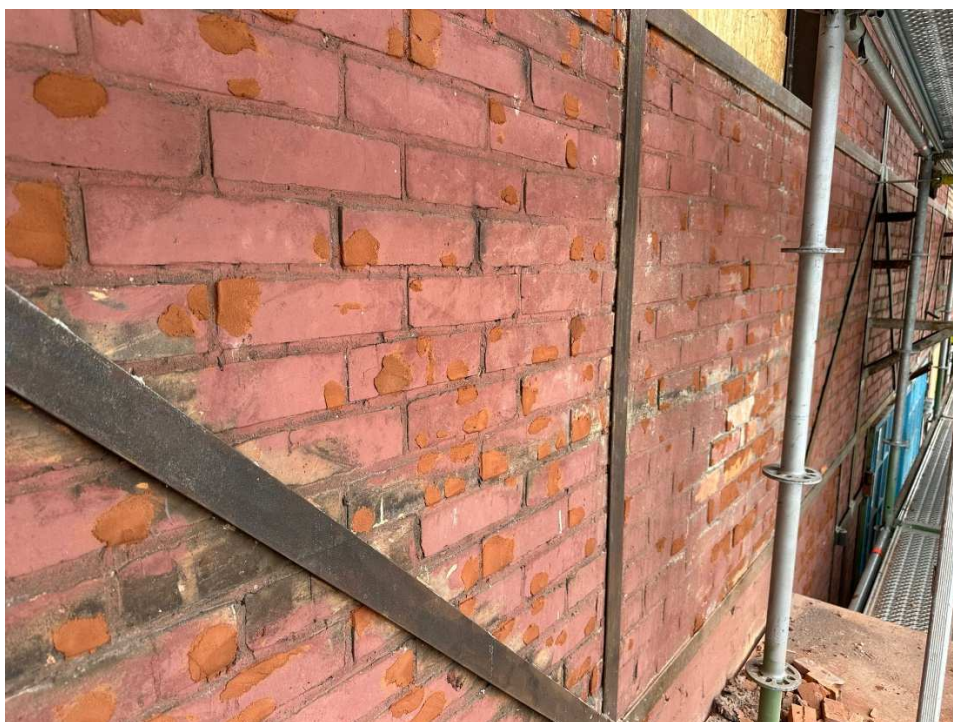
Fot. 13 Budynku dawnych garaży elektrowozów/magazyn (86B), fragment el. południowo-zachodnia, w trakcie prac, uzupełnianie ubytków, fot. 2023r.
