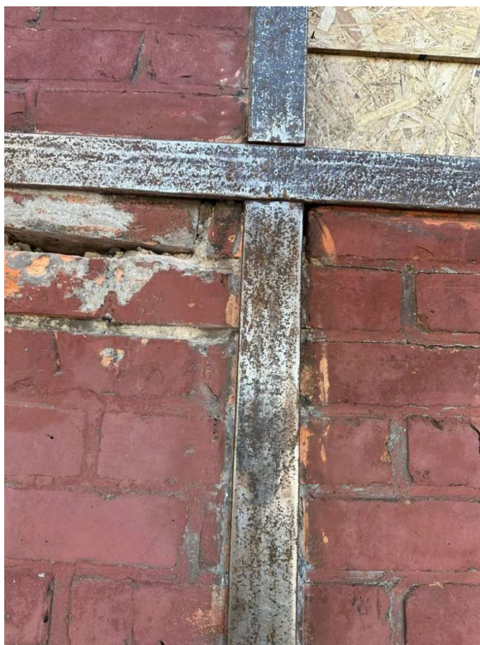
Fot. 12 Budynku dawnych garaży elektrowozów/magazyn (86B), fragment el. południowo-zachodnia, w trakcie prac, oczyszczenie metali, fot. 2023r.
