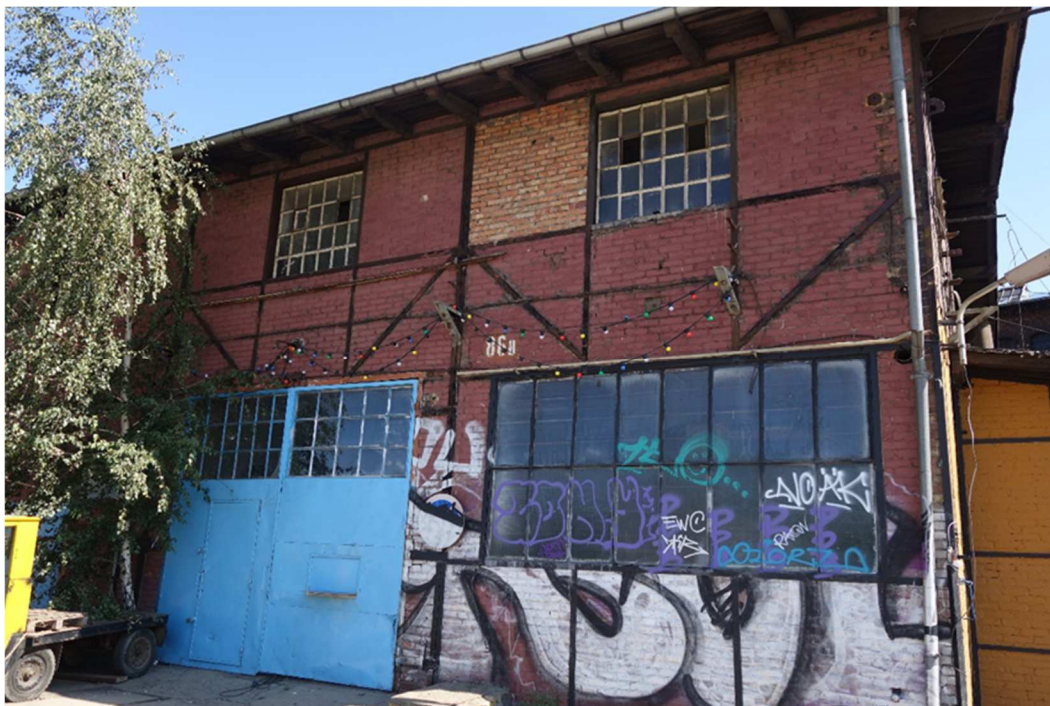
Fot. 32 Budynku dawnych garaży elektrowozów/magazyn (86B), fragment el. południowo-zachodnia, stan przed pracami, fot. 2023r.
