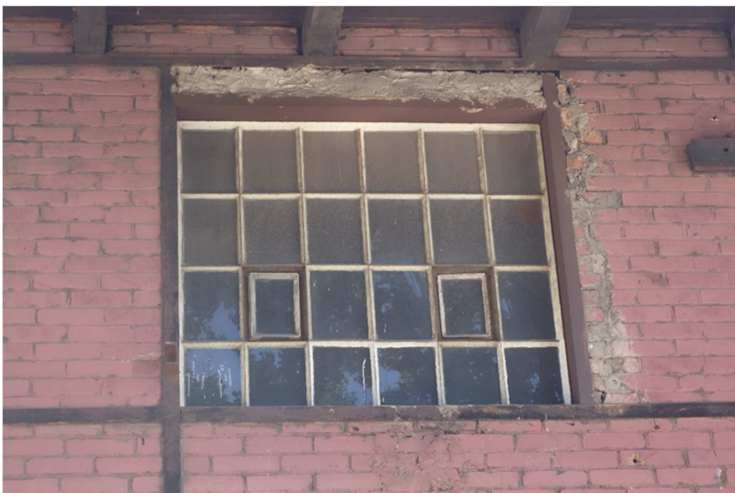
Fot. 38 Budynku dawnych garaży elektrowozów/magazyn (86B), fragment el. południowo-zachodnia, stan przed pracami, wtórne uzupełnienia wokół okna, fot. 2023r.
