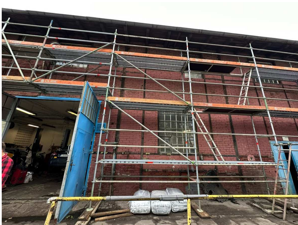
Fot. 10 Budynek dawnych garaży elektrowozów/magazyn (86B), fragment el. południowo- zachodnia, w trakcie prac, fot. 2023r.
