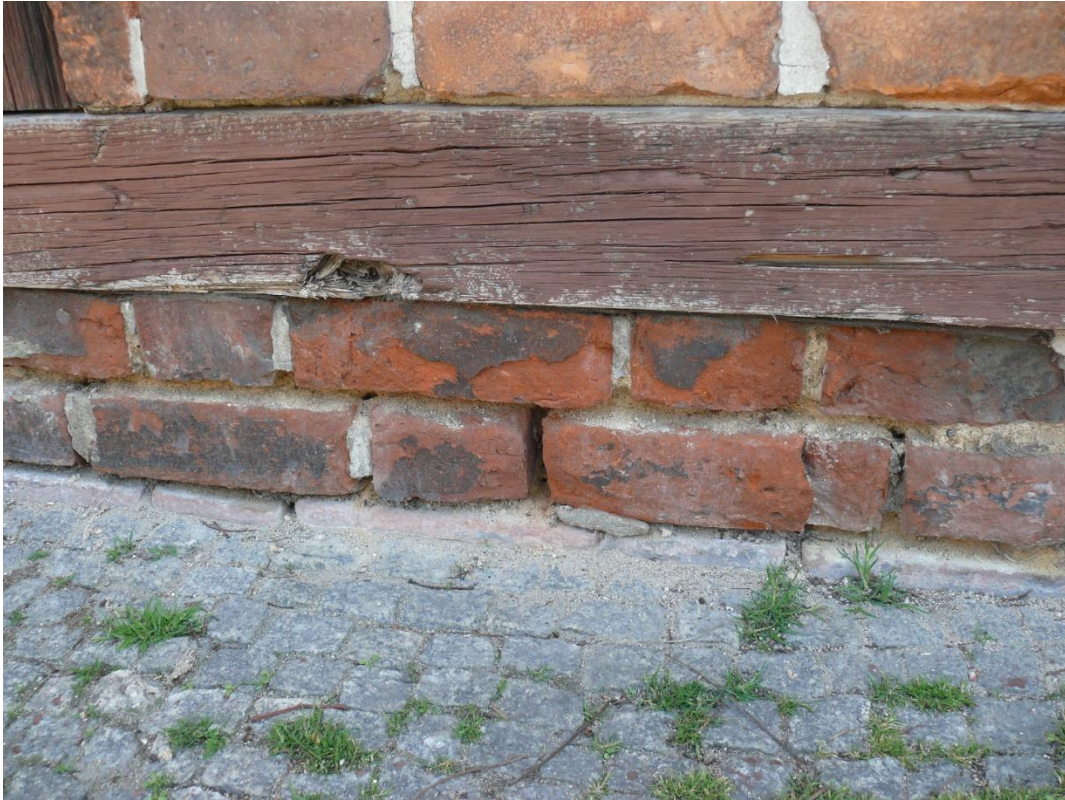
Brak zapraw w spoinach.
