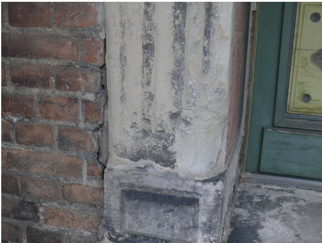
Widoczny głęboki ubytek na krawędzi płyciny górnej.
