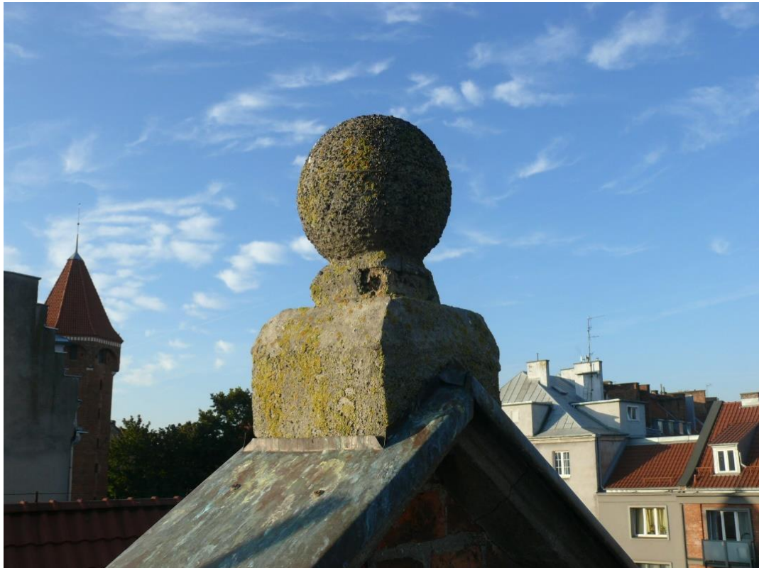
Detal architektoniczny wykonany z zaprawy betonowej porośnięty glonami i porostami.
