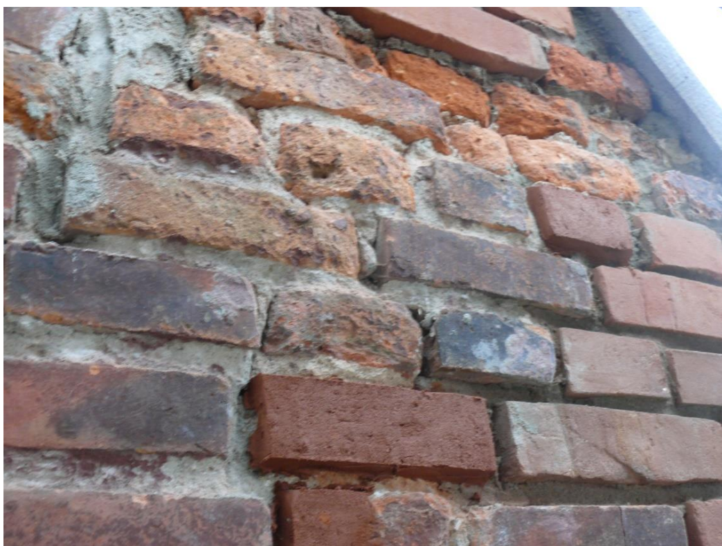
Fragment szczytu widoczne ubytki, przemurowania i wypełnienia zaprawą mineralną barwioną w masie.
