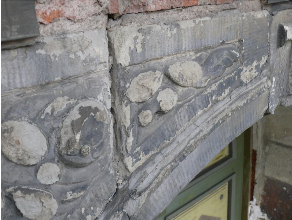
Ubytki w spoinie pomiędzy blokami kamienia, brak części architrawu wykonanego z zaprawy.
