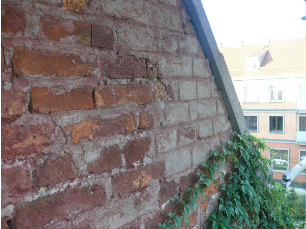
Szczyt ryzalitu w dużym stopniu naprawiony był zaprawą betonową i pomalowany na kolor ciemno- czerwony.
