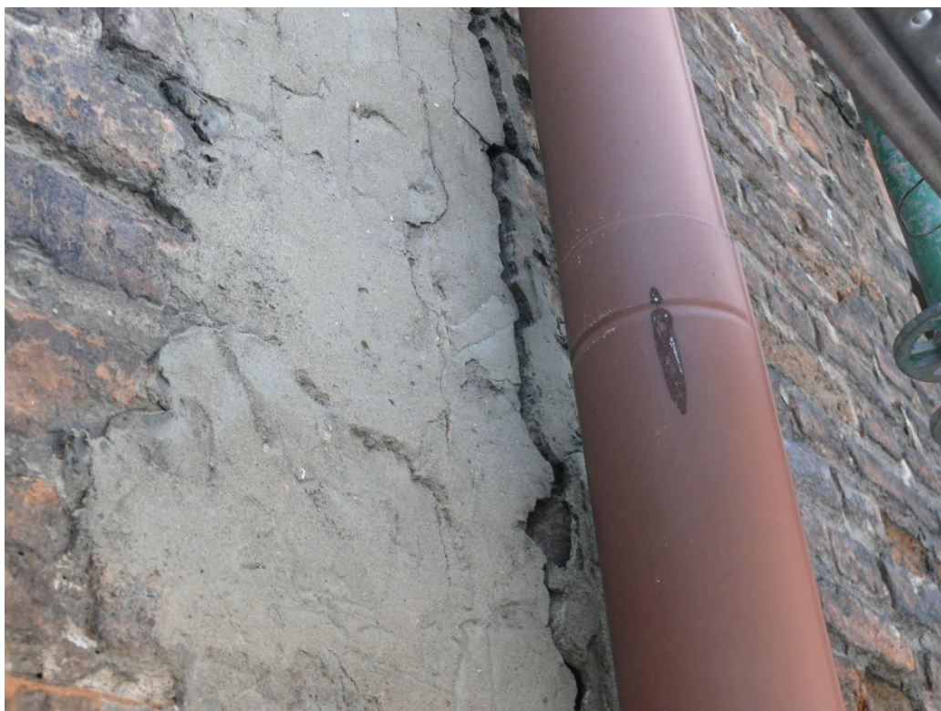
Pęknięcie w miejscu łączenia dwóch budynków.
