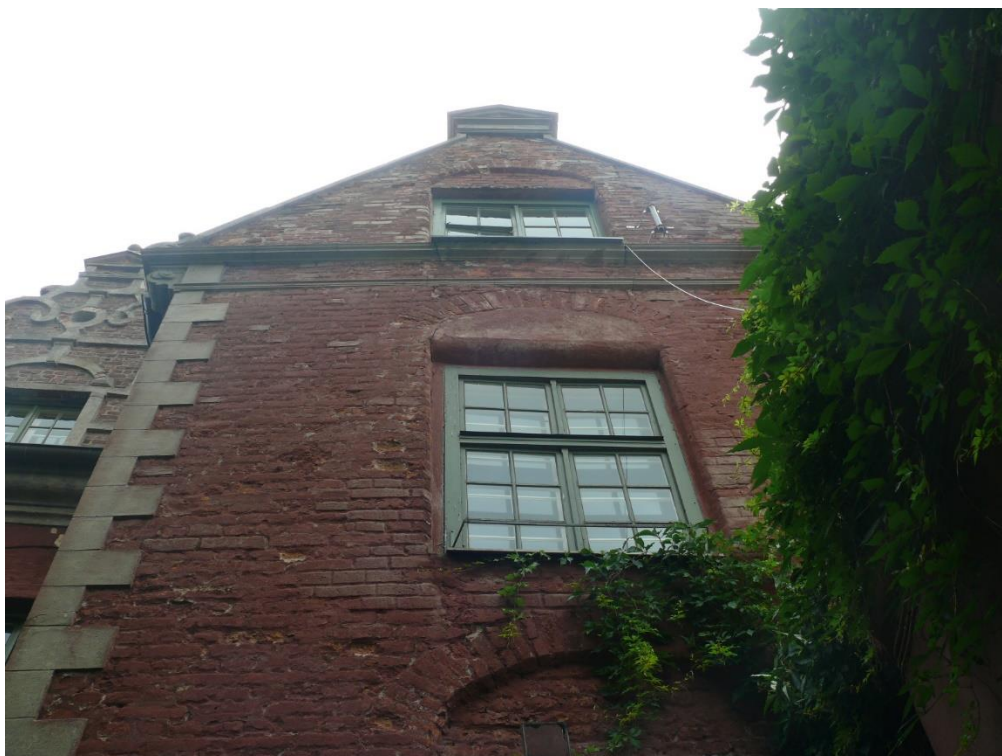
Ryzalit od strony północnej- ubytki cegieł porażonych bakteriami nitryfikacyjnymi.
