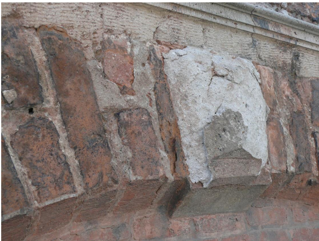
Zwornik z zaprawy innego rodzaju niż gzyms powyżej.
