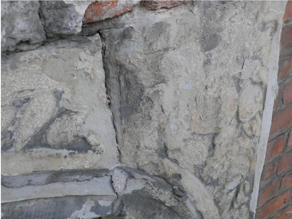
Głęboki ubytek w masie kamienia oraz złuszczenia postępujące od powierzchni.
