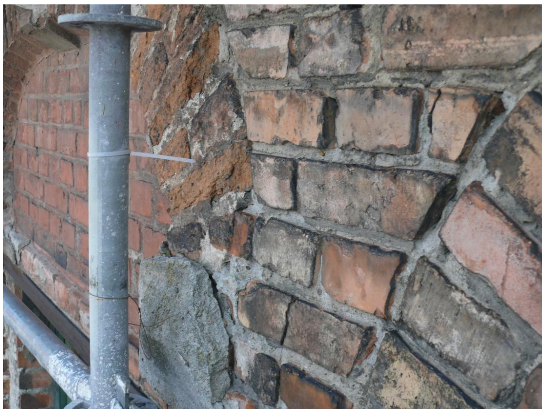
Fragment boniowania z zaprawy cementowej odspojony od powierzchni muru.
