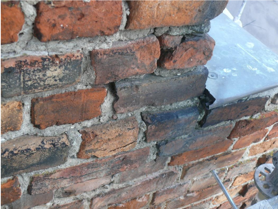
Powojenna odbudowa, zaprawa murarska w spoinach-brak opracowania powierzchni, ubytki w zaprawie.
