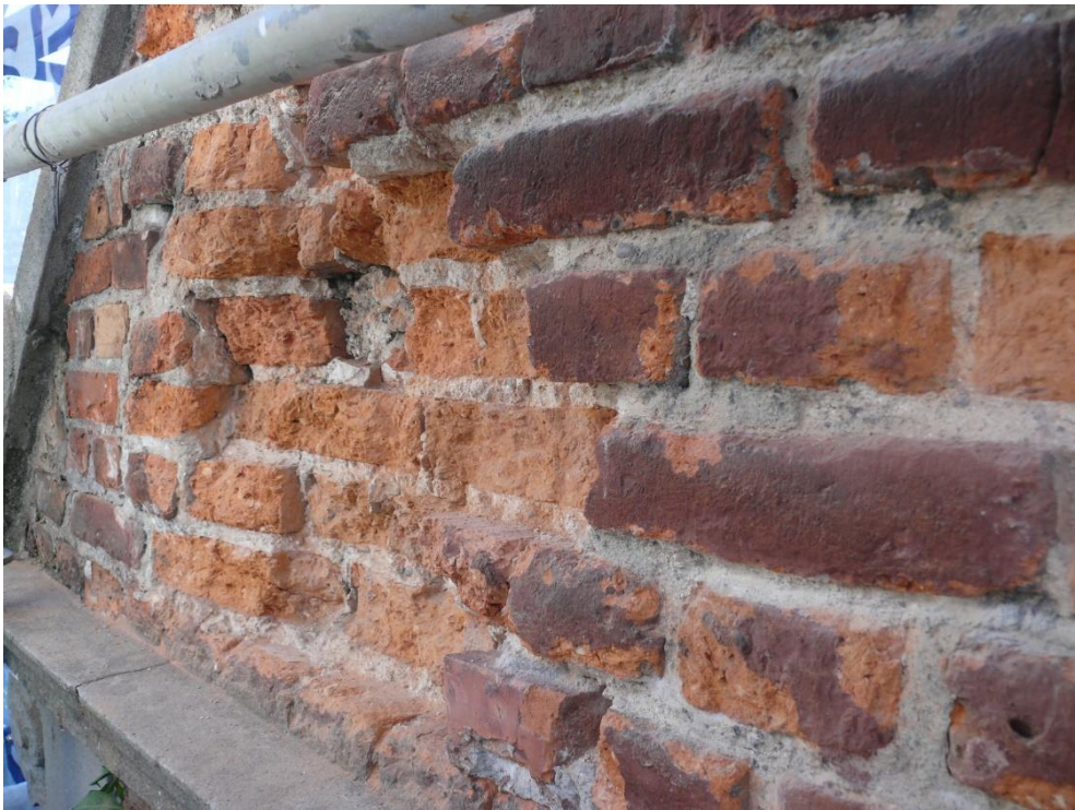
Duży ubytek przeznaczony do przemurowania nowymi cegłami.
