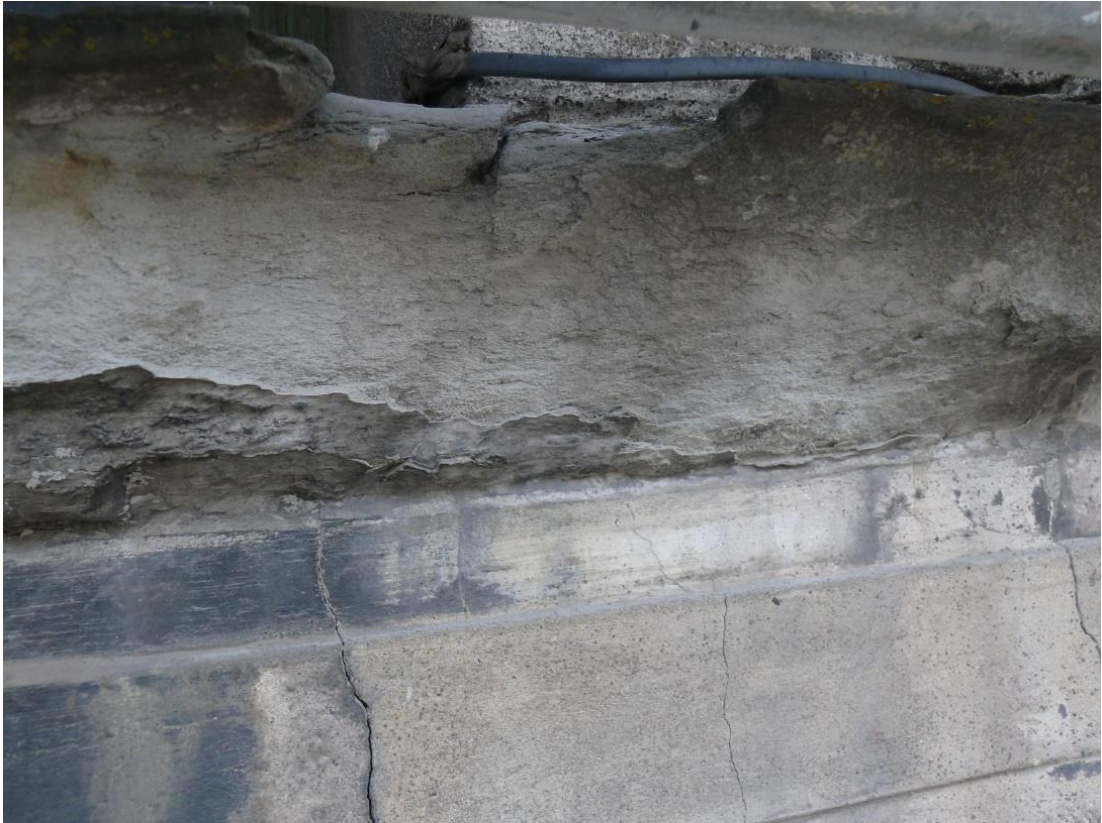
Gzyms zachowany w bardzo złym stanie- ubytki stanowiły 50% masy kamienia.
