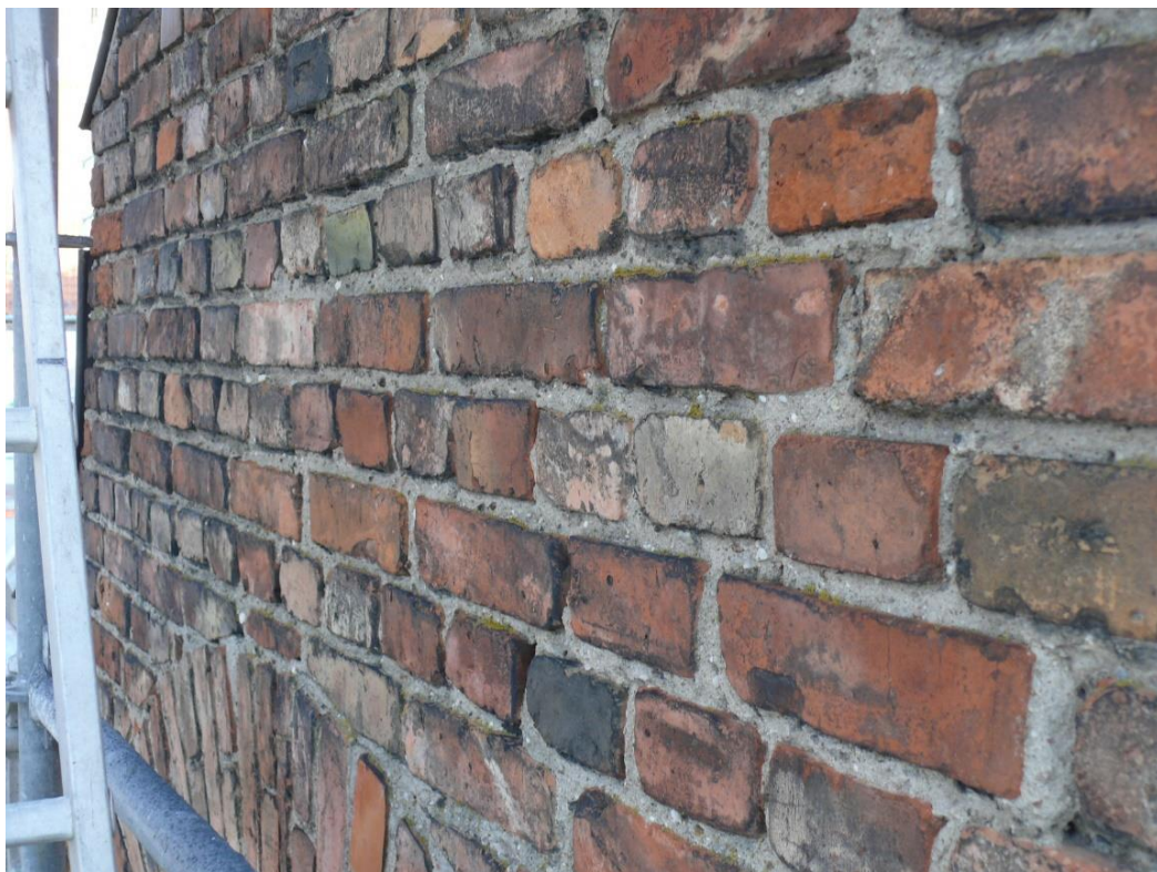
Pomiędzy cegłami widoczna jest zaprawa murarska, nie wykonano osobnego spoinowania.
