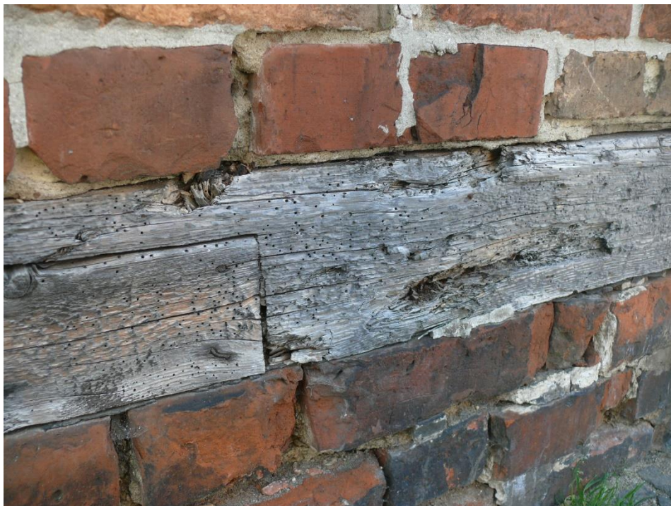
W konstrukcji drewnianej widoczne ślady żerowania owadów, brak zaprawy w spoinach.
