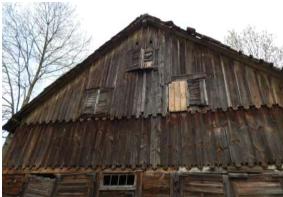
Fot. 3 Ściana szczytowa skorodowana przez czynniki atmosferyczne –wyplukanie powierzchniowo części bielastych, pociemniałe powierzchnie desek od słońca i opadów deszczu i śniegu
