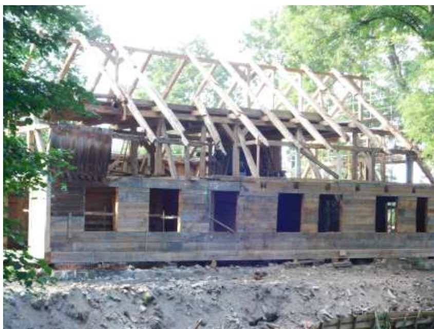
Fot. 10 Zdemontowano dachówki od strony wschodniej wraz z odeskowaniem i latami. Widoczny zły stan konstrukcji drewnianej więźby i konstrukcji ścian szkieletowych.
