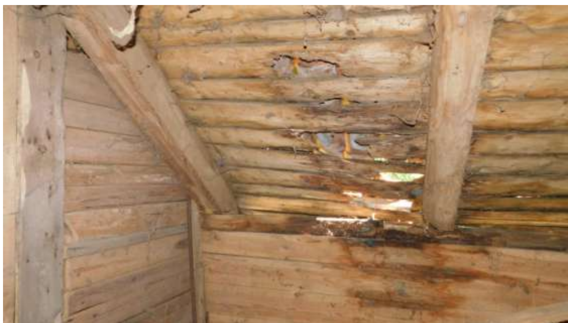
Fot. 4 Skorodowany fragment ściany i odeskowania dachu
