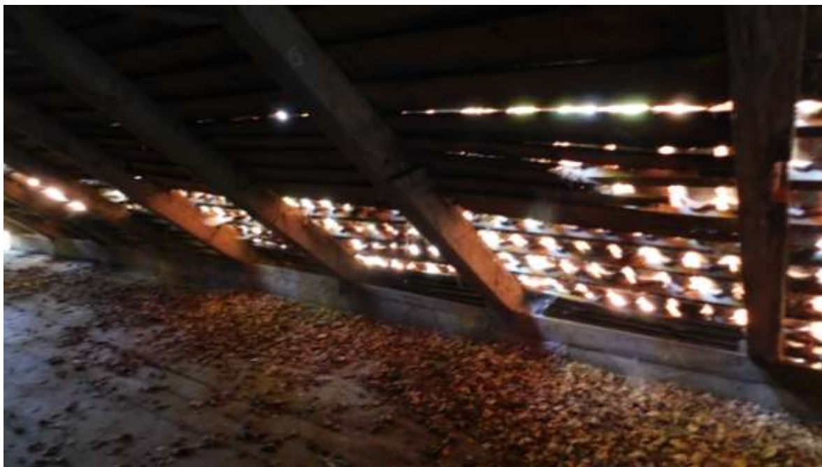
Fot. 5 Nieszczelności w pokryciu dachu
