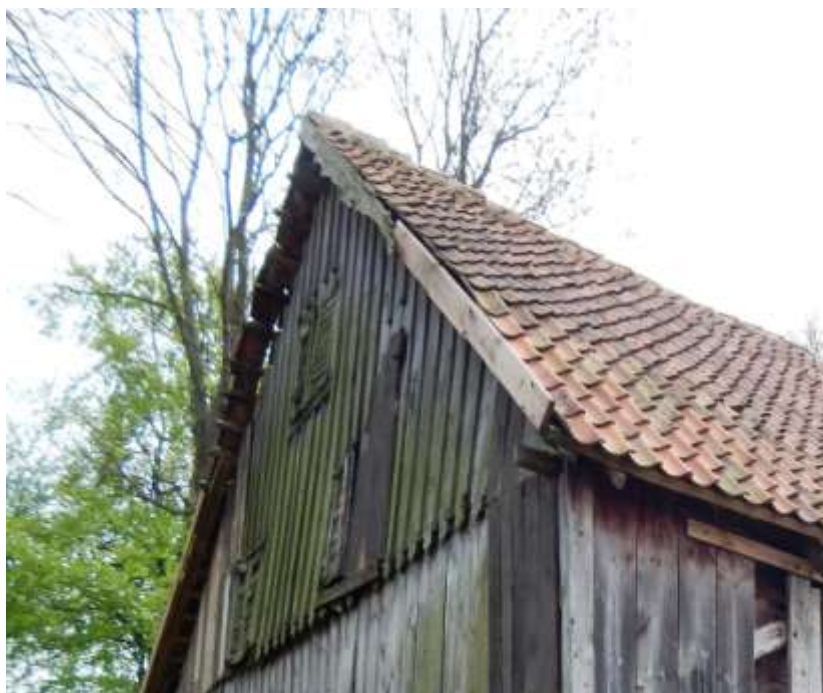
Fot. 2 Połacie dachu - widoczne porażenia biologiczne (mchy, glony i porosty) i skorodowane wiatrownice
