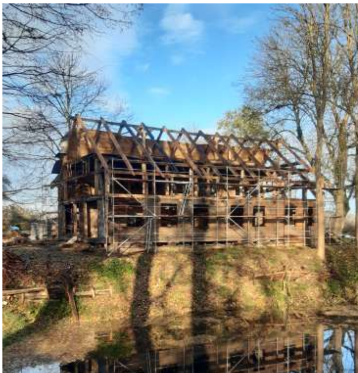
Fot. 21 Wykonane odeskowanie powierzchni zachodniej dachu wraz z membraną i kontr łatami
