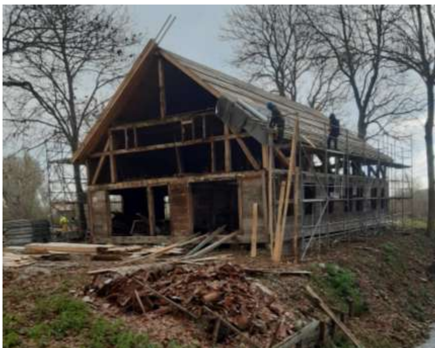
Fot. 22 Deskowanie połaci wschodniej wraz z ułożeniem membrany i montażem desek czołowych.
