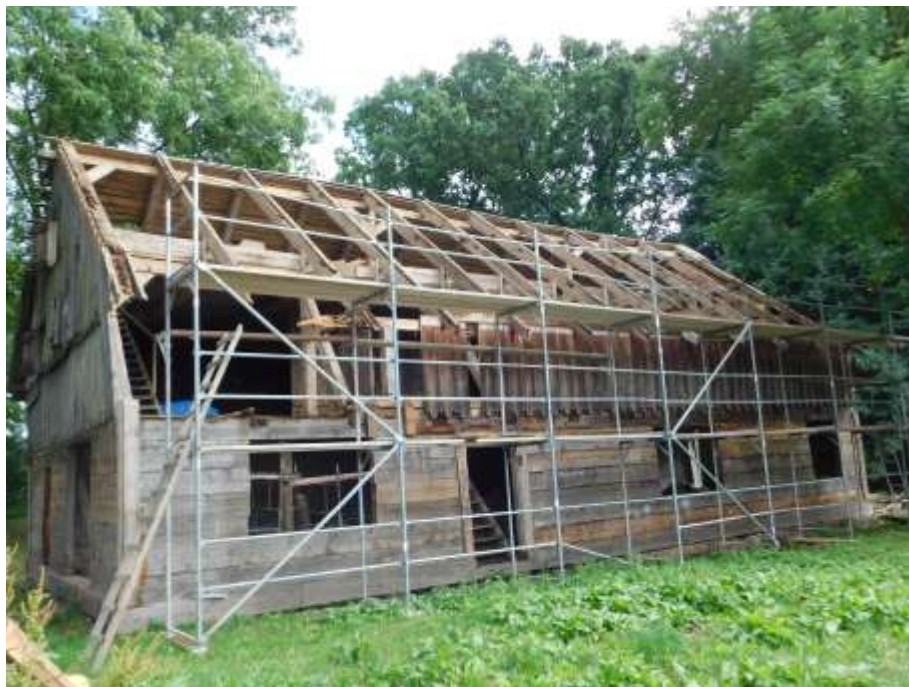
Fot. 9 Zdemontowano dachówki wraz z odeskowaniem od strony zachodniej. Widoczny zły stan konstrukcji drewnianej więźby i konstrukcji ścian szkieletowych.
