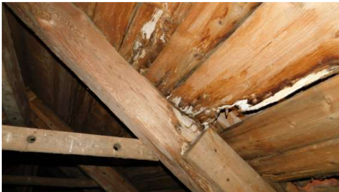
Fot. 7 Grzybnia na deskowaniu dachu
