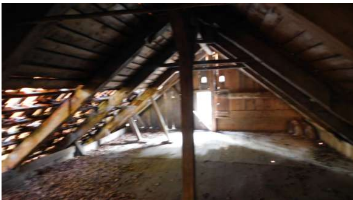
Fot. 6 Nieszczelności w pokryciu dachu
