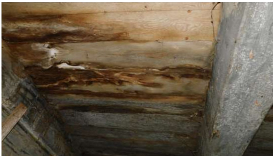
Fot. 8 Porażona biologicznie przez grzyby powierzchnia stropu nad parterem
