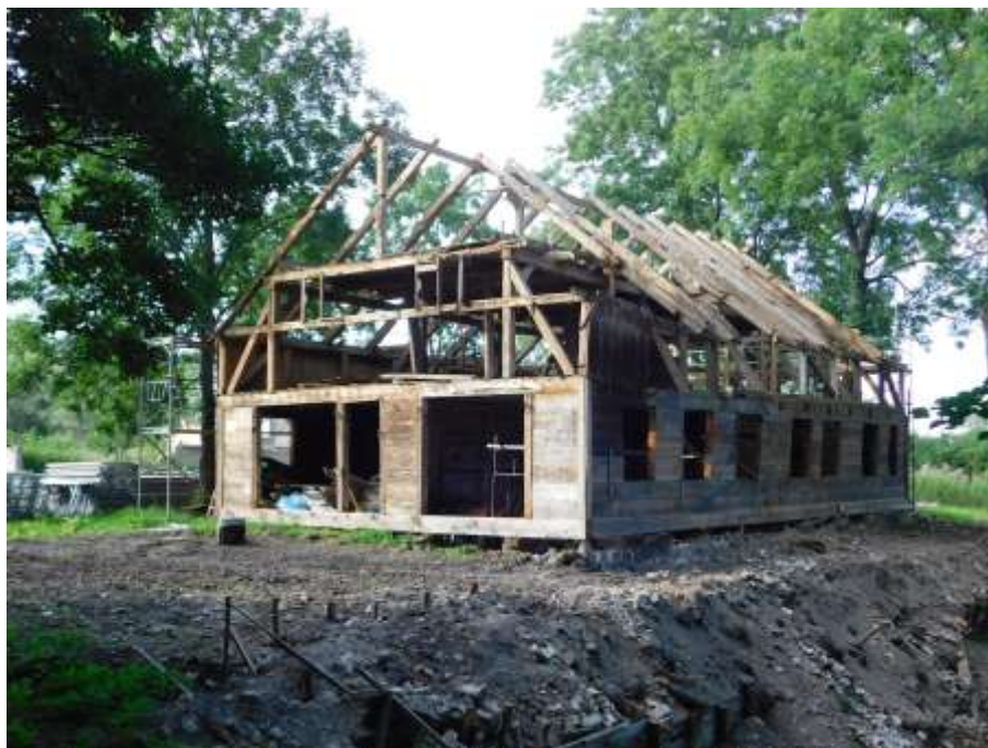
Fot. 11 Widoczny stan techniczny konstrukcji szkieletowej i więźby dachowej od strony południowej. Zdemontowano oszalowanie konstrukcji szkieletowej.
