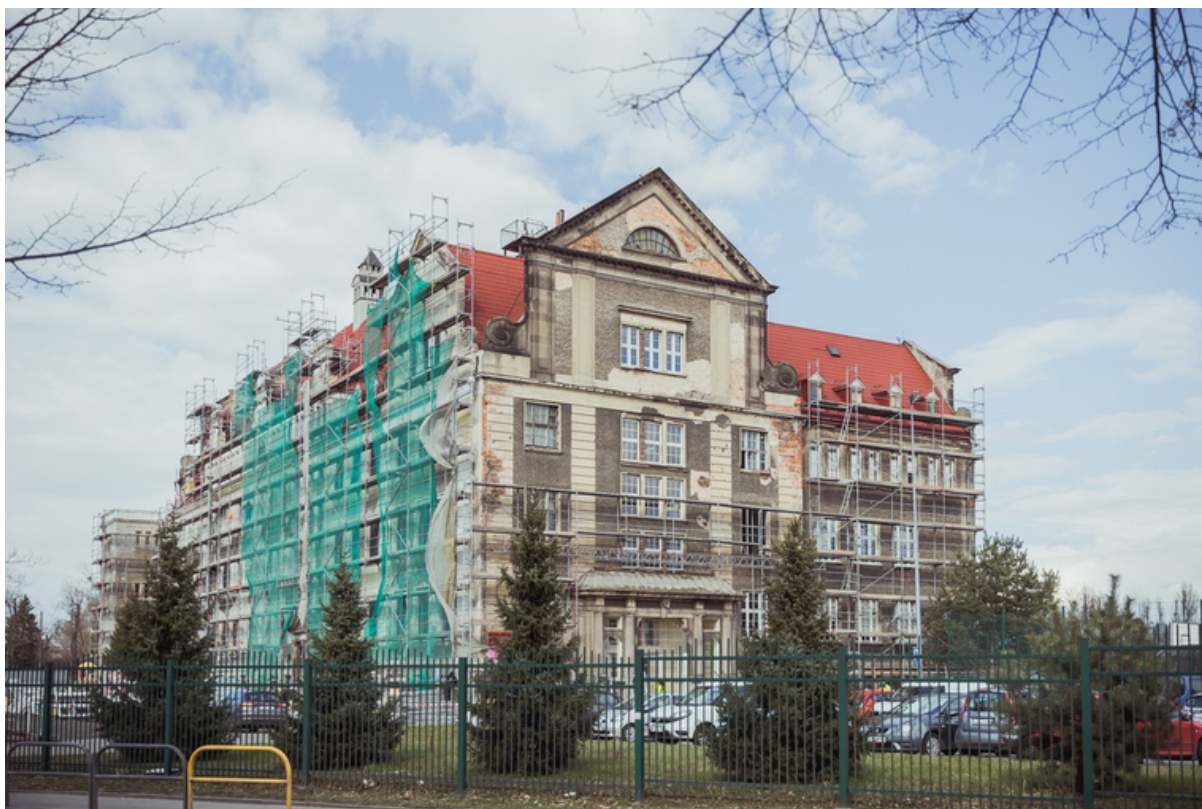
ryc. 4. Prace remontowe budynku ZSO nr 6 przy ul. Głębokiej. Fot. D. Paszliński / gdansk.pl
