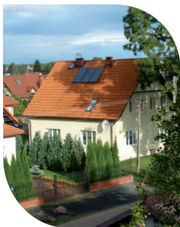
panele słoneczne na budynku mieszkalnym
