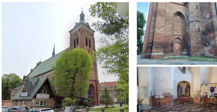
Parafia Greckokatolicka (bizantyjsko-ukraińska) pw. Św. Bartłomieja i Opieki NMP – kościół pw. Św. Bartłomieja Wykonanie izolacji przeciwwilgociowej poziomej murów (etap III) (wieża)
