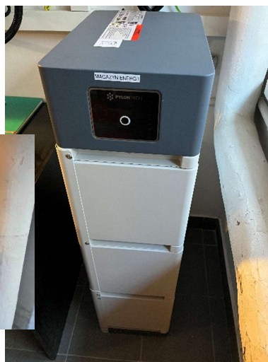
Magazyn energii 10,65 kWh
