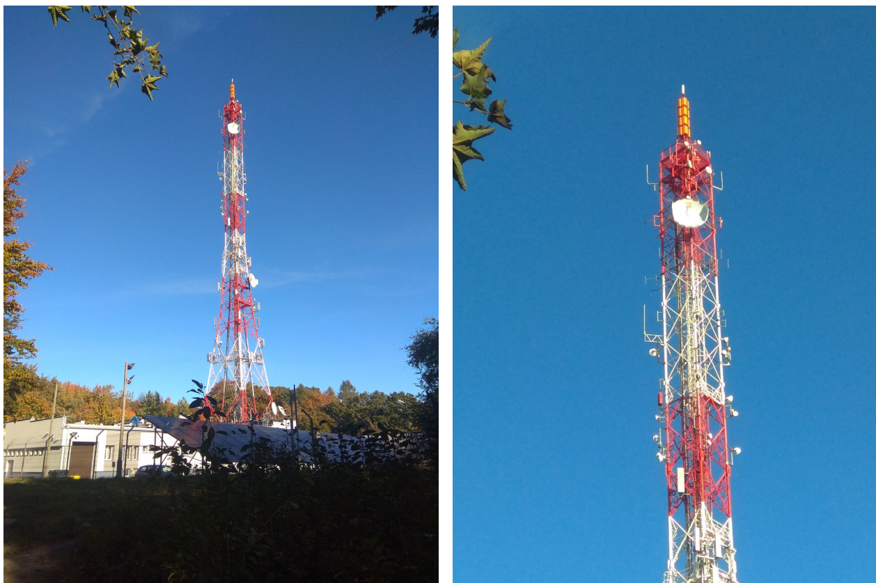
Widok obiektu wraz z zainstalowanym zespołem antenowym
