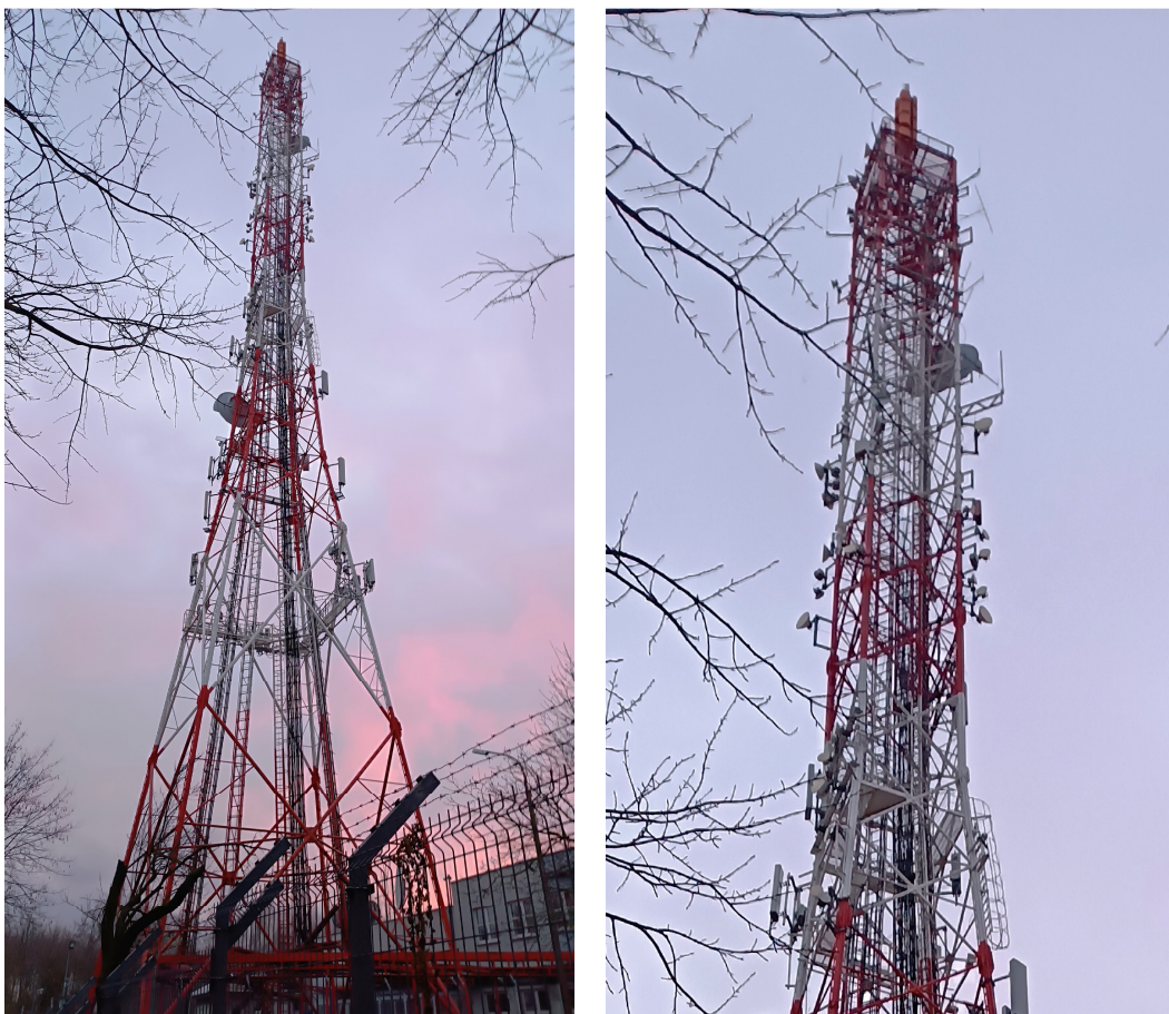
Widok obiektu wraz z zainstalowanym zespołem antenowym
