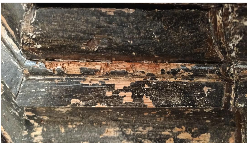
Ilustracja stanu zachowania drewna. Elementy zniszczone przez kołatki.
