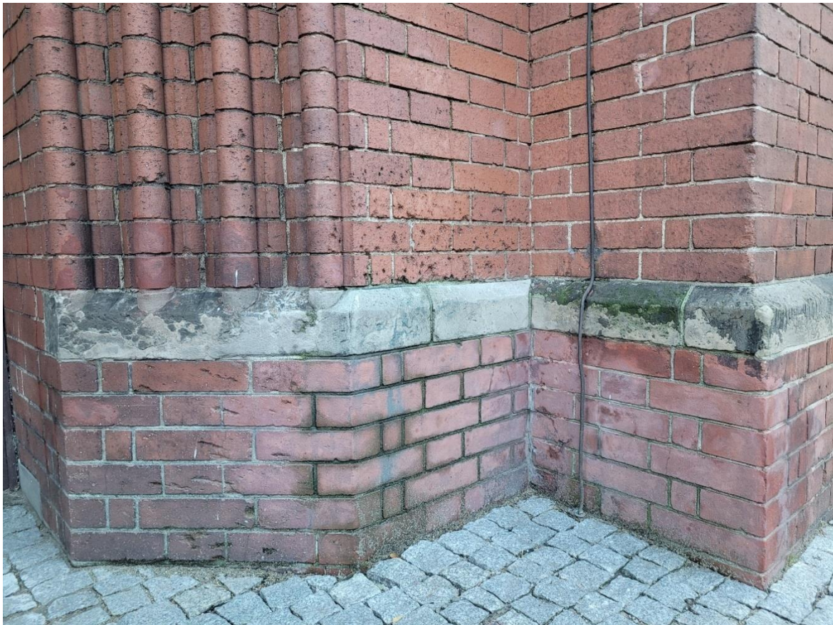
Ilustracja 12. Zachodni mur wieży kościoła. Skutki zawilgocenia
