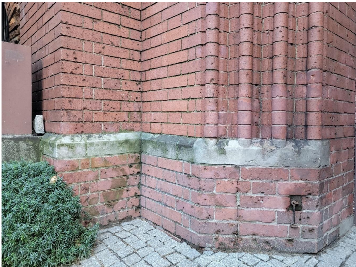
Ilustracja 13. Zachodni mur wieży kościoła. Skutki zawilgocenia
