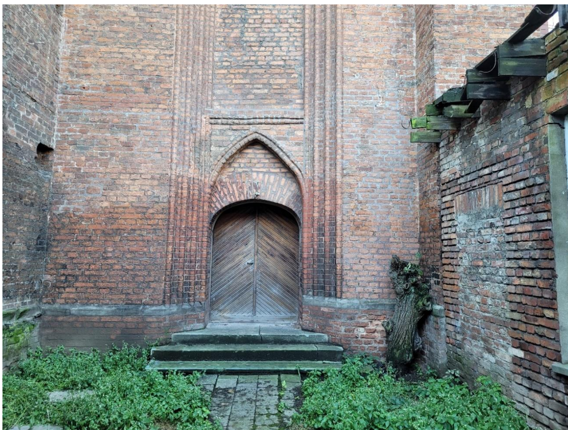
Ilustracja 14. Plamy wilgoci na murach wieży kościoła. Widok od północy
