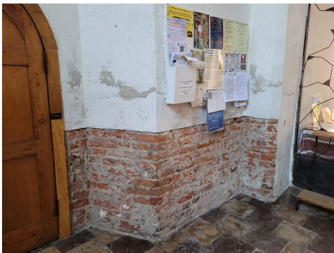
Ilustracja 18. Skutki zawilgocenia na ścianach: plamy wilgoci i odpajający się tynk.
