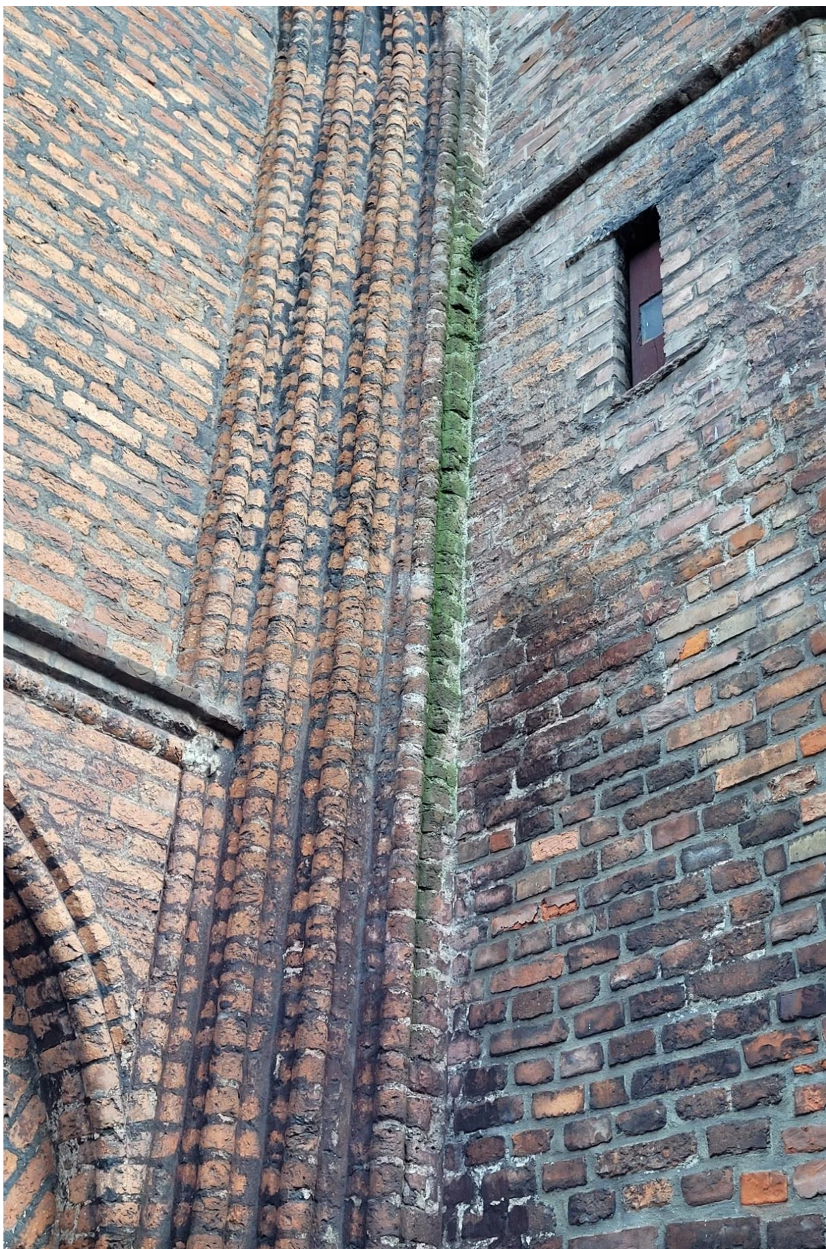
Ilustracja 16. Południowy mur wieży kościoła. Skutki zawilgocenia
