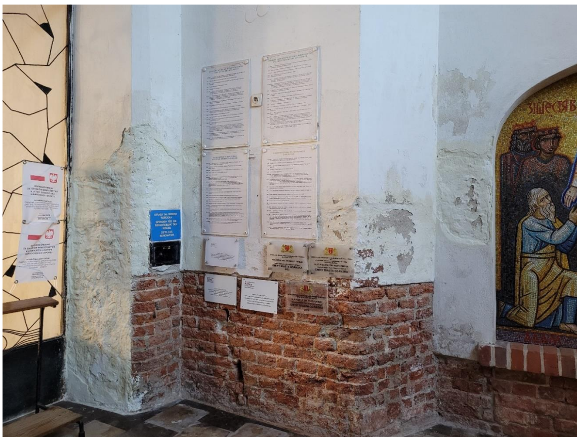
Ilustracja 17. Skutki zawilgocenia na ścianach: plamy wilgoci i odpajający się tynk
