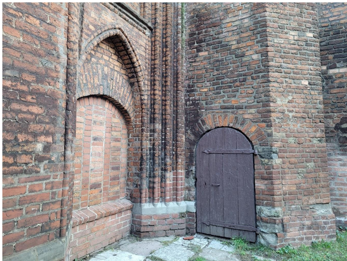
Ilustracja 11. Zniszczenia spowodowane zawilgoceniem muru
