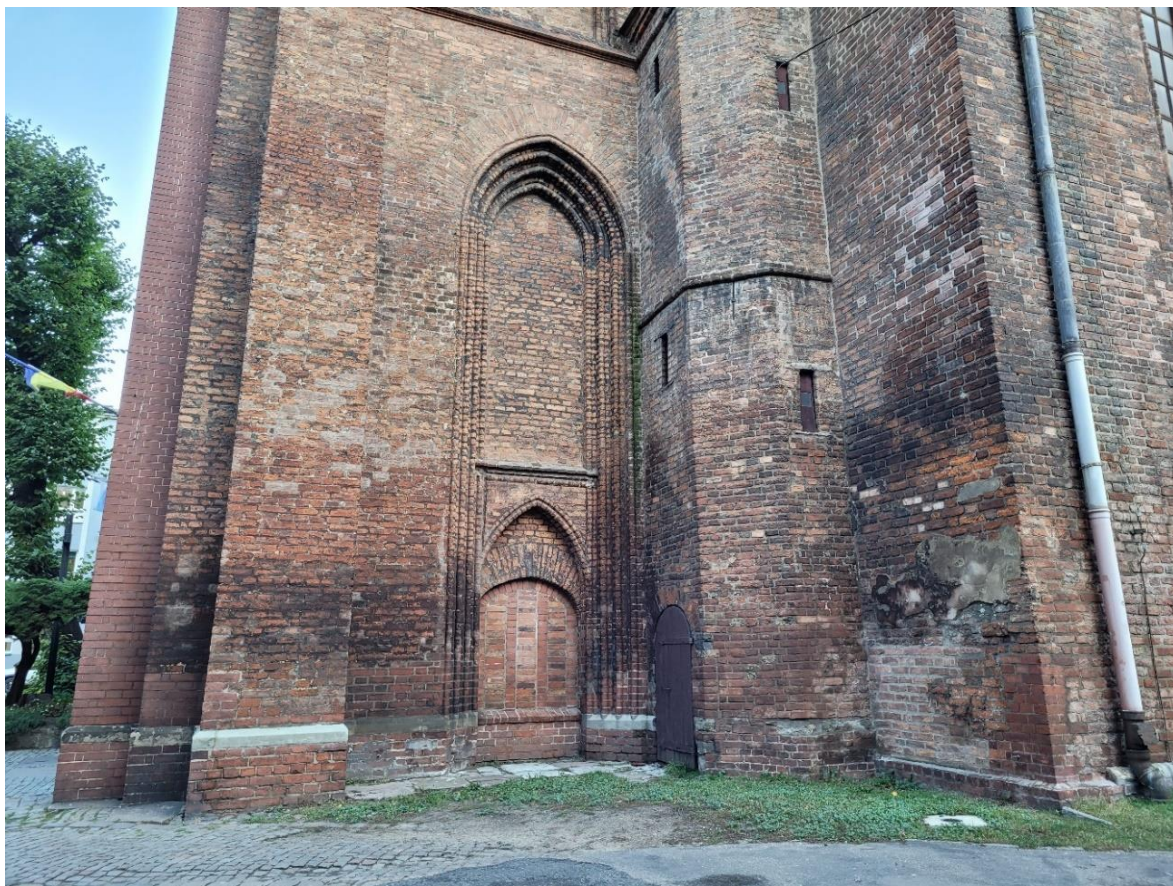
Ilustracja 10. Plamy wilgoci na murach wieży kościoła
