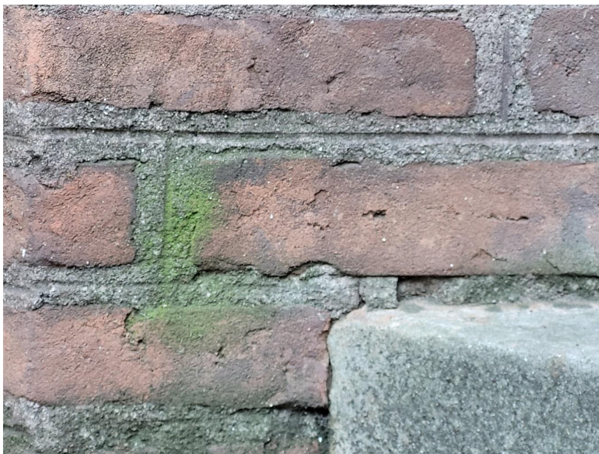
Ilustracja 15. Północny mur wieży kościoła. Skutki zawilgocenia
