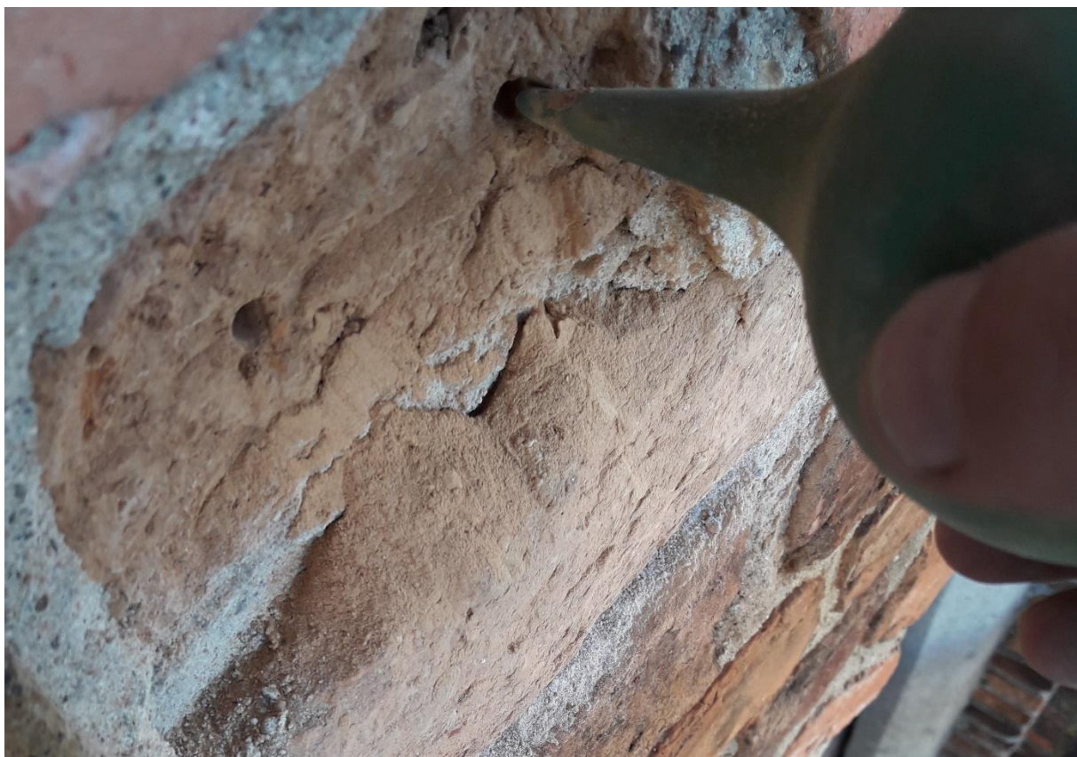
Ilustracja 32. Wzmocnienie strukturalne cegieł
