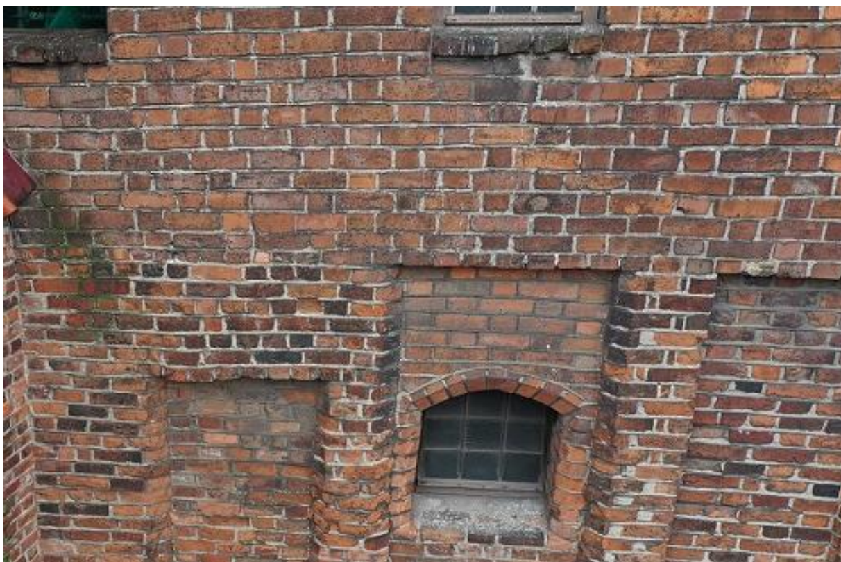
Ilustracja 14. Porosty, uszkodzenia i ubytki cegieł
