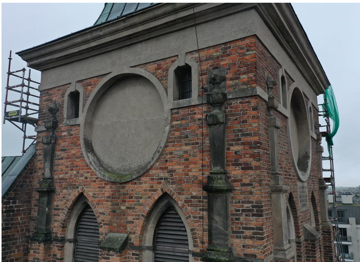
Ilustracja 18. Porosty, zabrudzone cegły i elementy kamienne
