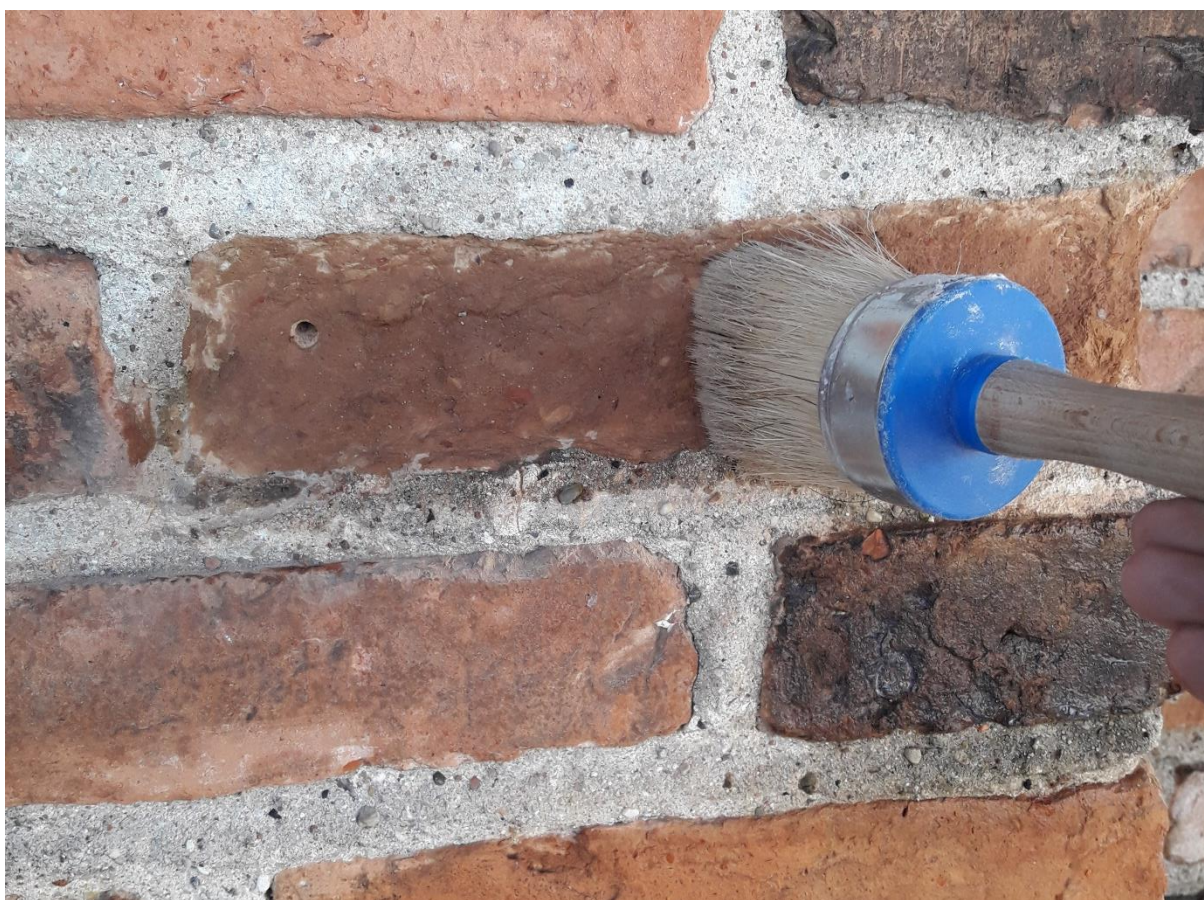
Ilustracja 33. Wzmocnienie strukturalne cegieł
