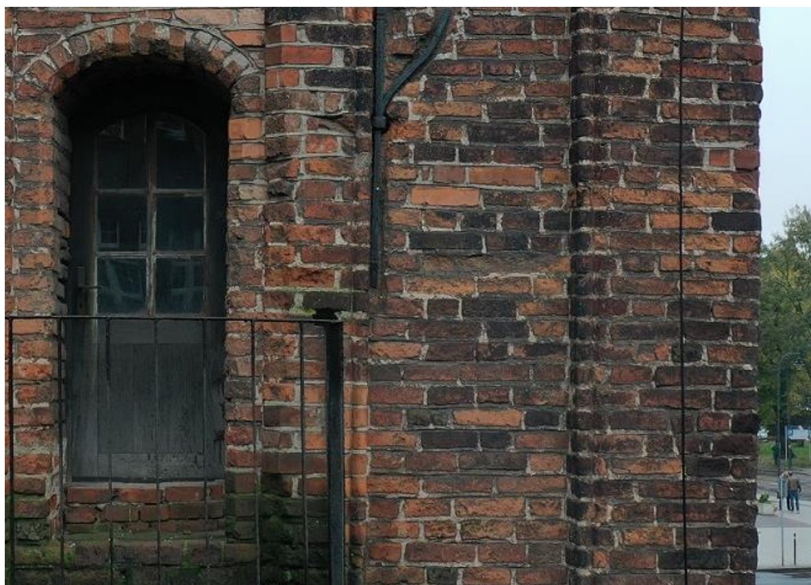
Ilustracja 19. Porosty, uszkodzenia cegieł i zapraw
