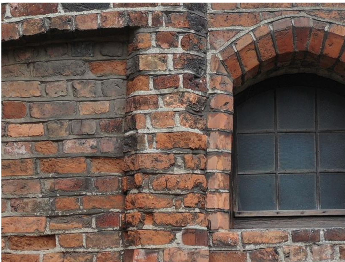
Ilustracja 13. Uszkodzenia i ubytki cegieł
