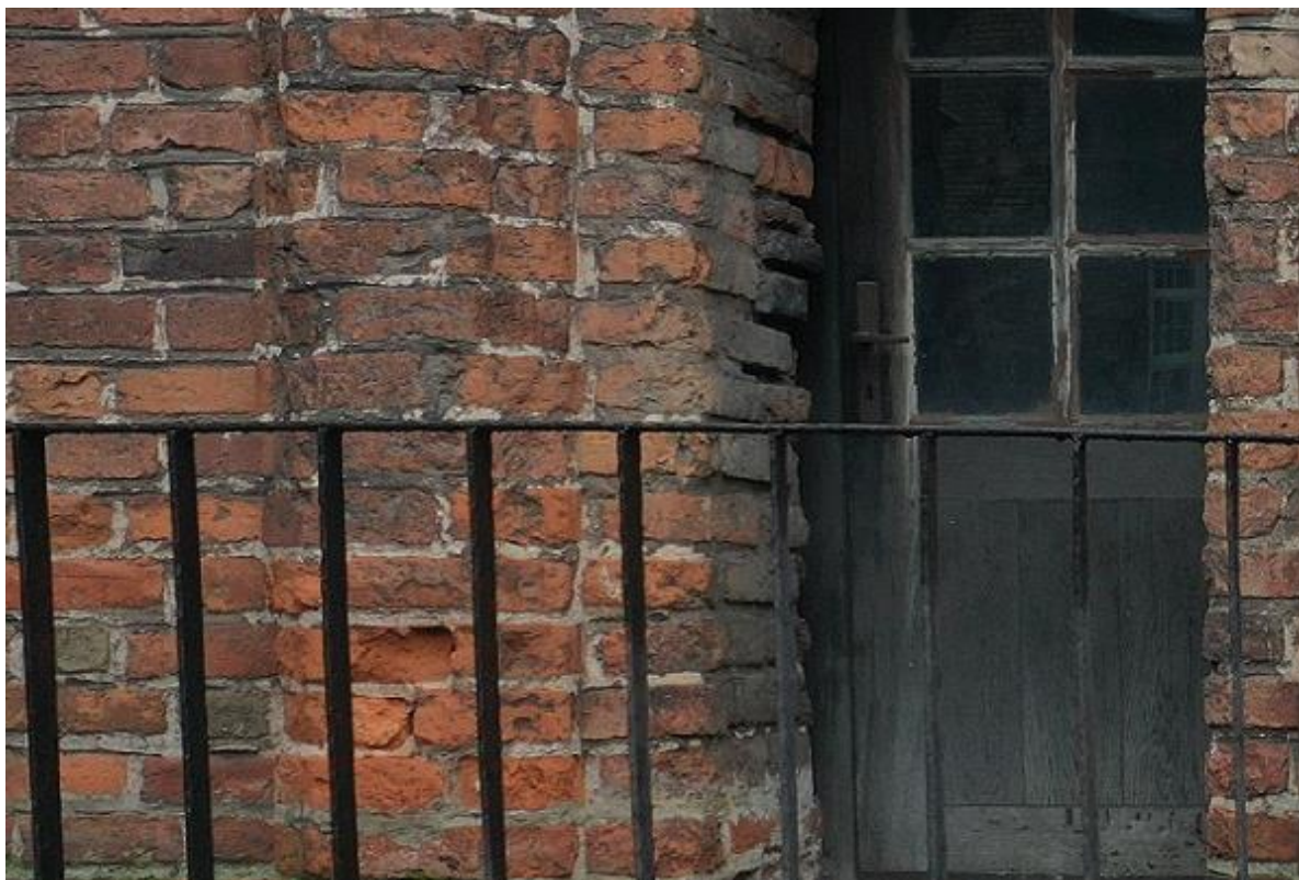
Ilustracja 20. Ubytki cegieł i zapraw
