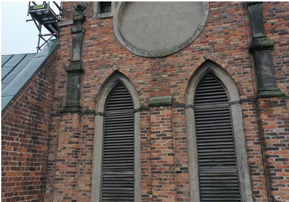
Ilustracja 17. Porosty, zabrudzone cegły i elementy kamienne
