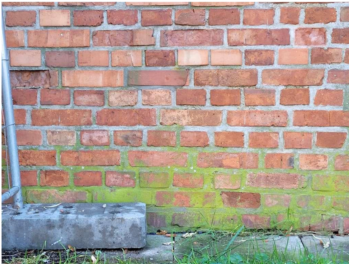
Ilustracja 15. Stan elewacji w strefie przyziemia przed podjęciem prac konserwatorskich
