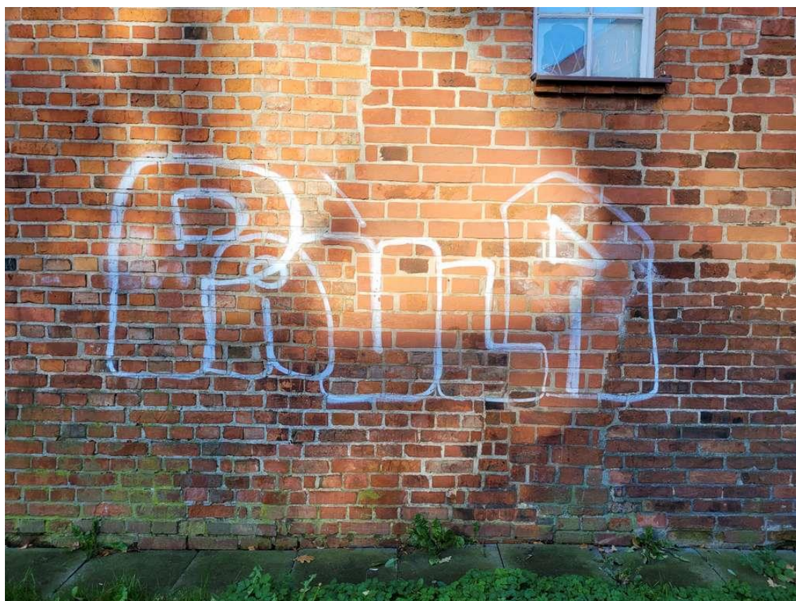
Ilustracja 10. Stan elewacji przed podjęciem prac konserwatorskich
