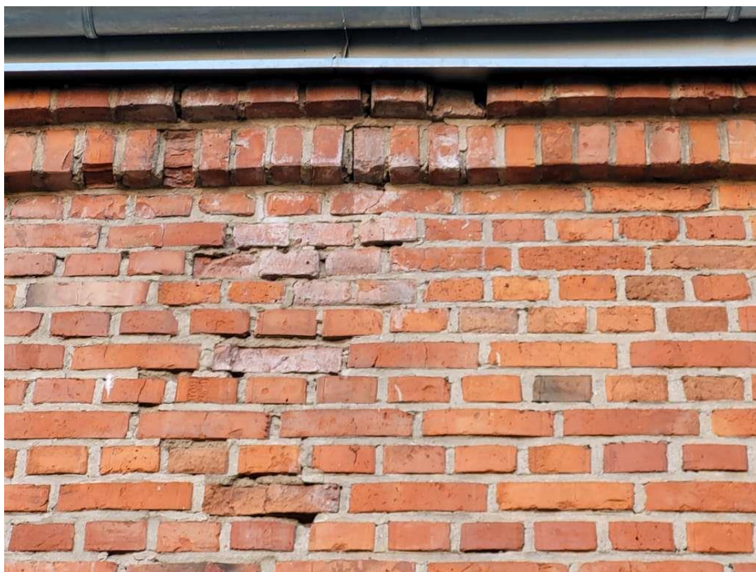
Ilustracja 14. Stan elewacji przed podjęciem prac konserwatorskich
