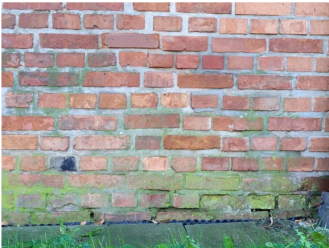
Ilustracja 16. Stan elewacji w strefie przyziemia przed podjęciem prac konserwatorskich
