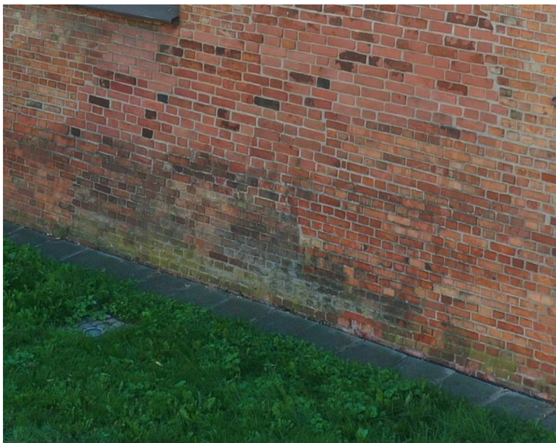
Ilustracja 18. Stan elewacji w strefie przyziemia przed podjęciem prac konserwatorskich
