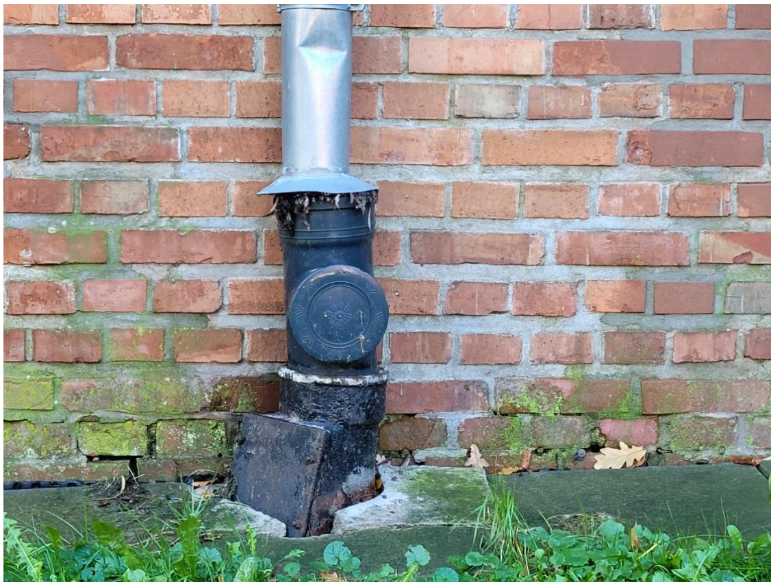
Ilustracja 17. Stan elewacji w strefie przyziemia przed podjęciem prac konserwatorskich
