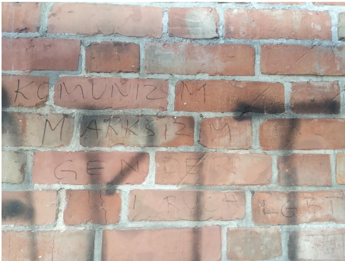
Ilustracja 11. Stan elewacji przed podjęciem prac konserwatorskich
