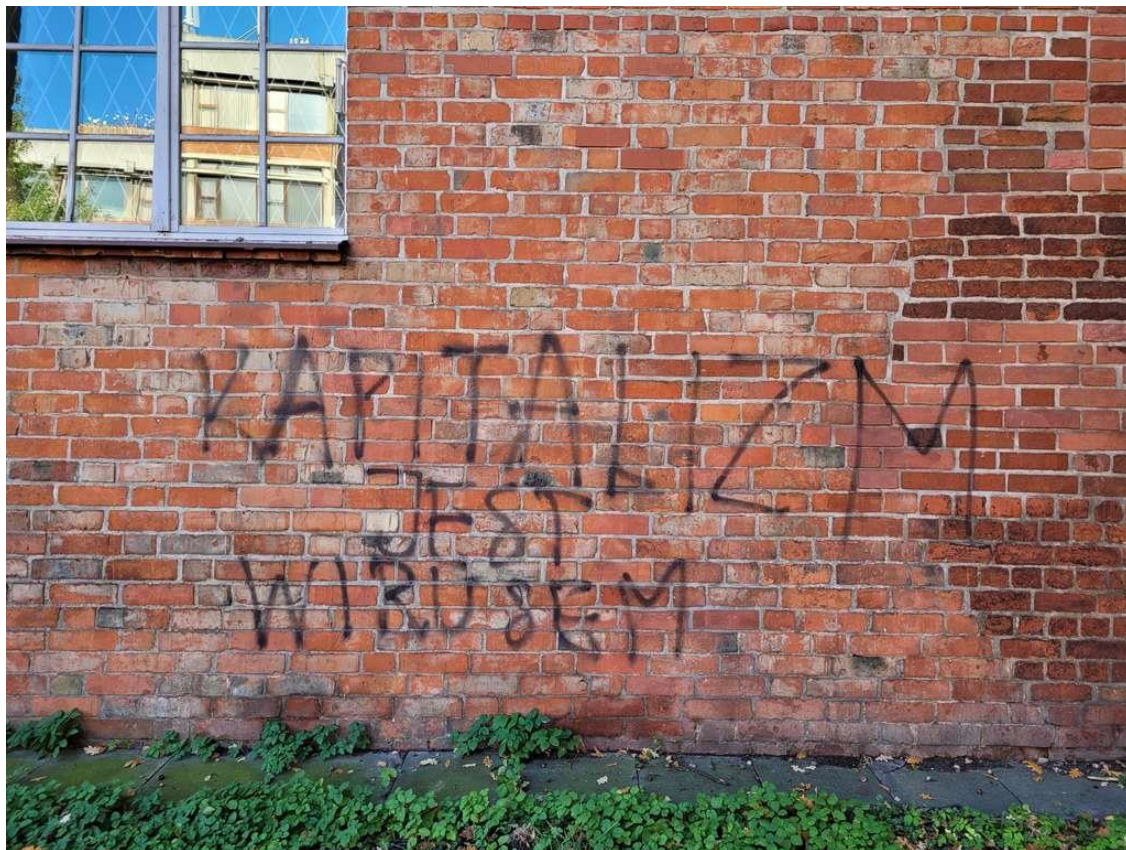
Ilustracja 9. Stan elewacji przed podjęciem prac konserwatorskich
