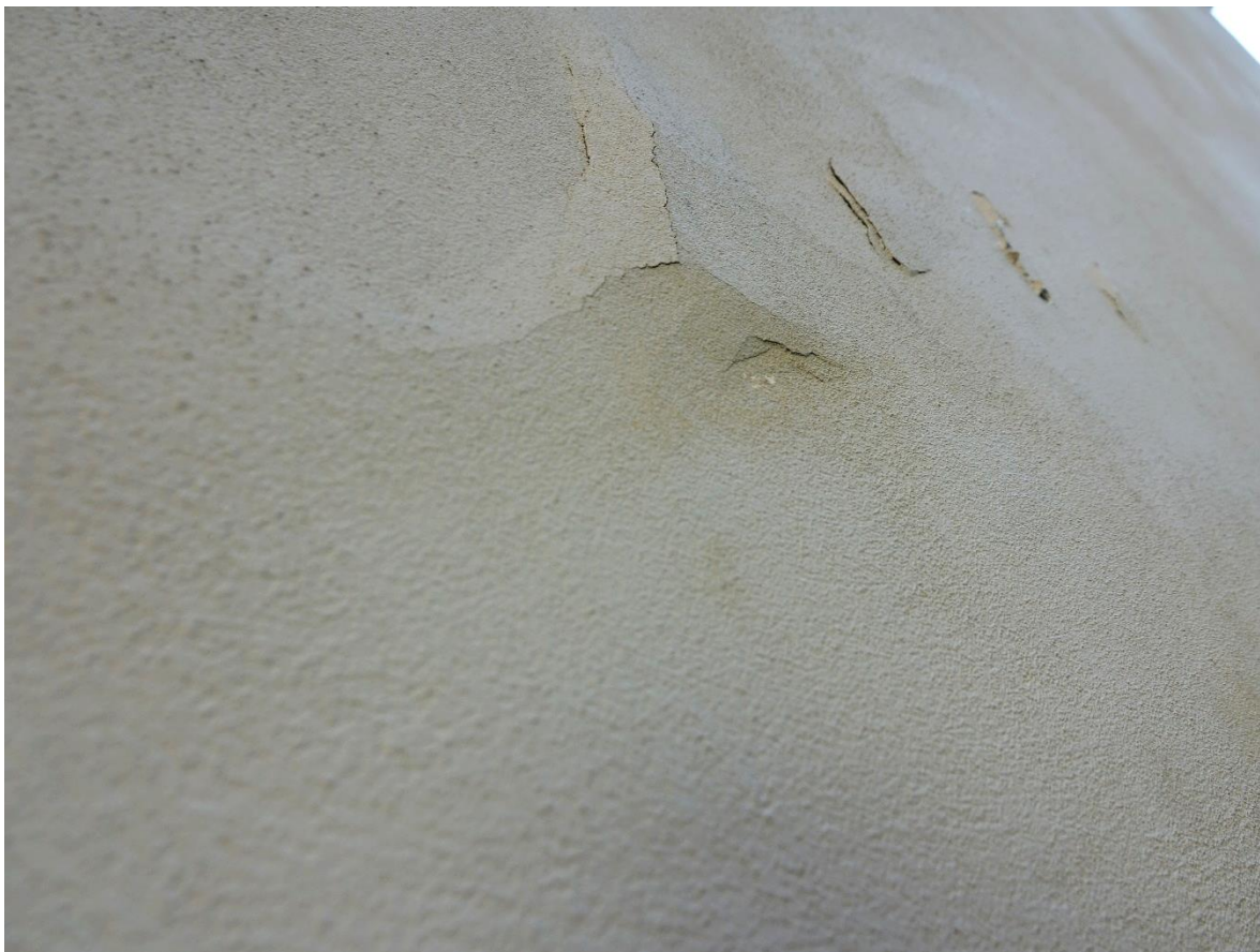
Ilustracja 13. Skutki zawilgocenia wewnątrz zabytku
