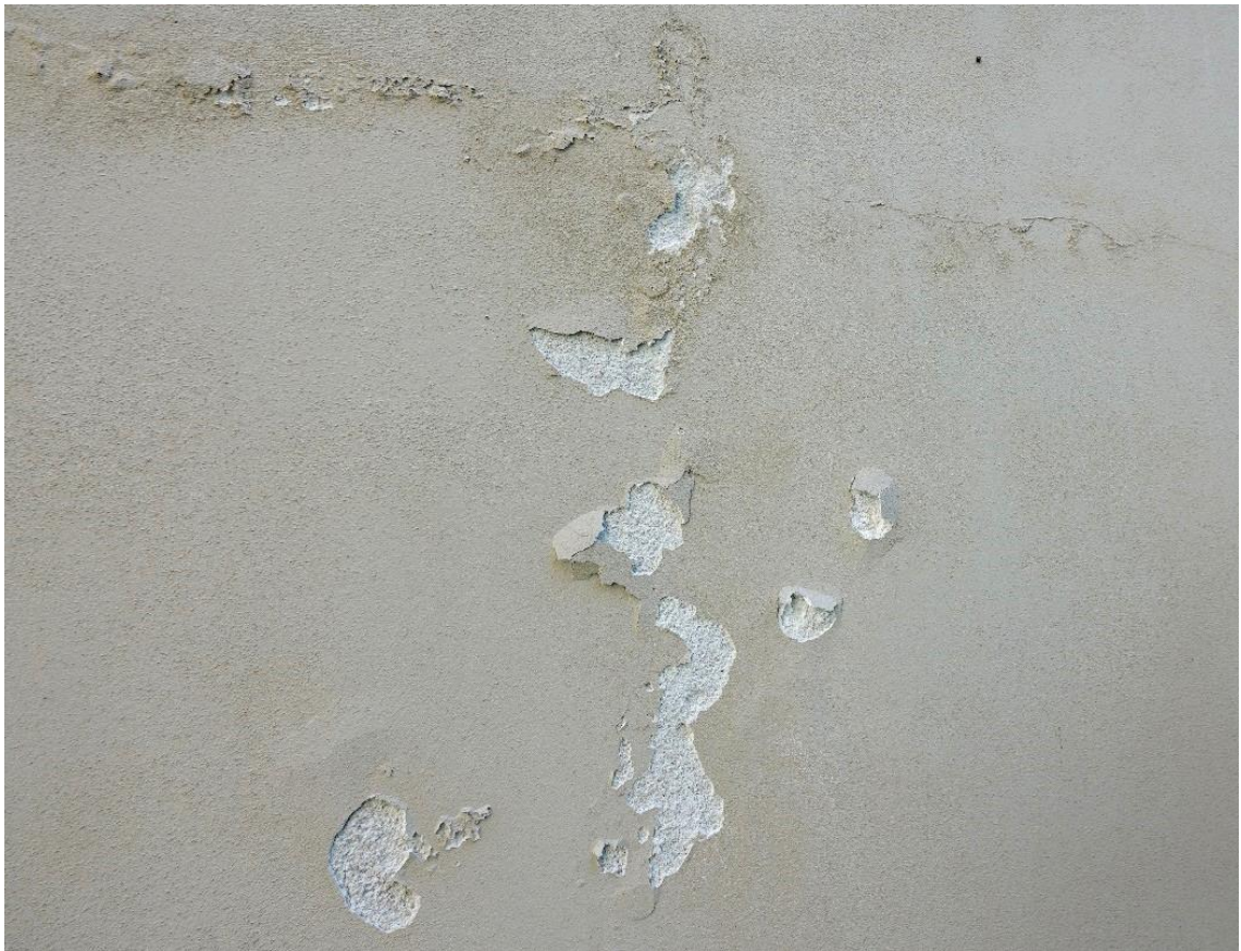
Ilustracja 9. Skutki zawilgocenia murów w postaci odspajającego się tynku
