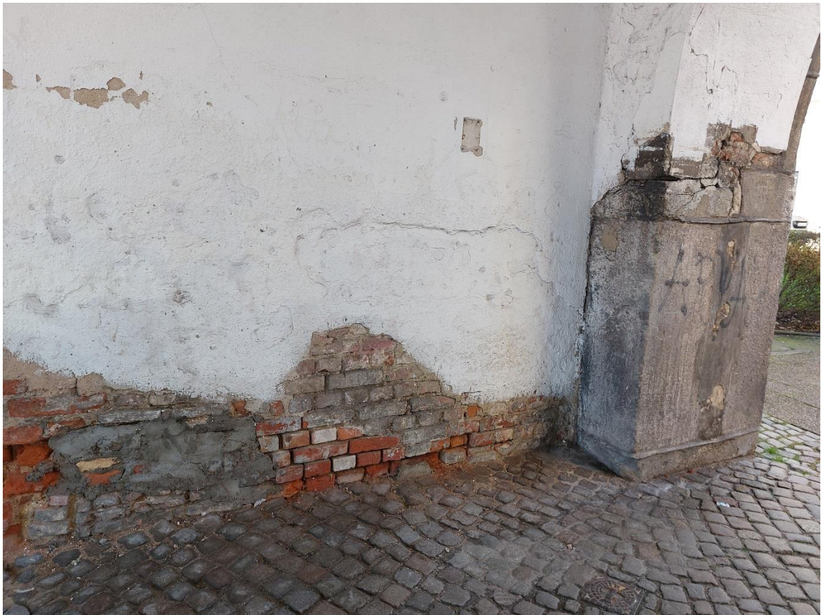
Ilustracja 18. Skutki zawilgocenia. Tynk odspajający się od ścian w przyziemiu przejazdu bramnego
