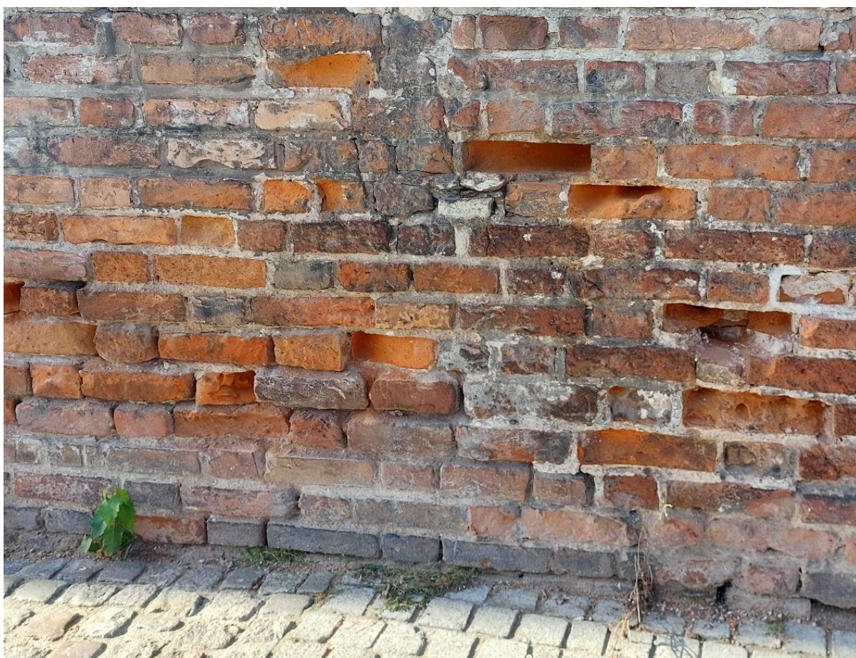
Ilustracja 15. Skutki zawilgocenia w postaci zniszczenia elewacji ceglanej
