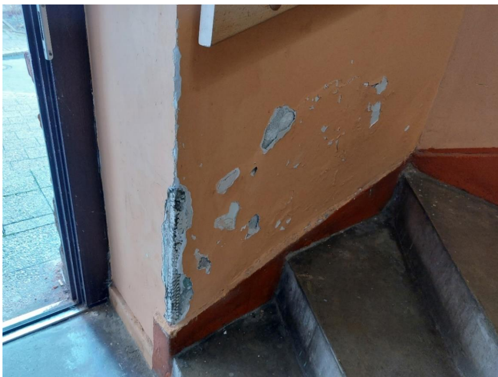
Ilustracja 20. Skutki zawilgocenia wewnątrz zabytku. Tynk odspajający się od ścian
