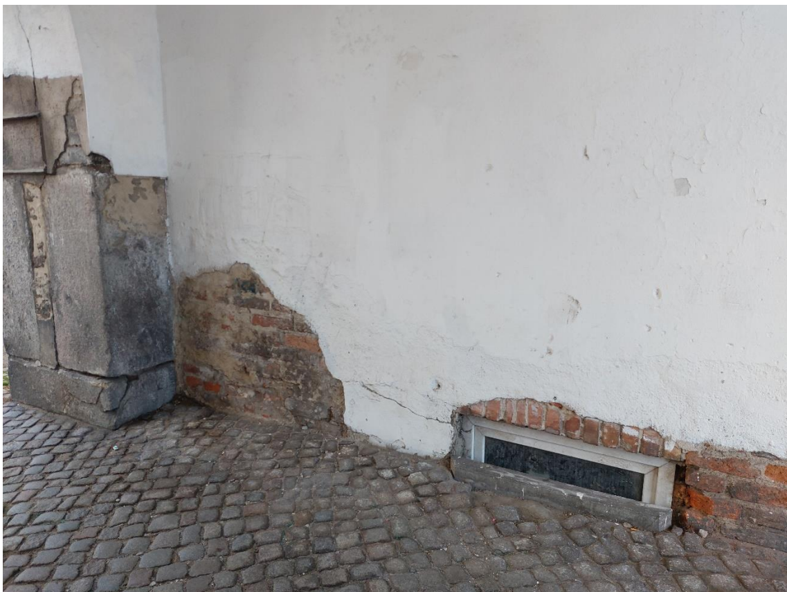
Ilustracja 19. Skutki zawilgocenia. Tynk odspajający się od ścian w przyziemiu przejazdu bramnego
