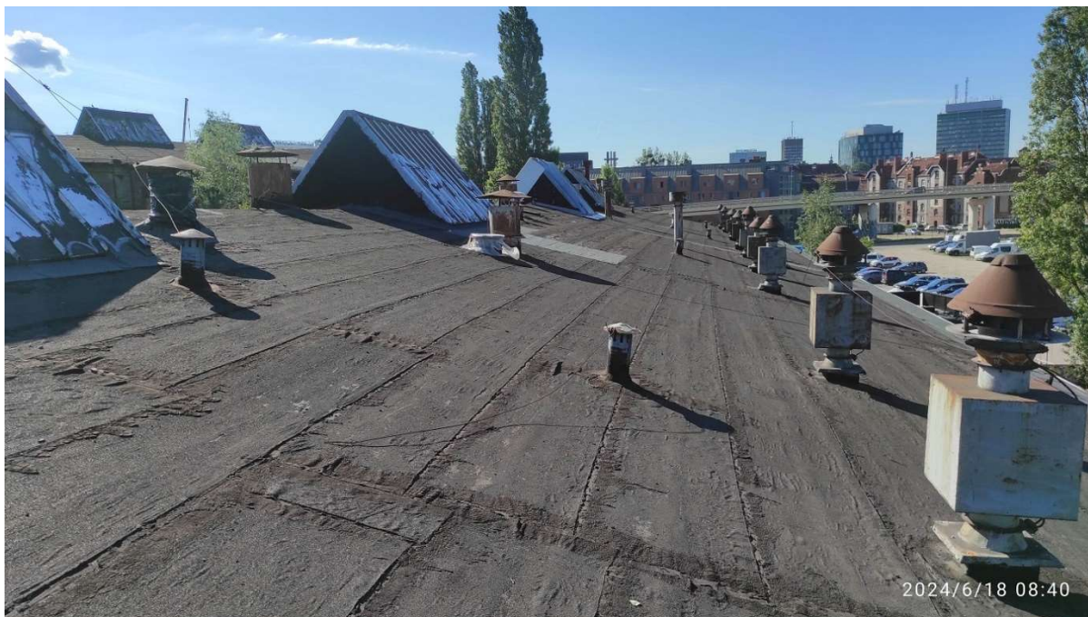
Fot. 34 Dach – część północna – budynku dawnych garaży elektrowozów/magazyn (86B), stan przed pracami, fot. 2024r.
