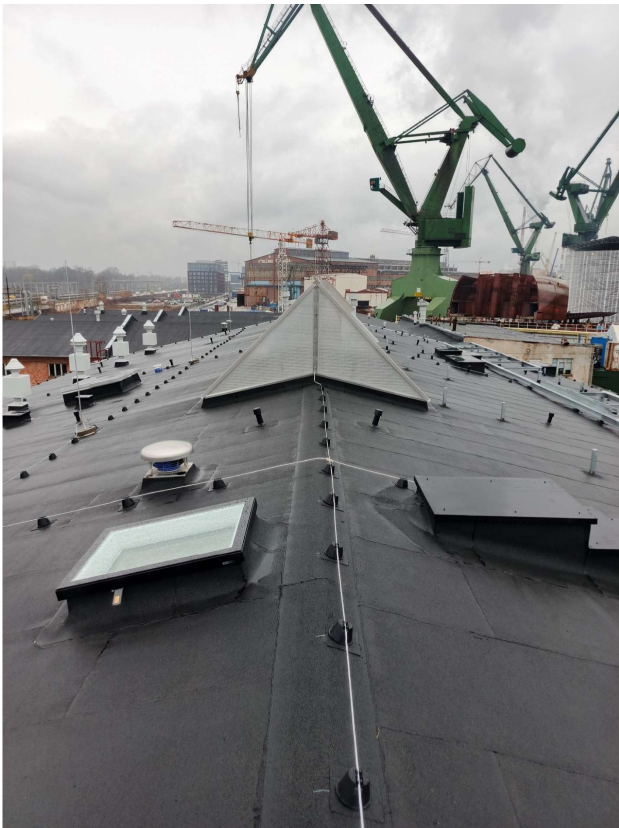
Fot. 57 Dach – część północna – budynku dawnych garaży elektrowozów/magazyn (86B), stan przed pracami, fot. 2024r.
