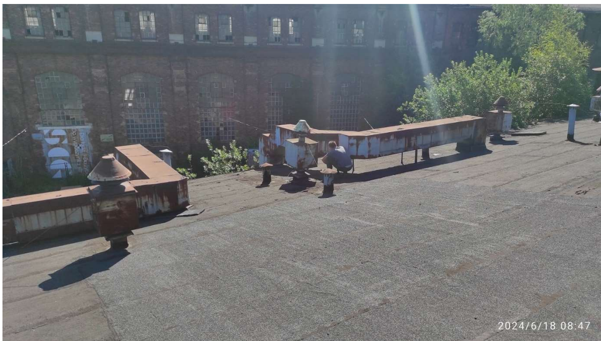
Fot. 43 Dach – część północna – budynku dawnych garaży elektrowozów/magazyn (86B), stan przed pracami, fot. 2024r.
