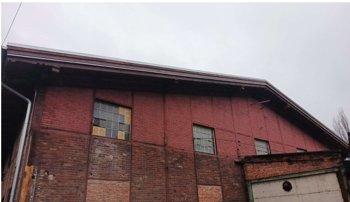
Fot. 59 Dach – część północna – budynku dawnych garaży elektrowozów/magazyn (86B), stan przed pracami, fot. 2024r.
