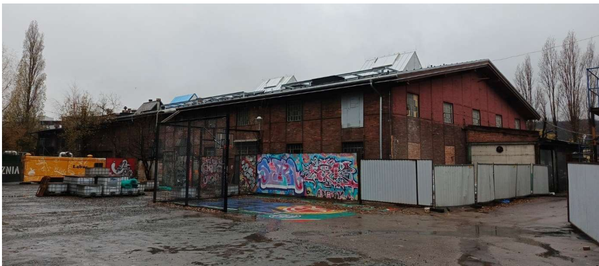
Fot. 58 Dach – część północna – budynku dawnych garaży elektrowozów/magazyn (86B), stan przed pracami, fot. 2024r.
