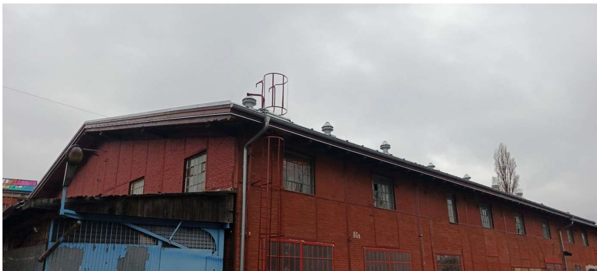
Fot. 60 Dach – część północna – budynku dawnych garaży elektrowozów/magazyn (86B), stan przed pracami, fot. 2024r.
