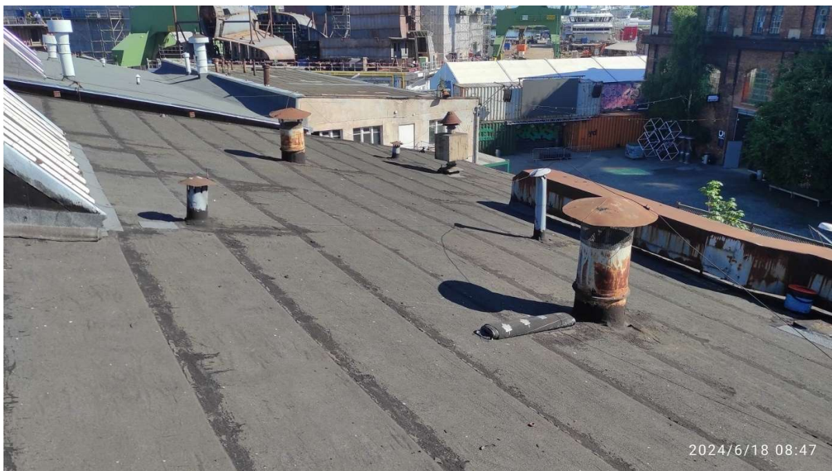
Fot. 41 Dach – część północna – budynku dawnych garaży elektrowozów/magazyn (86B), stan przed pracami, fot. 2024r.
