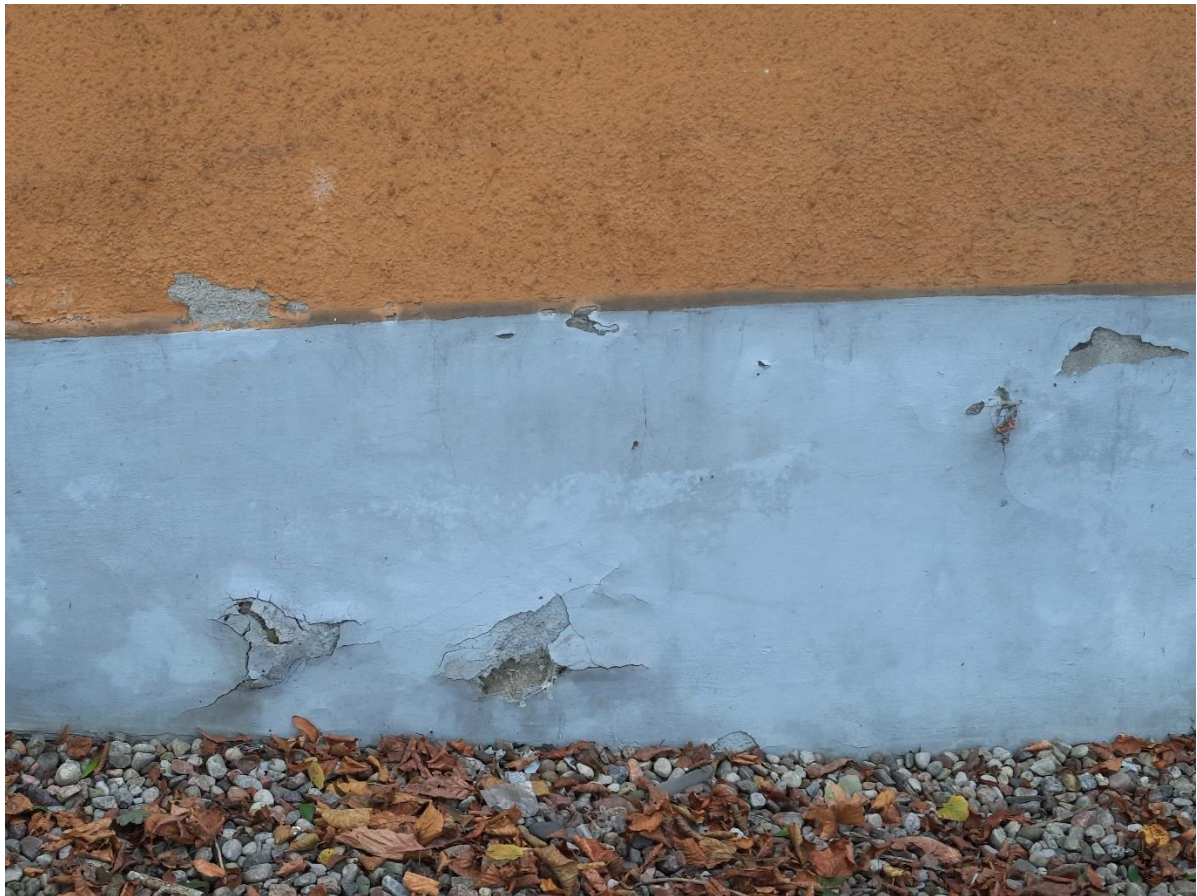
Ilustracja 17. Efekt zawilgocenia murów
