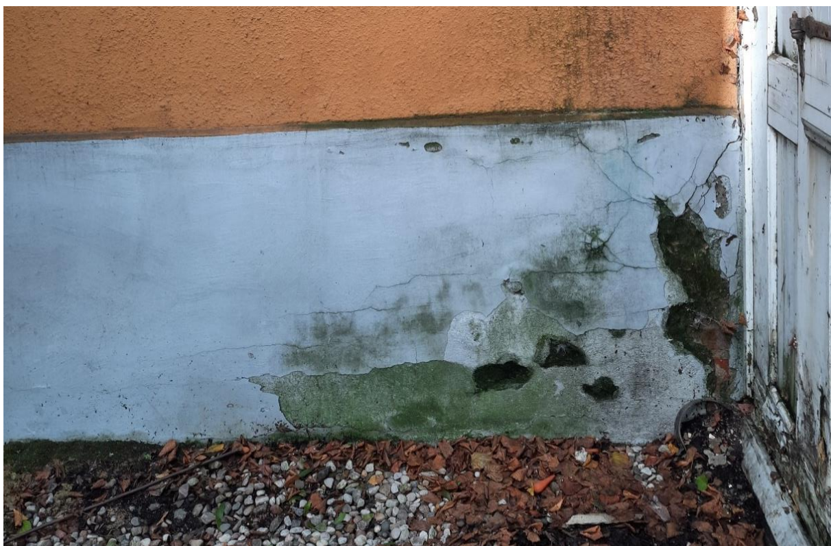
Ilustracja 15. Efekt zawilgocenia murów
