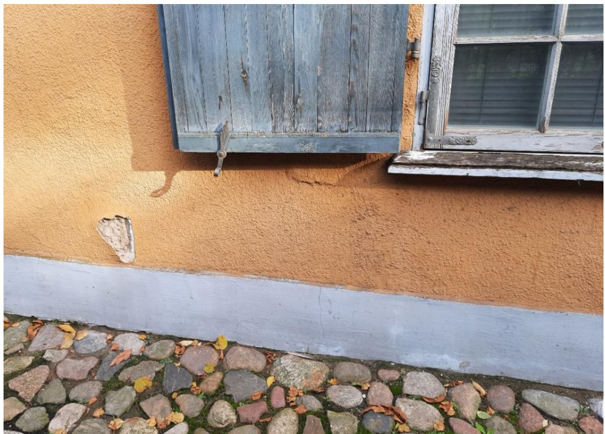
Ilustracja 18. Efekt zawilgocenia murów
