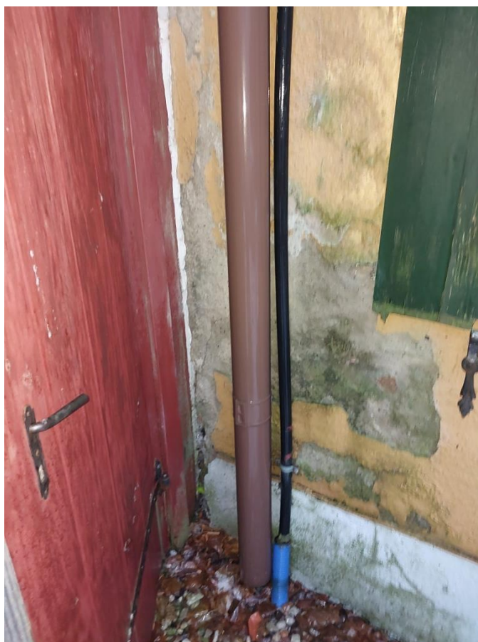
Ilustracja 21. Zacieki i odspajający się tynk
