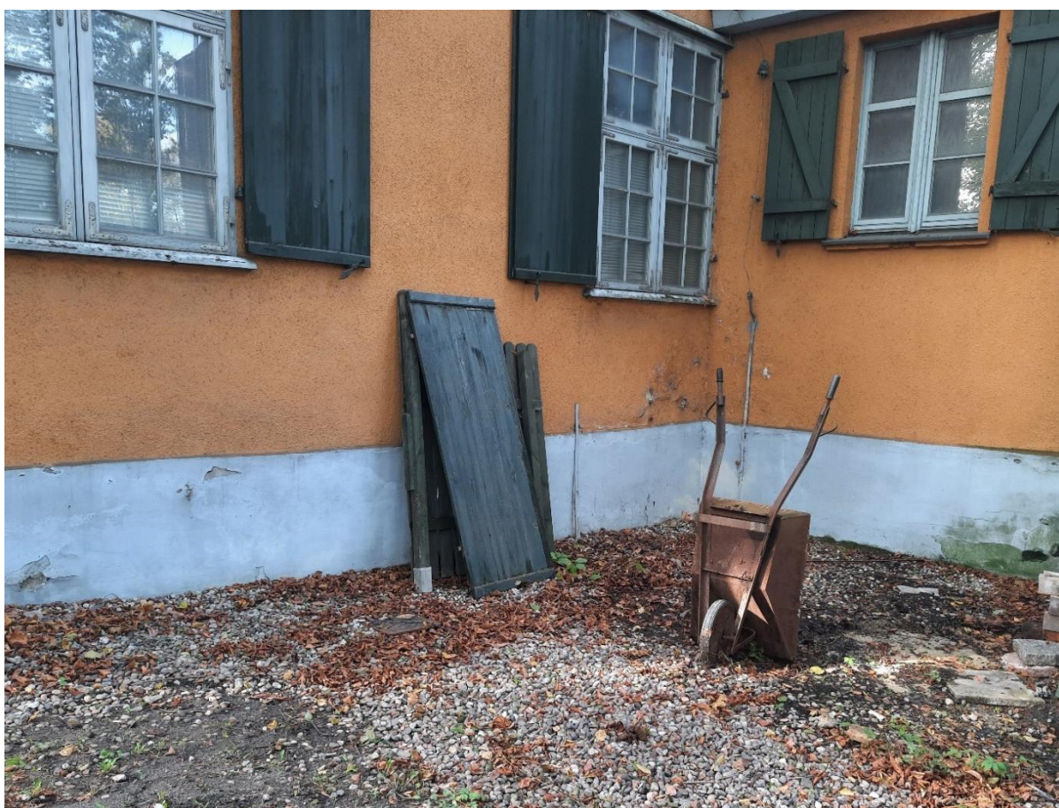
Ilustracja 14. Efekt zawilgocenia murów
