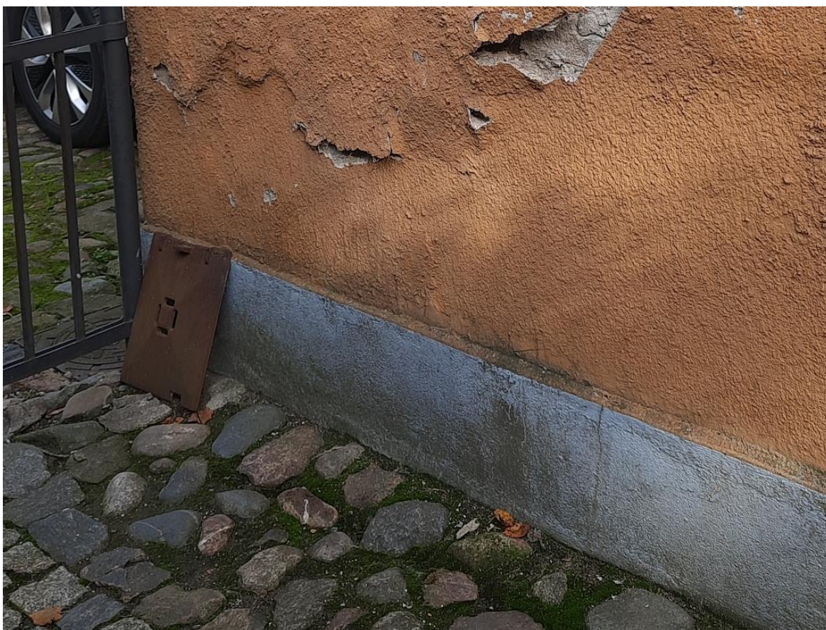
Ilustracja 19. Zacieki i tynki odspajające się od ścian w wyniku zawilgocenia murów
