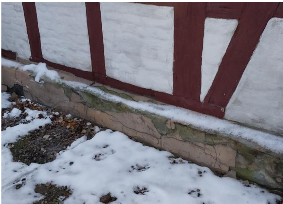
Ilustracja 22. Tynki odspajające się od ścian w wyniku zawilgocenia murów
