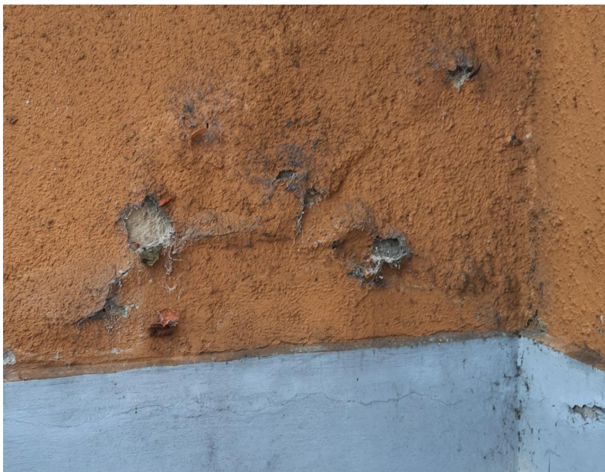
Ilustracja 16. Efekt zawilgocenia murów
