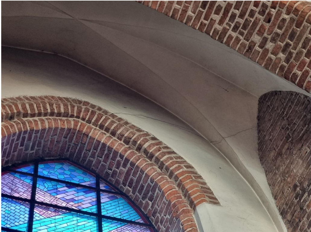
Ilustracja 12. Rysy na ścianie i sklepieniu
