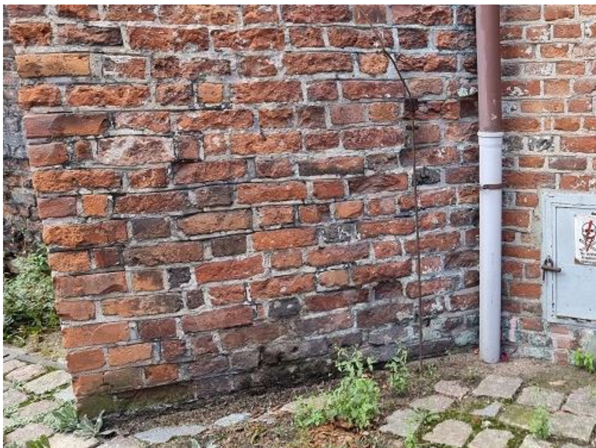
Ilustracja 19. Zawilgocenie strefy przyziemia
