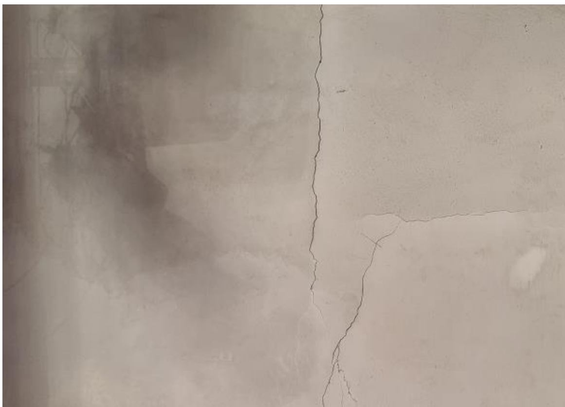
Ilustracja 15. Spękania oraz plamy wilgoci na tynku
