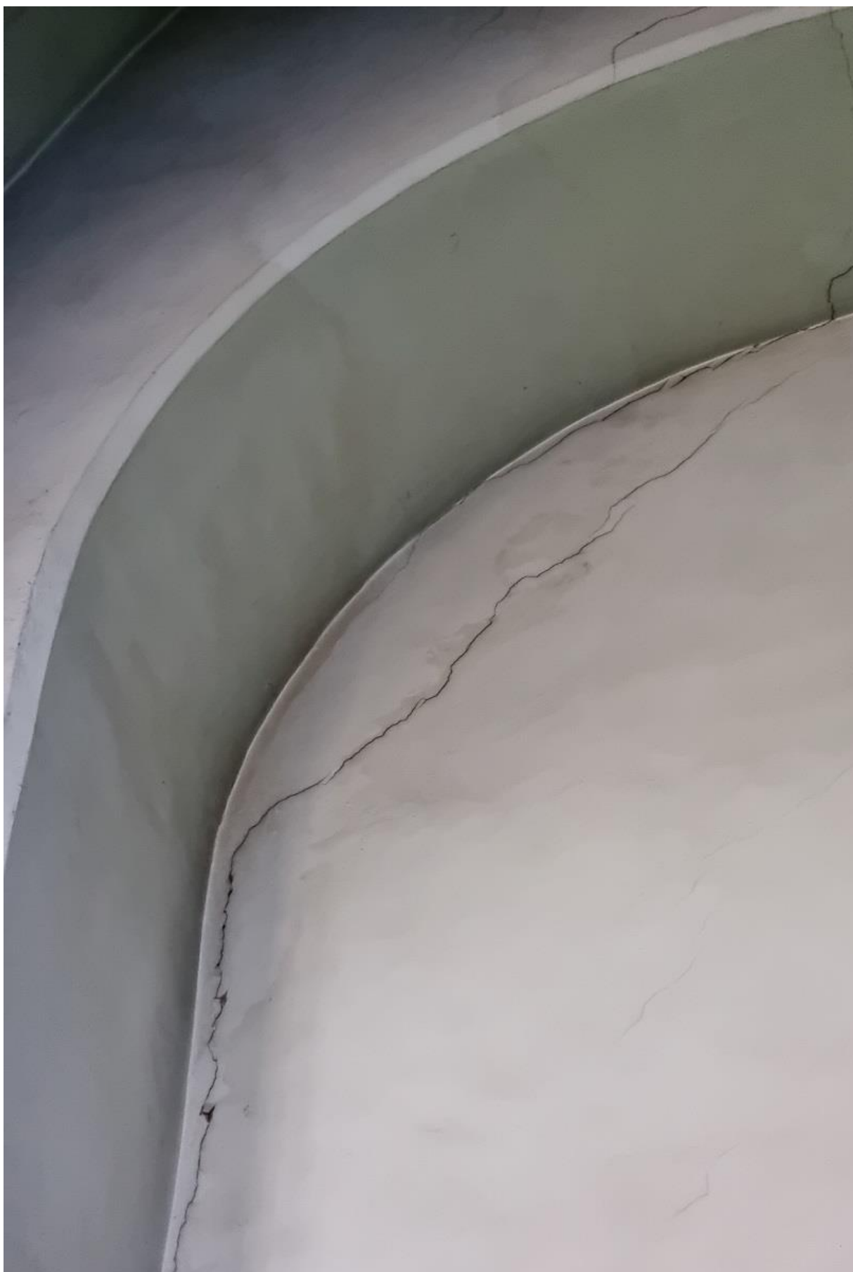
Ilustracja 14. Spękania na ścianie kościoła
