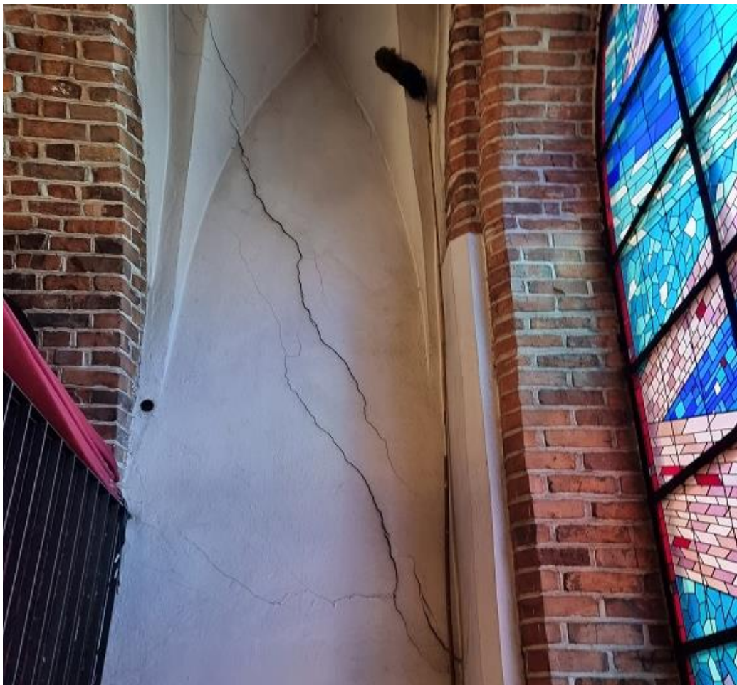
Ilustracja 13. Spękania na ścianie i sklepieniu
