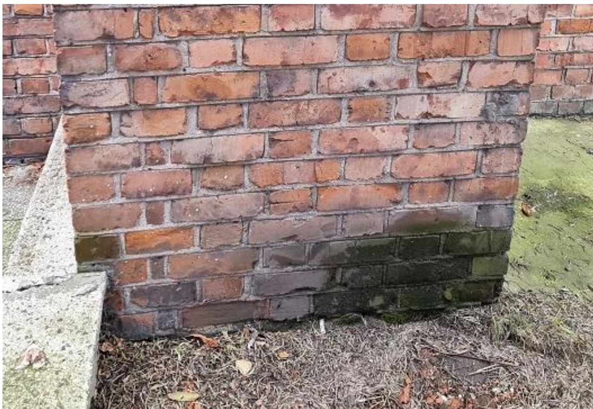
Ilustracja 20. Zawilgocenie strefy przyziemia
