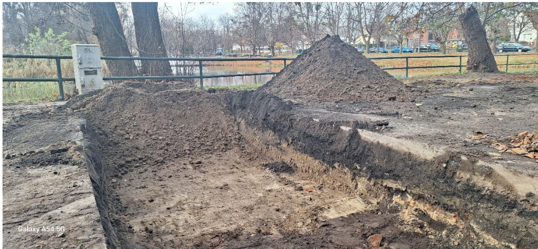
Fot. 4 Brak korzeni w głównym wykopie.
